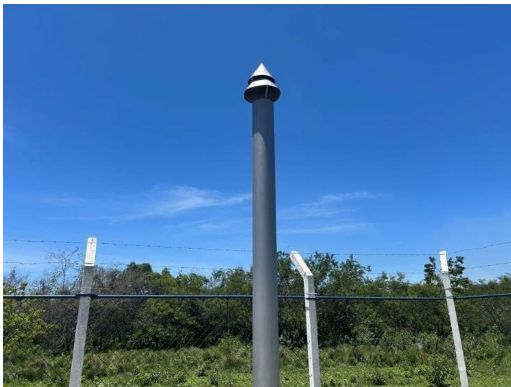
Foto 7: Exaustor da área confinada onde se encontra o duto subterrâneo.
