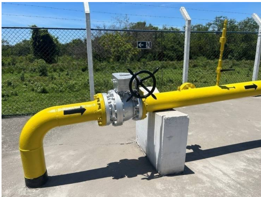
Foto 5: Válvula de linha da derivação para a Gerdau Cosigua.
