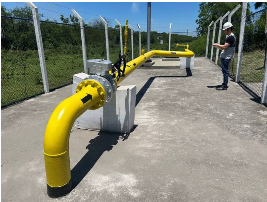
Foto 4: Linha de entrada e válvula da derivação para a Gerdau Cosigua.
