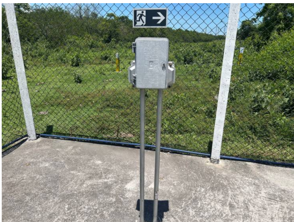
Foto 8: Sistema de proteção catódica da estação.
