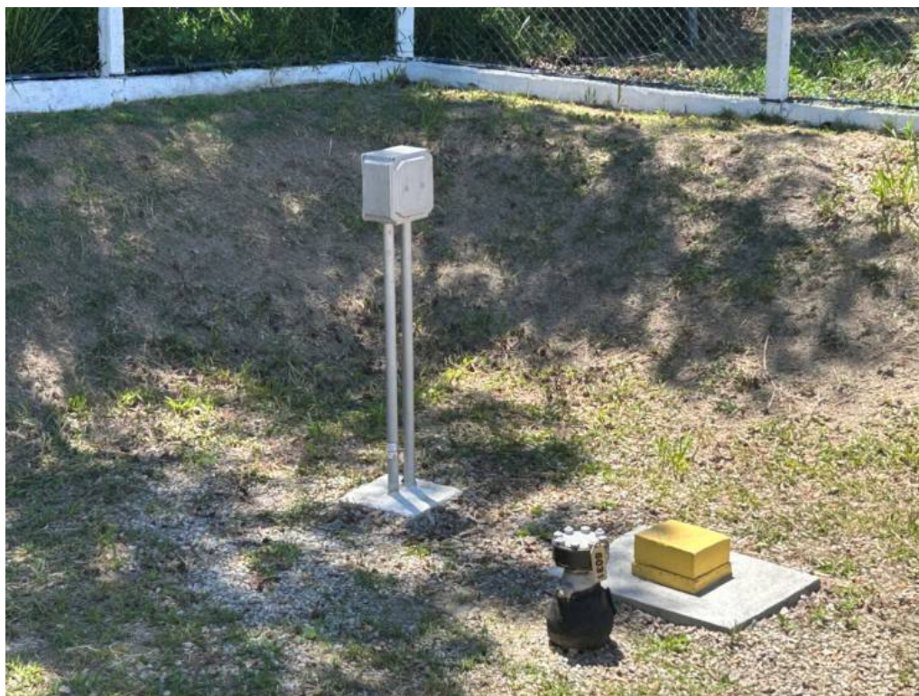
Foto 5: Sistema de proteção catódica.
