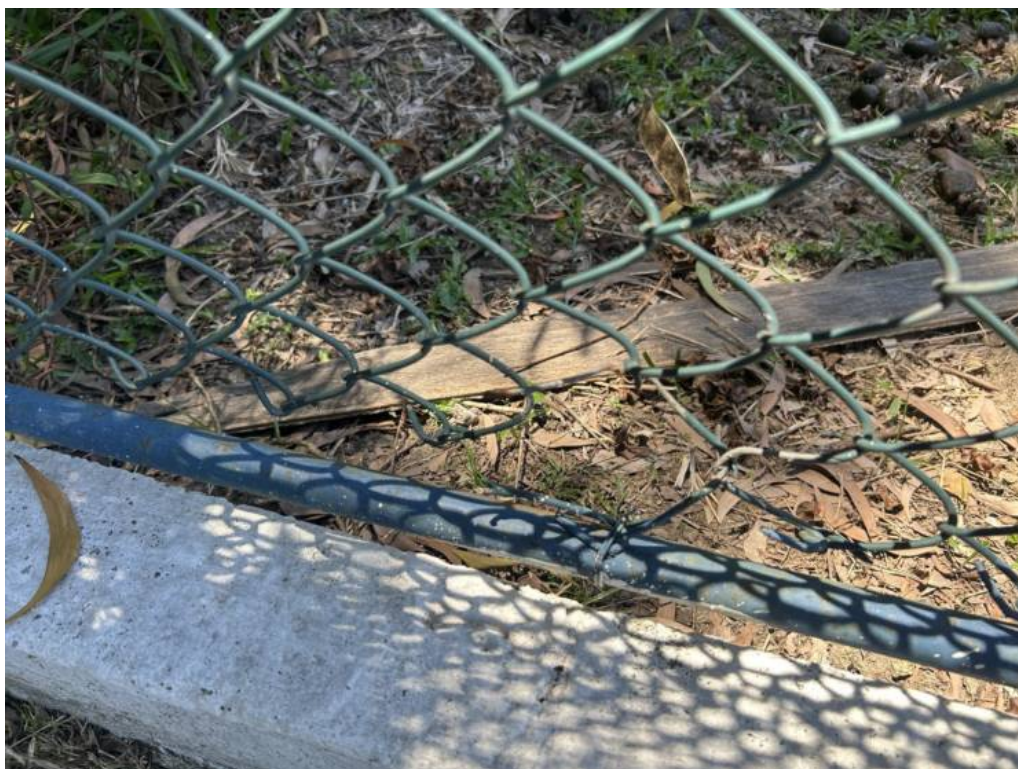
Foto 6: Falha visível na cerca de proteção da estação.
