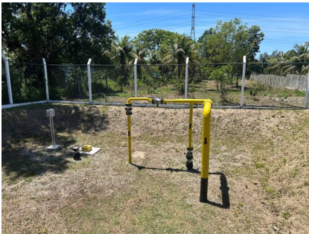
Foto 3: Vista da estação de válvulas.
