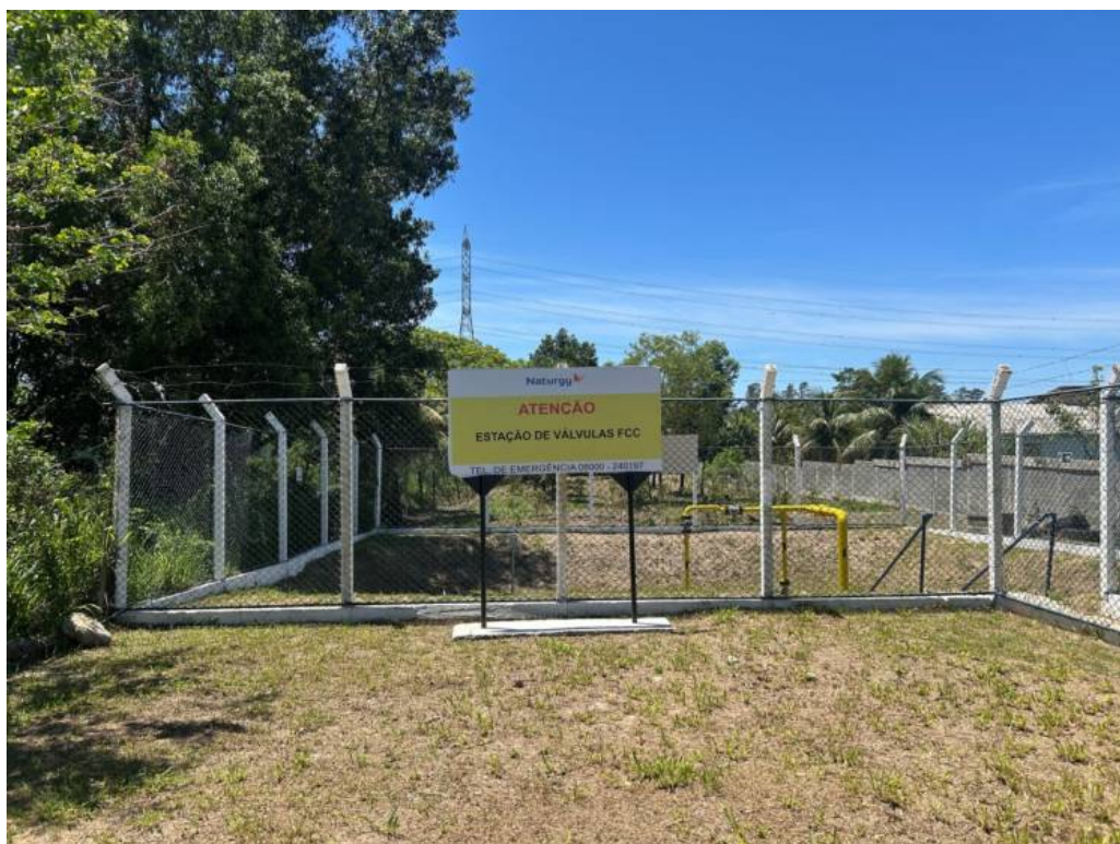
Foto 2: Placa de identificação da Estação de Válvulas FCC.
