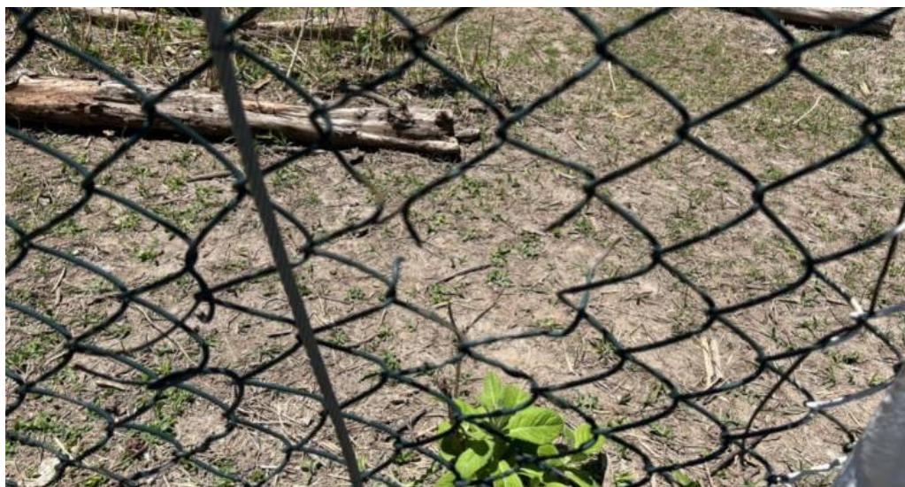
Foto 7: Falha visível na cerca de proteção da estação.
