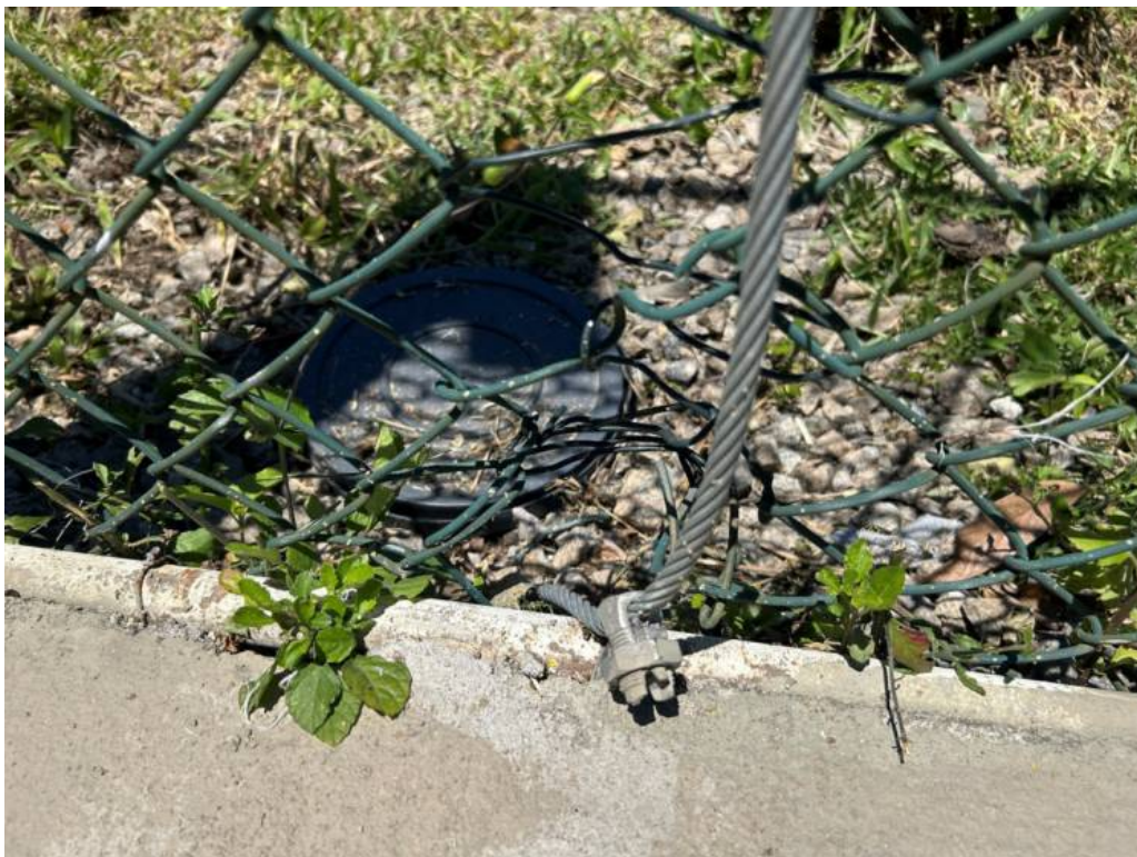
Foto 12: Falha na cerca da estação.
