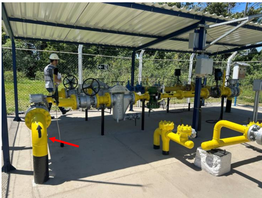
Foto 4: Vista da estação de regulagem e medição, com destaque para a linha de entrada.
