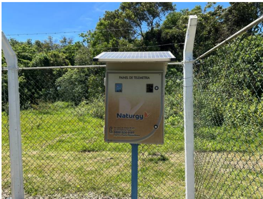
Foto 9: Pannel de telemetria da estação.
