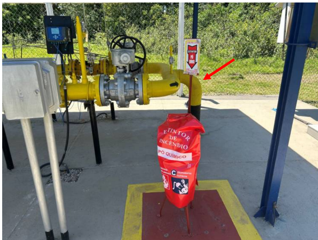
Foto 7: Linha de saída (atrás); extintor de incêndio com cobertura (à frente).
