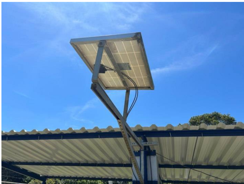
Foto 10: Pannel de placas fotovoltaicas da estação.
