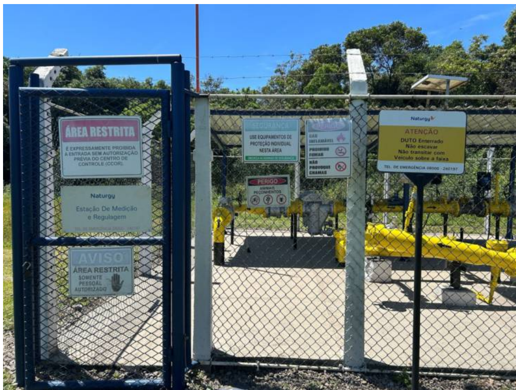
Foto 3: Entrada da ERM São Francisco, com placas de sinalização de segurança.
