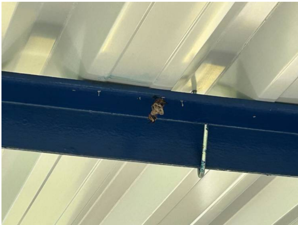
Foto 11: Ninho de marimbondo na cobertura da estação.
