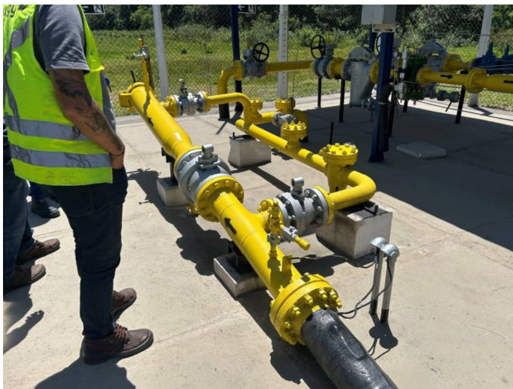
Foto 8: Canhão receptor de PIG da estação.
