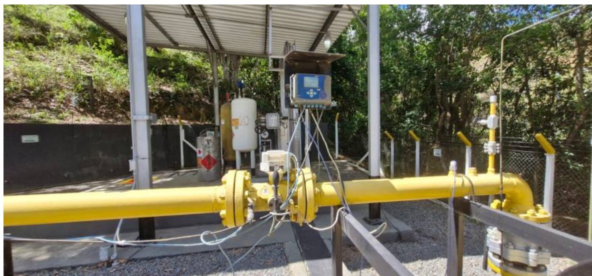
Foto 4: Medidor tipo turbina.
