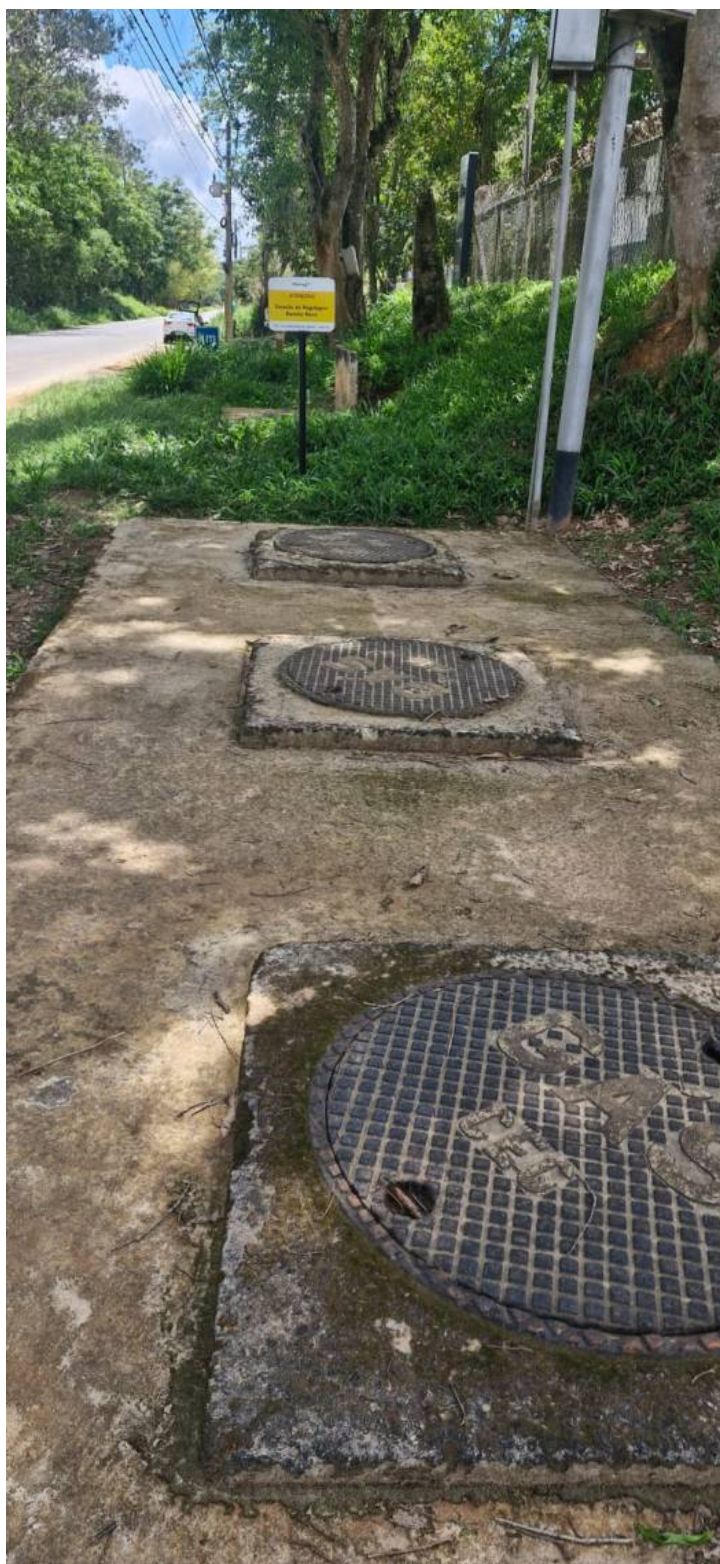
Foto 7: Estação Subterrânea de Regulação.
