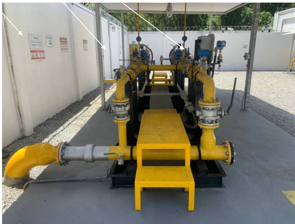
Foto 3: Skid de Regulagem e Medição
