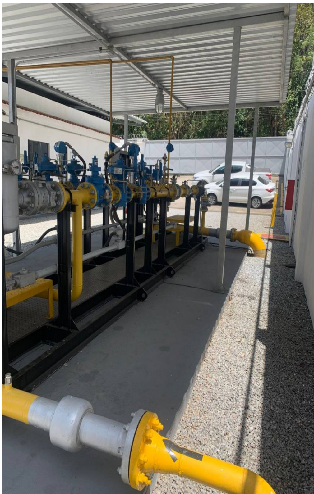
Foto 6: Skid de Regulagem e Medição.
