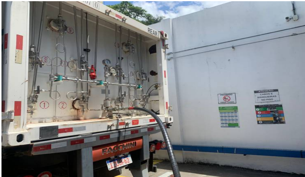
Foto 13: Detalhe da conexão da carreta de gás natural comprimido (GNC) à ERM Nova Friburgo.
