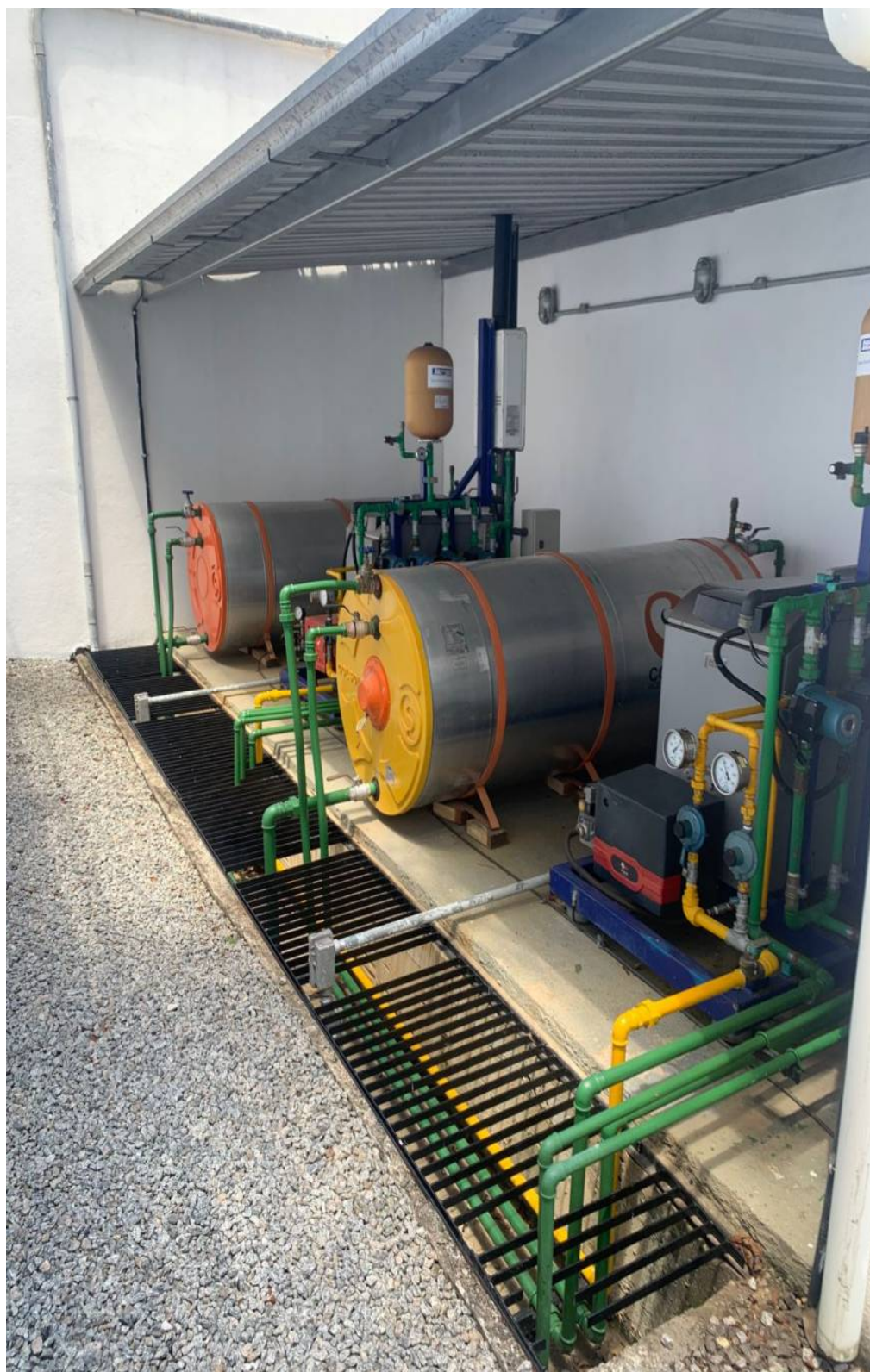
Foto 5: Sistema de Aquecimento de Água
