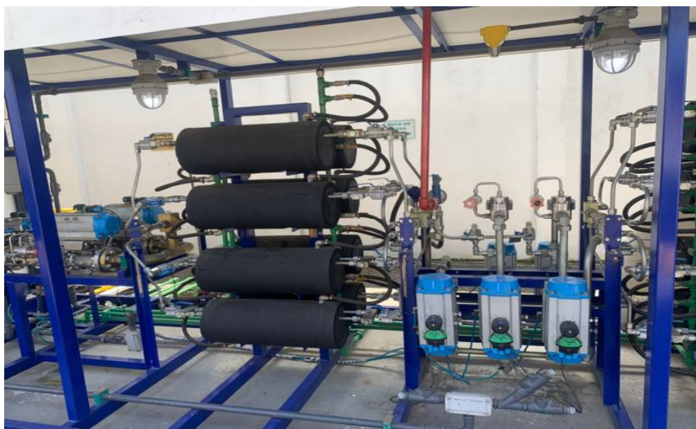
Foto 9: Paineis de Controle da RCU
