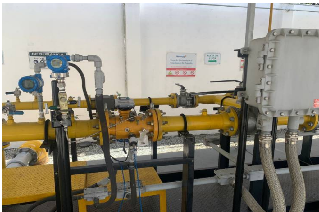
Foto 7: Sistema de filtragem e regulagem
