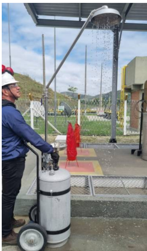
Foto 6: Chuveiro em funcionamento – usado para casos de contaminação com o odorante mercaptana.
