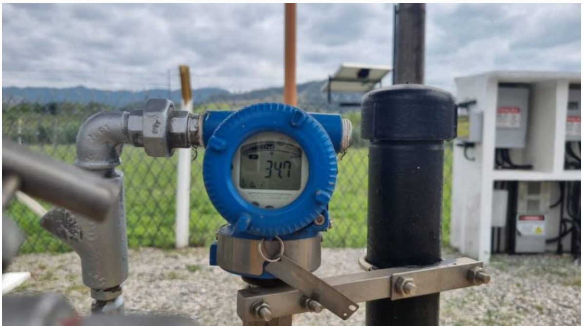
Foto 4: Pressão de entrada.
