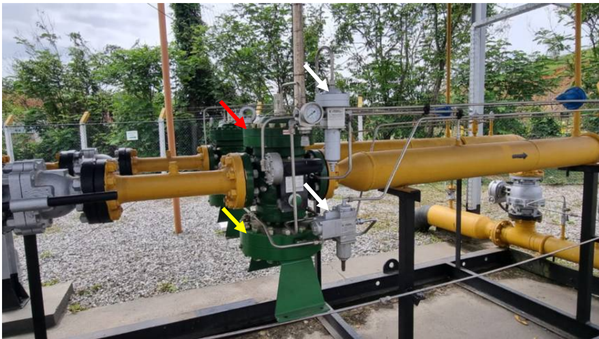
Foto 9: Regulador ativo (seta vermelha), regulador monitor (seta amarela) e válvulas de bloqueio (setas brancas) no módulo de medição e regulagem.
