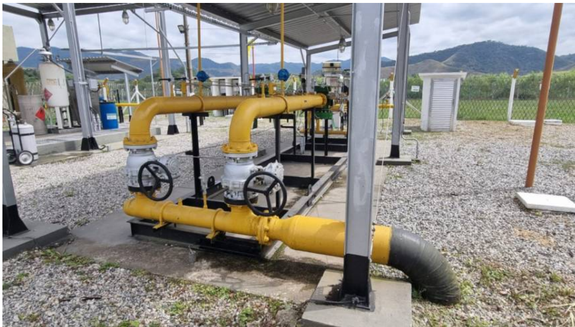
Foto 10: Linha de saída (pressão de 4 bar em duto de Ø 8") – visa distribuir o gás natural canalizado para os municípios de Paracambi e Engenheiro Paulo de Frontin.
