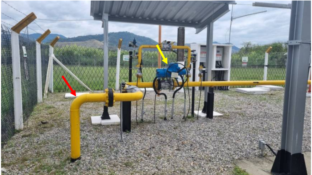
Foto 3: Linha de entrada (seta vermelha) – o gás é recebido da empresa NTS através de tubulação de Ø 4" - e válvula telecomandada (seta amarela).
