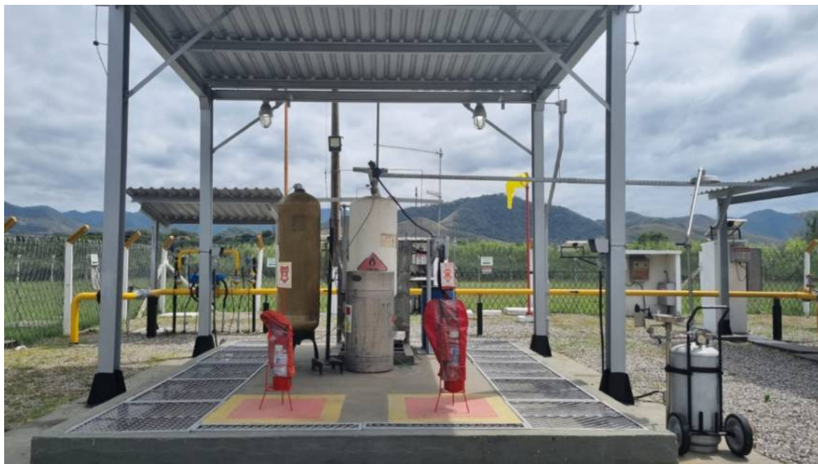
Foto 5: Sistema de odorização composto por um tanque de mercaptana.
