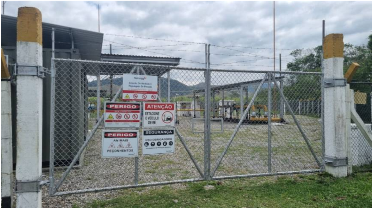
Foto 1: Portão de entrada da Estação de Regulagem e Medição de Paracambi/RJ, com a placa de identificação e com as placas de sinalização de segurança.
