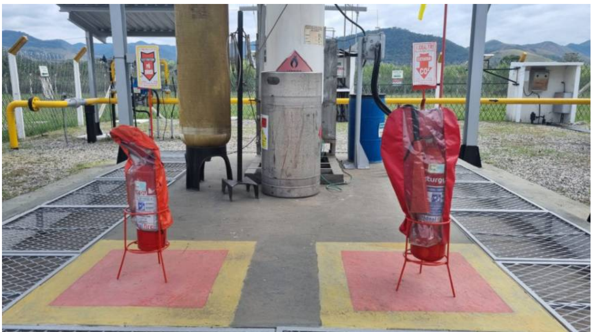
Foto 14: Extintores presentes na estação – ambos foram verificados e estavam dentro da validade.
