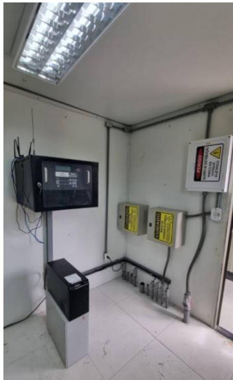
Foto 12: Sala de controle do sistema de telemetria e Nobreak.
