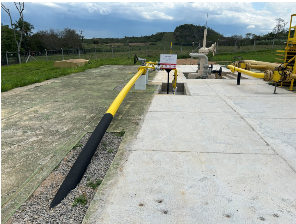
Foto 4: GASCAM (6") onde está instalada a válvula de bloqueio XV-110.
