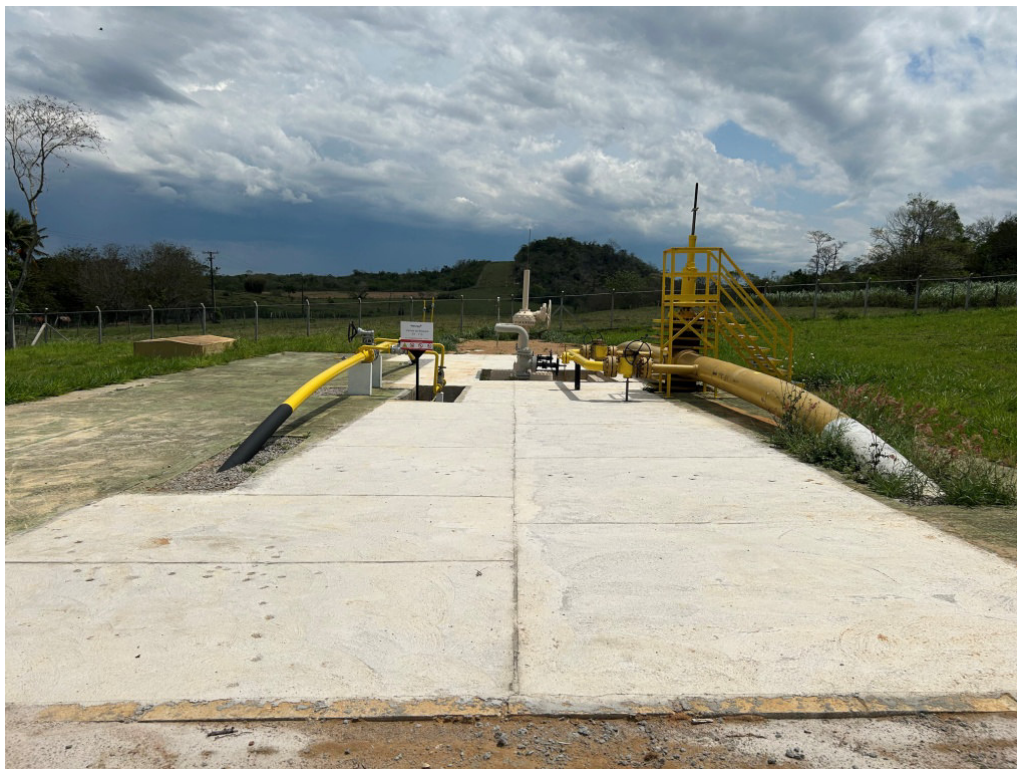
Foto 3: Área de válvulas.
