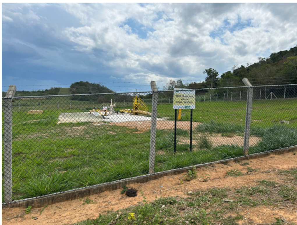
Foto 2: Vista externa da área de válvulas da Transpetro com placa de identificação.
