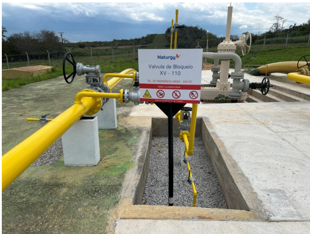
Foto 5: Placa de identificação da válvula de bloqueio XV-110.
