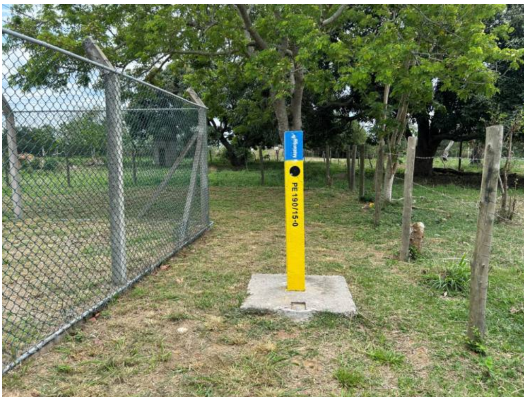
Foto 8: Ponto de teste de proteção catódica na área externa da estação.
