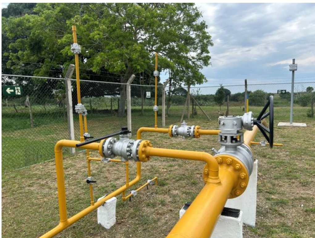
Foto 4: Válvula de bloqueio XV-120 (à direita) e bypass (à esquerda).
