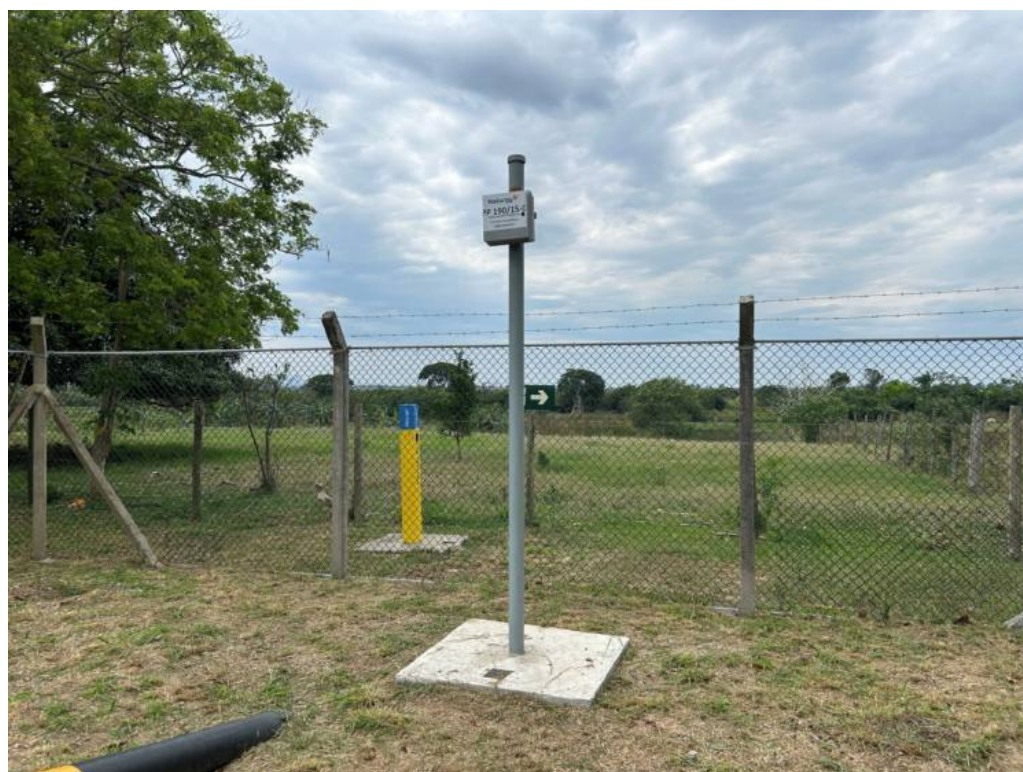
Foto 6: Tomada de potencial para monitoramento da proteção catódica da tubulação.
