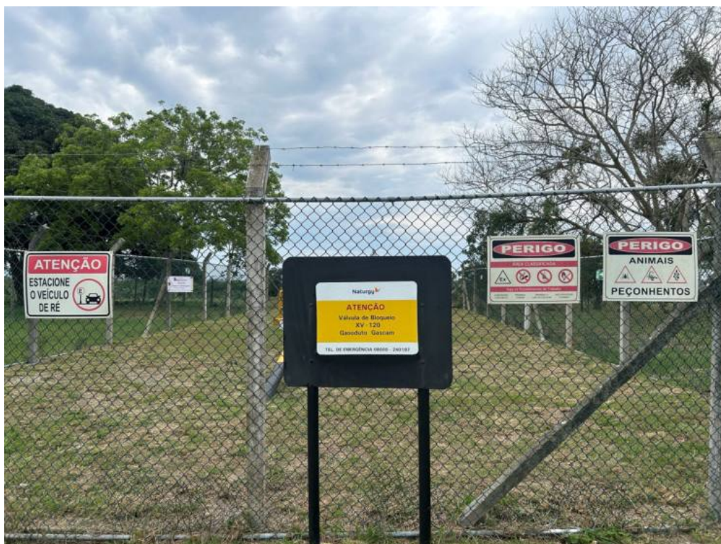
Foto 2: Placa de identificação da válvula e sinalizações de segurança.
