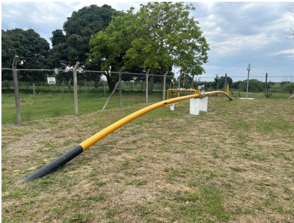
Foto 3: Gasoduto de 6" e válvula de bloqueio.
