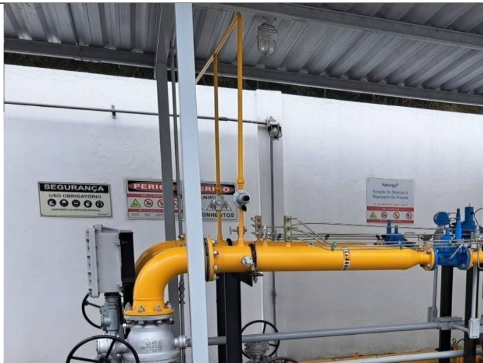
Foto 5: Skid de Regulagem e Medição
