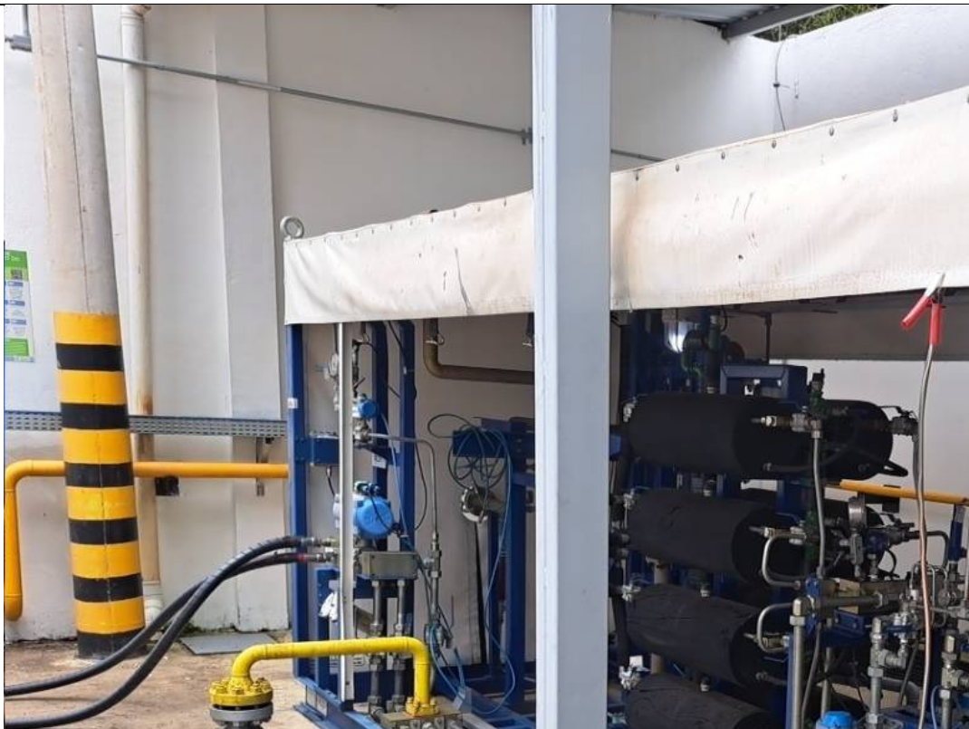
Foto 4: RCU em operação
