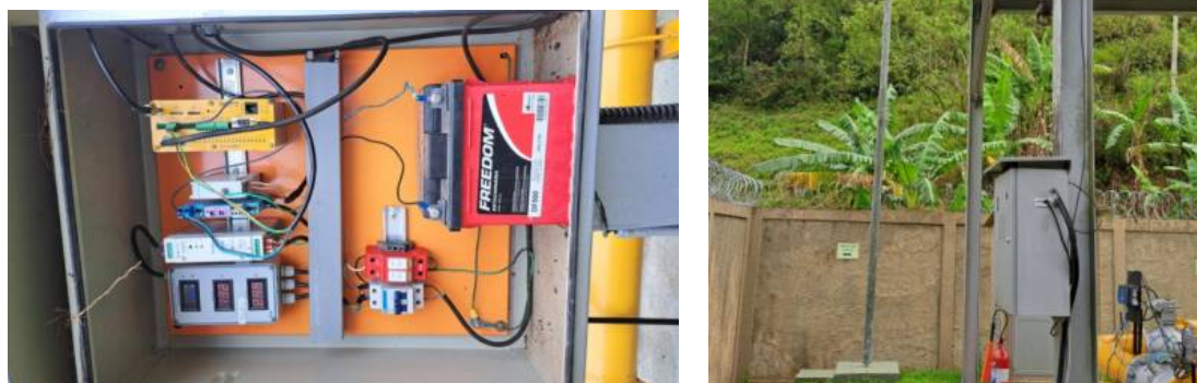
Foto 4: Sistema de telemetria do medidor de vazão
