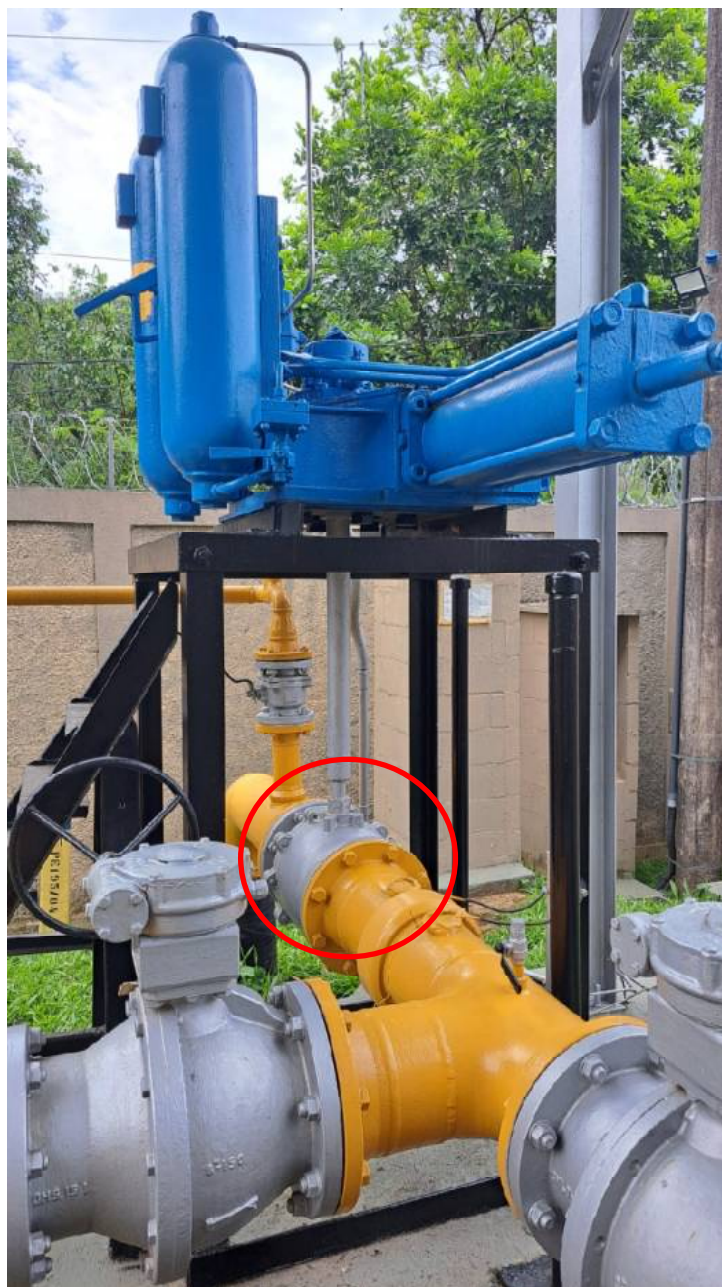
Foto 5: Válvula de bloqueio telecomandada.
