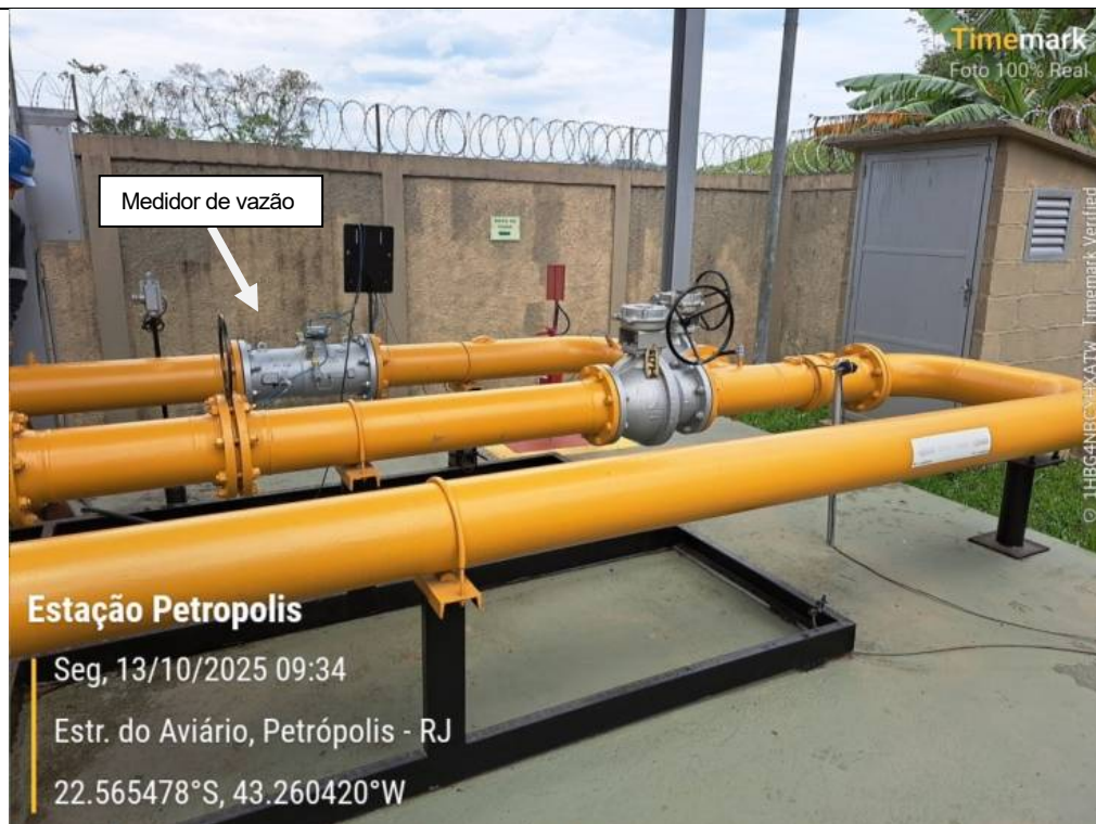
Foto 2: Vista da Tubulação – Entrada passando pelo medidor de vazão
