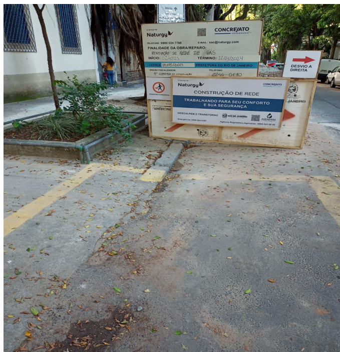
Foto 2: Identificação da obra com irregularidade corrigida
