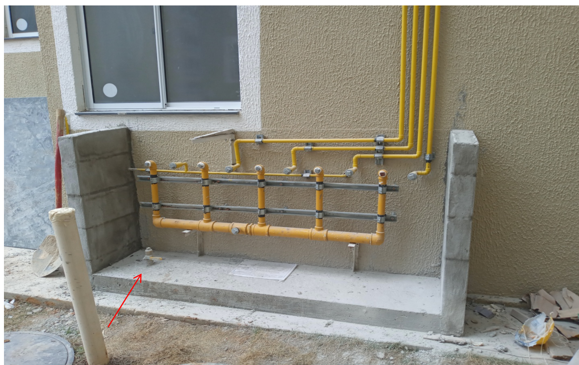
Foto 4: Abrigo de medidores de consumo e regulador de pressão
