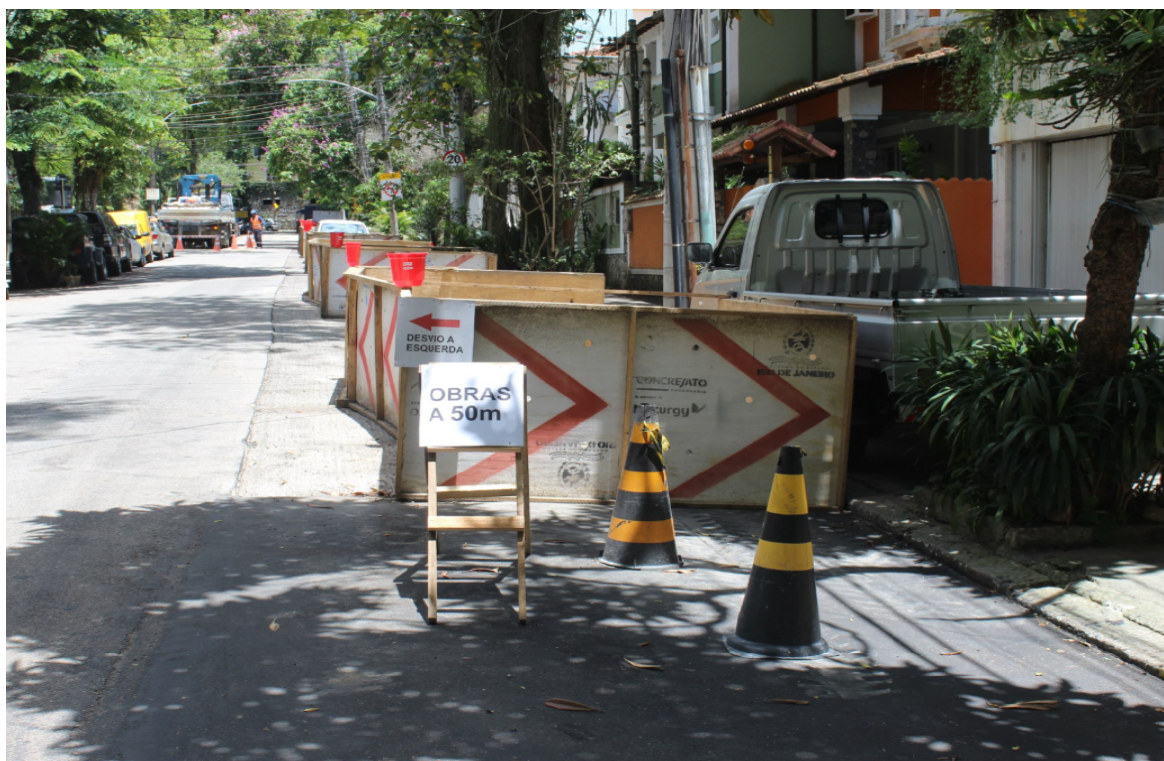
Foto 5: Sinalização em trecho a receber recomposição
