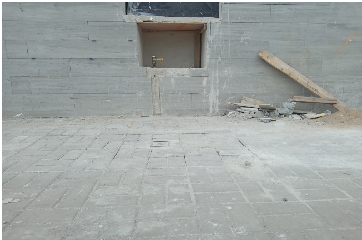
Foto 3: Válvula de ramal e abrigo do medidor
