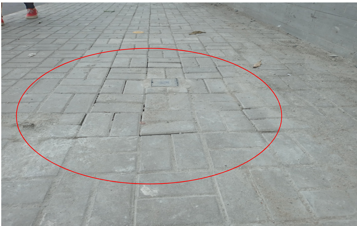
Foto 4: Piso intertravado desnivelado e estaca de madeira
