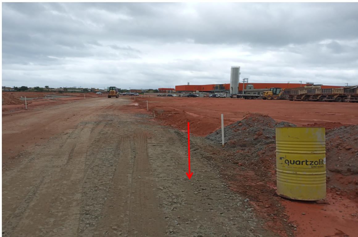
Foto 3: Ponto onde a rede se encontra capeada (canteiro de obra)
