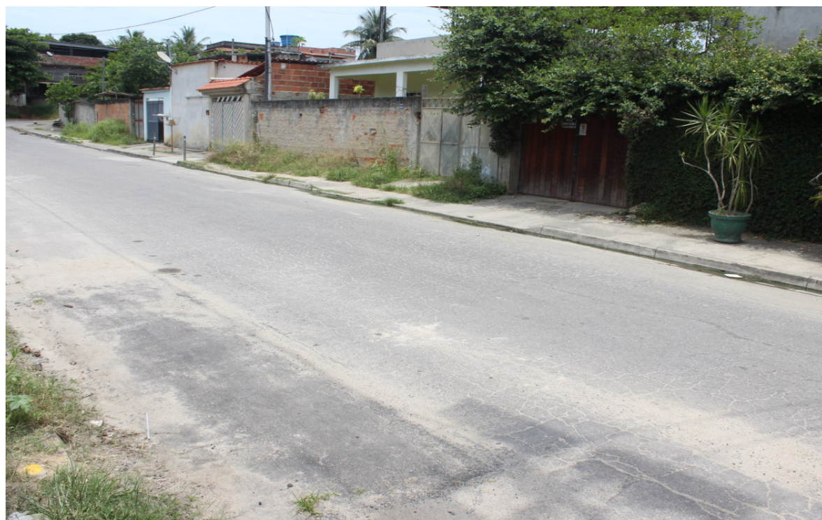
Foto 6: Recomposição com perda material em frente ao Lote 5 QM
