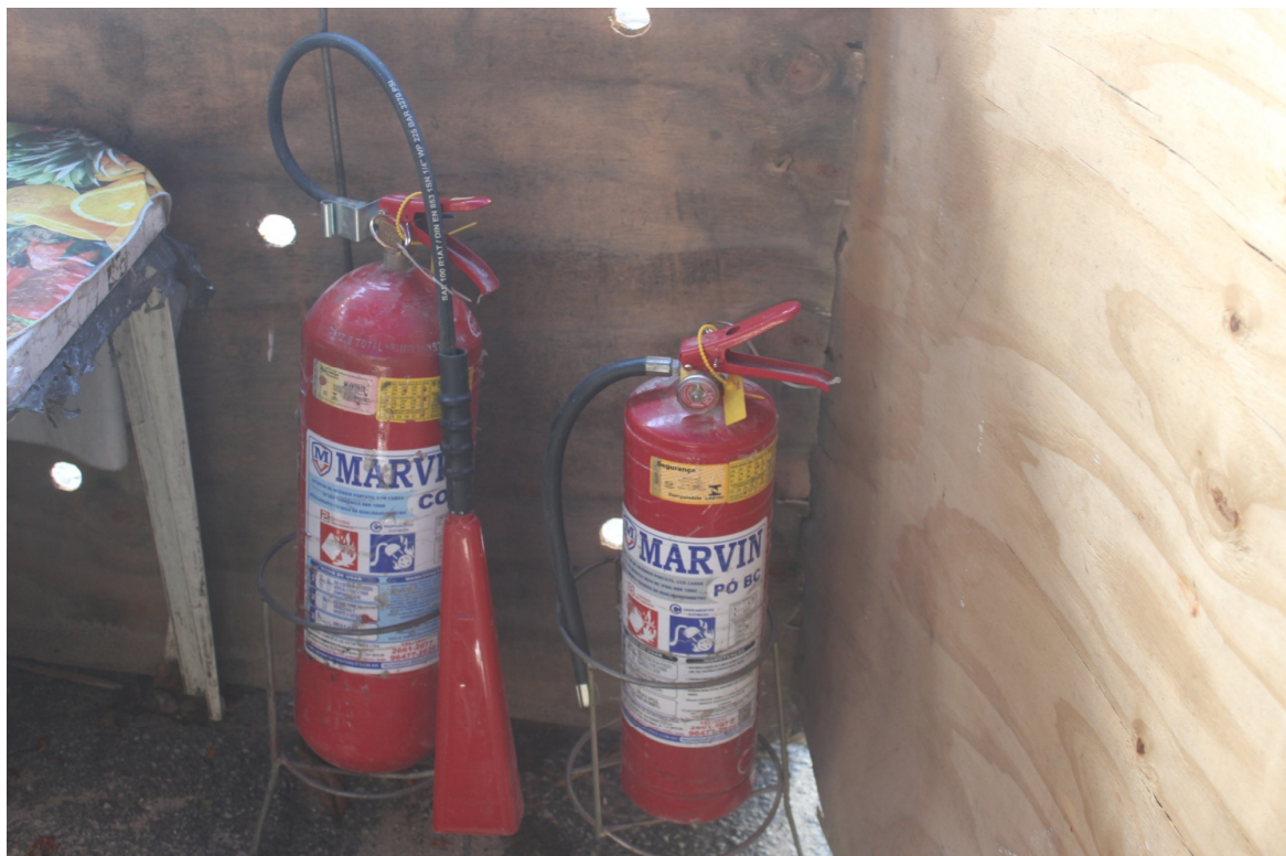
Foto 3: Extintores de incêndio
