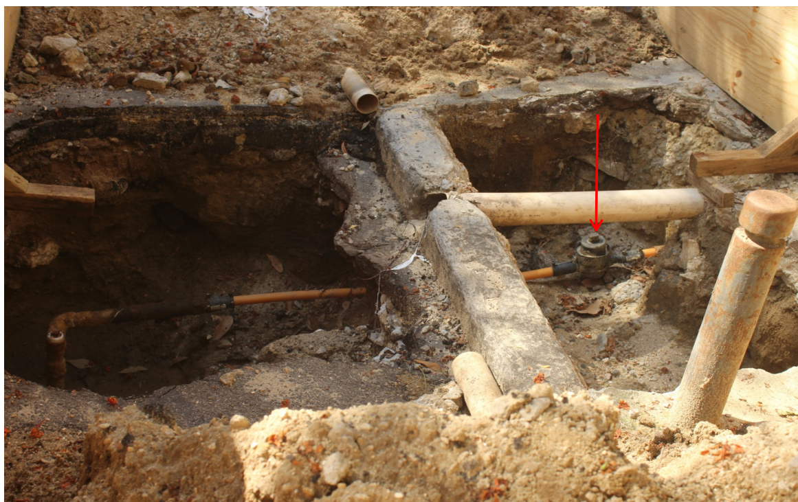
Foto 12: Isolamento lado par - Válvula de bloqueio do ramal
