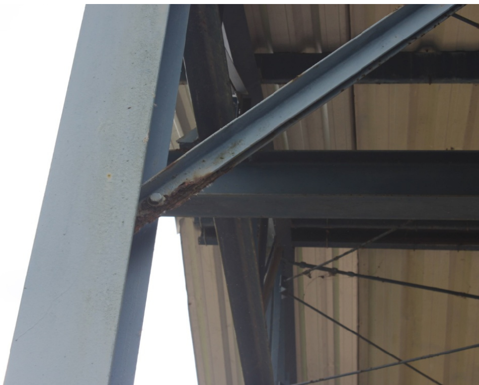
Foto 13: Estrutura necessitando de reparo e pintura como um todo
