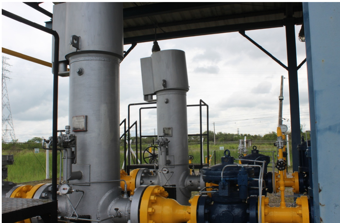
Foto 7: Filtros de gás
