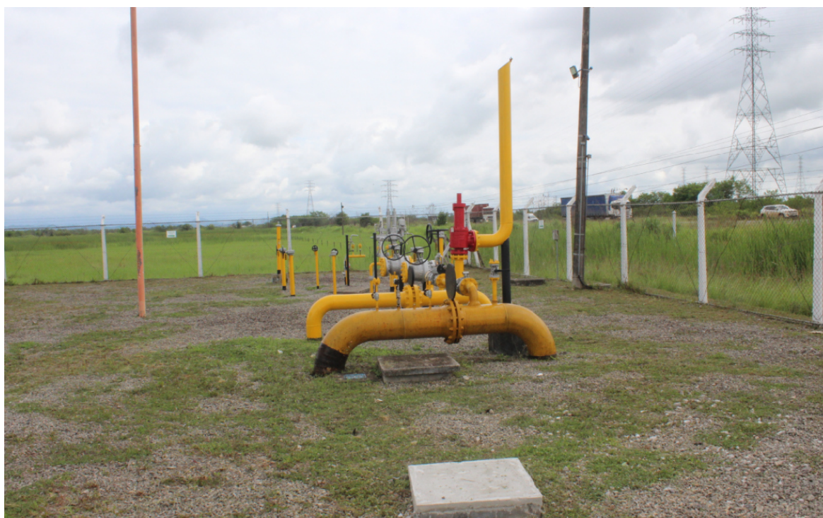
Foto 4: By-pass e reguladores
