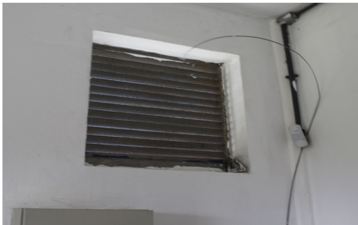
Foto 16: Janela em mau estado de conservação e sem tela de proteção
