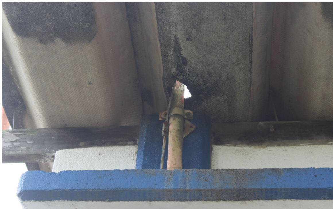
Foto 12: Para-raio em mau estado de conservação e perfurando a telha sem acabamento nas três salas
