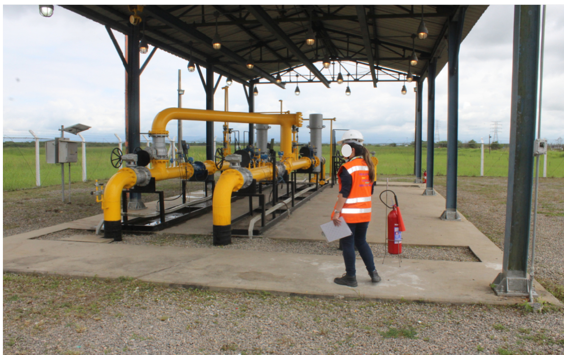
Foto 6: Estação de regulação e medição
