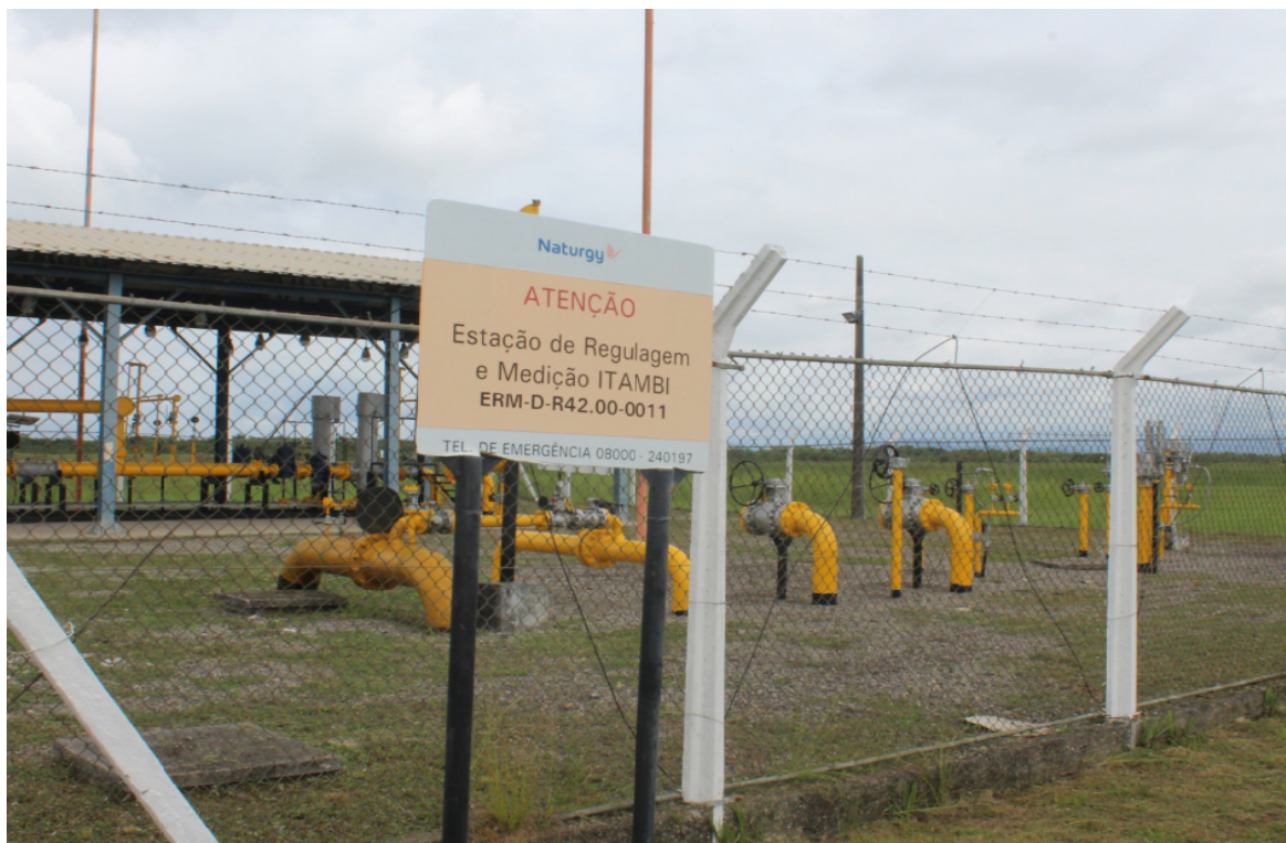
Foto 1: Placa de identificação da estação
