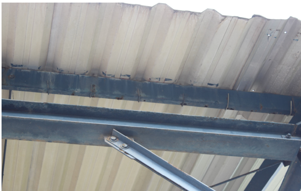
Foto 14: Estrutura necessitando de reparo e pintura como um todo
