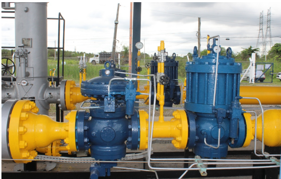
Foto 8: Reguladores de pressão
