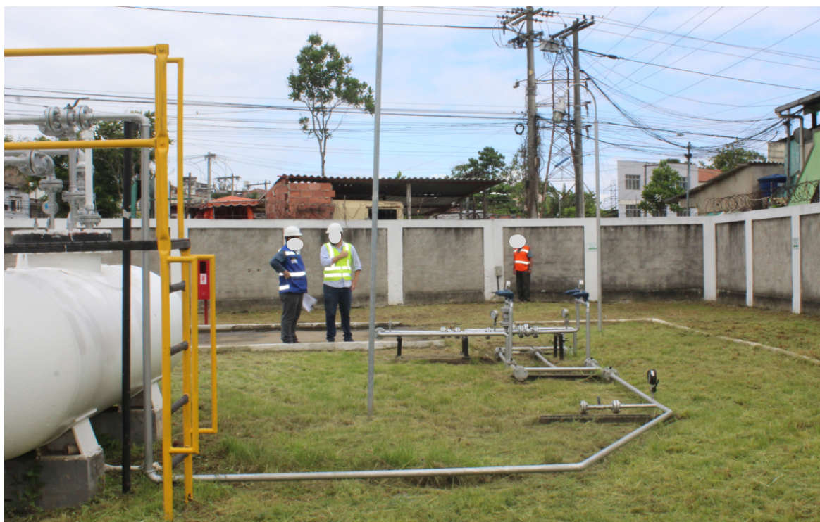
Foto 4: Linha de saída de gás a partir dos cilindros de armazenamento
