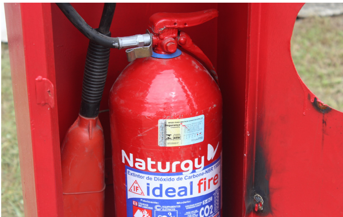
Foto 12: Extintor sem lacre e sem pino
