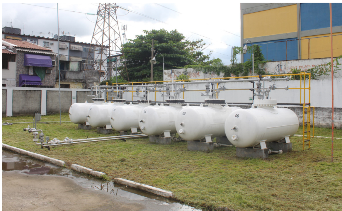
Foto 2: Cilindros de armazenamento
