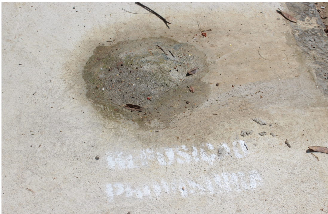
Foto 4: Sinalização de recomposição provisória em ponto do passeio com indícios de infiltração
