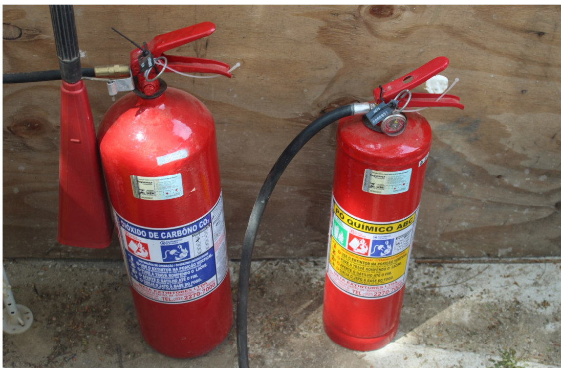
Foto 7: Extintores de incêndio presentes na obra
