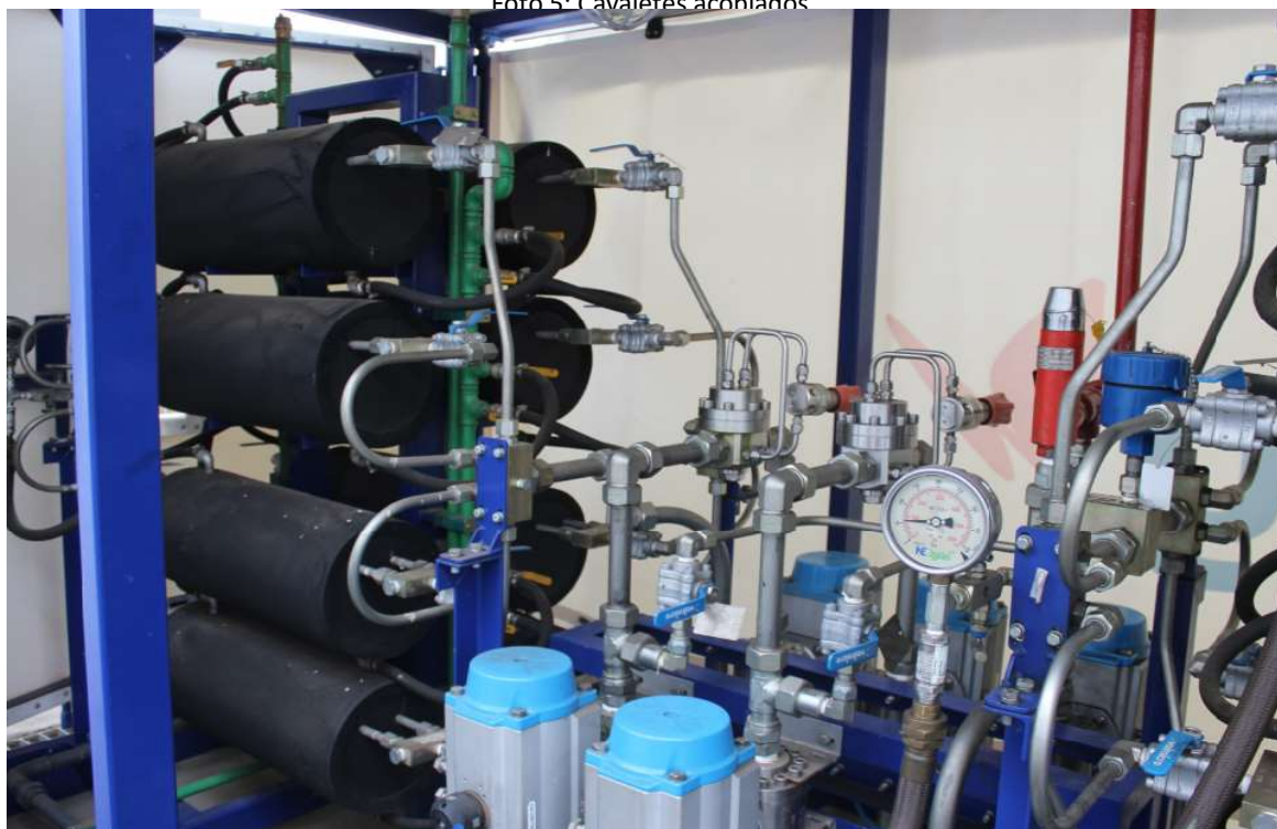
Foto 6: Trocadores de calor e reguladores de 1º estágio
