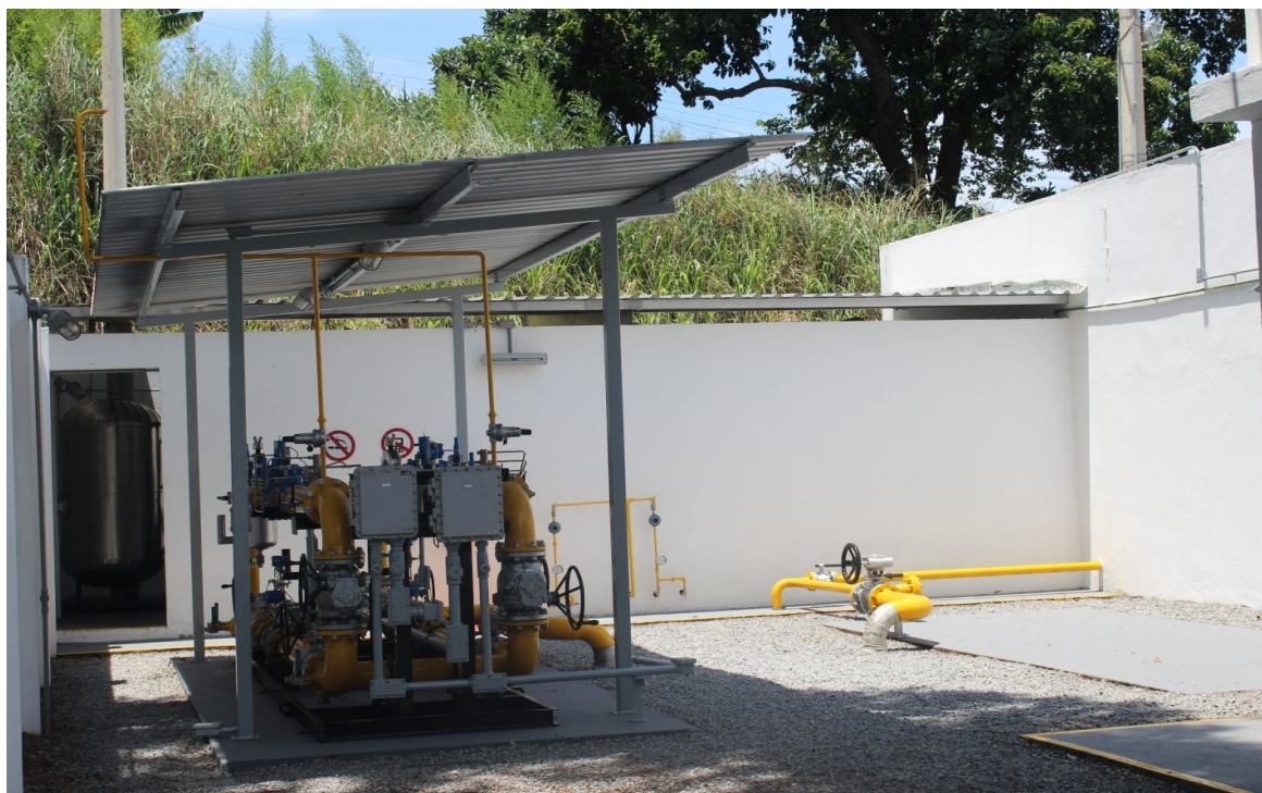
Foto 7: Estação de Regulagem e Medição
