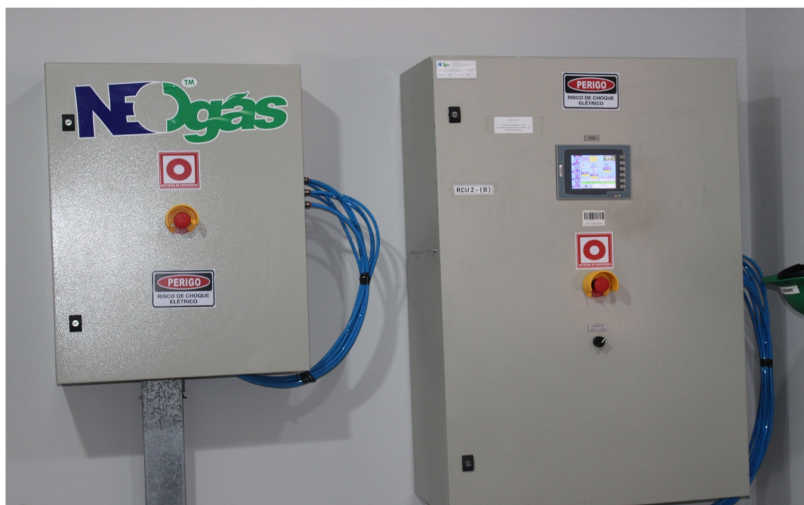
Foto 12: Painéis de comando e monitoramento da Unidade de Controle e Redução (RCU)
