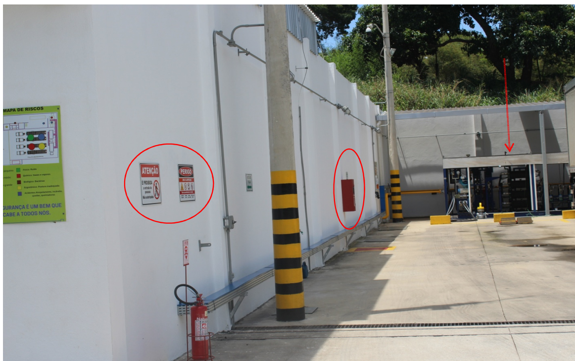
Foto 5: Sinalização de segurança, extintor de incêndio e RCU
