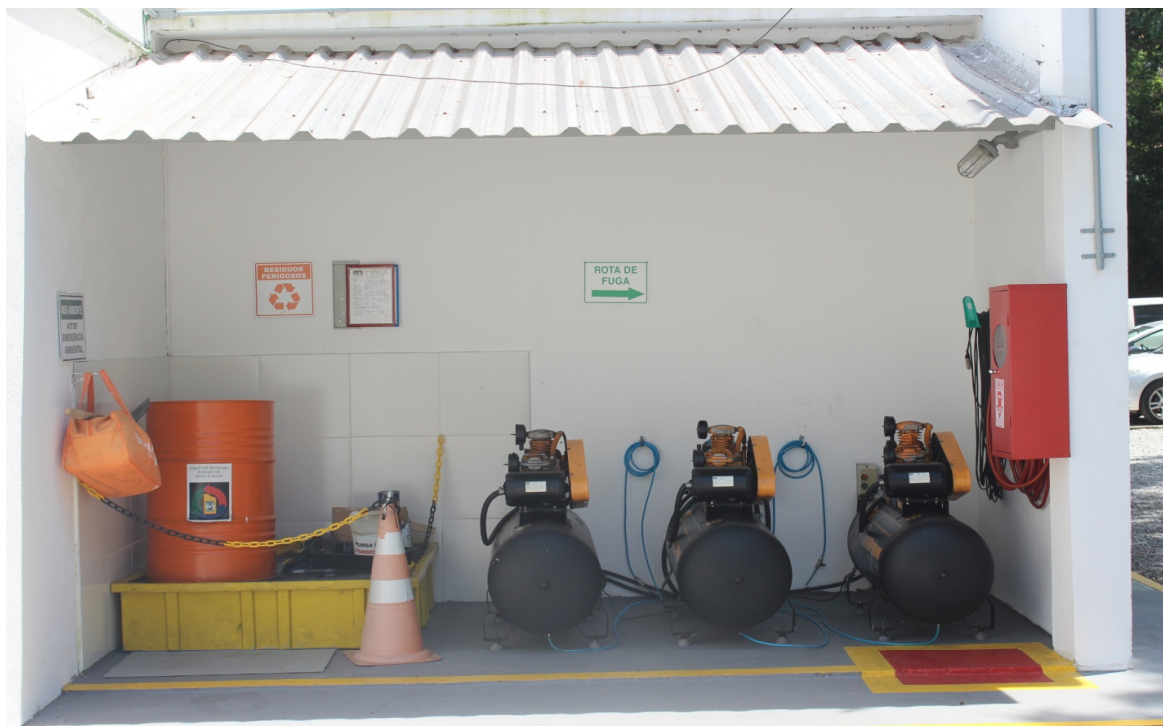
Foto 11: Compressores do sistema de comando de válvulas da RCU
