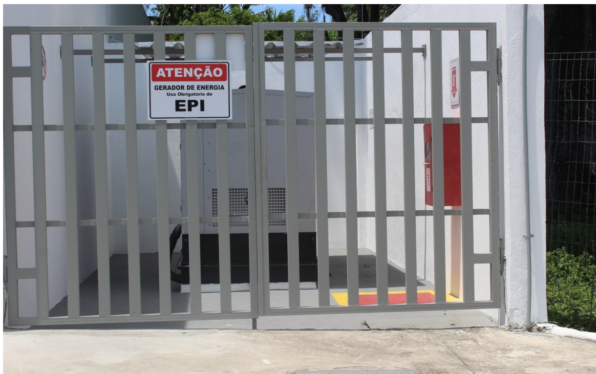
Foto 15: Gerador de emergência - 55KVA
