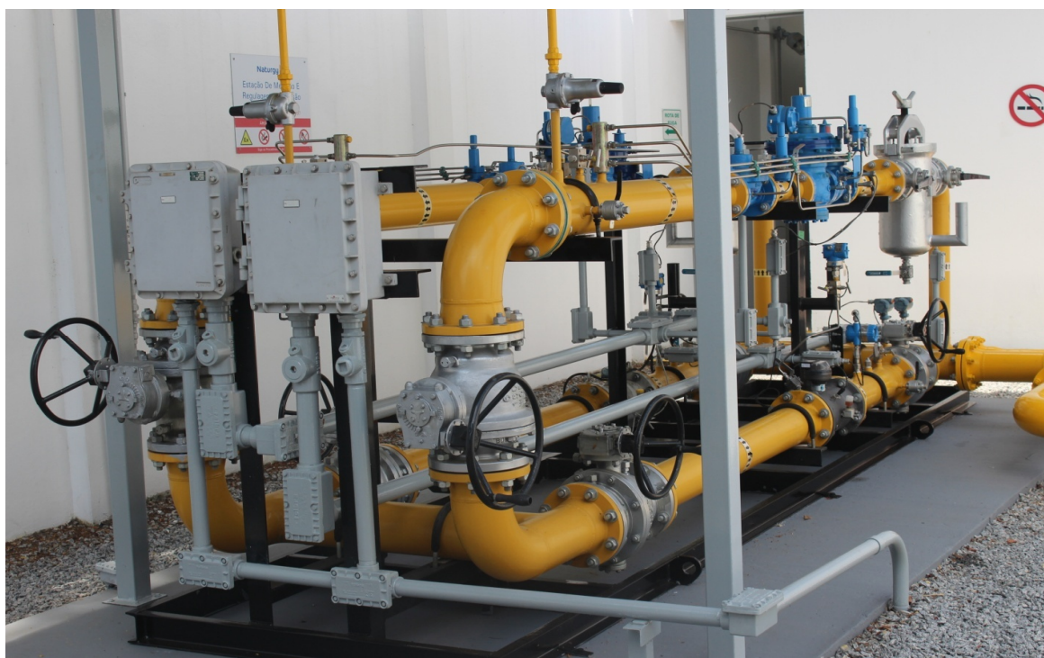
Foto 8: Vista lateral da estação de regulagem e medição
