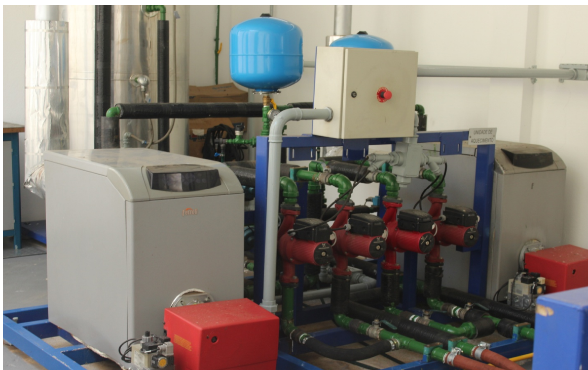
Foto 6: Aquecimento, armazenamento e recalque água do trocador de calor
