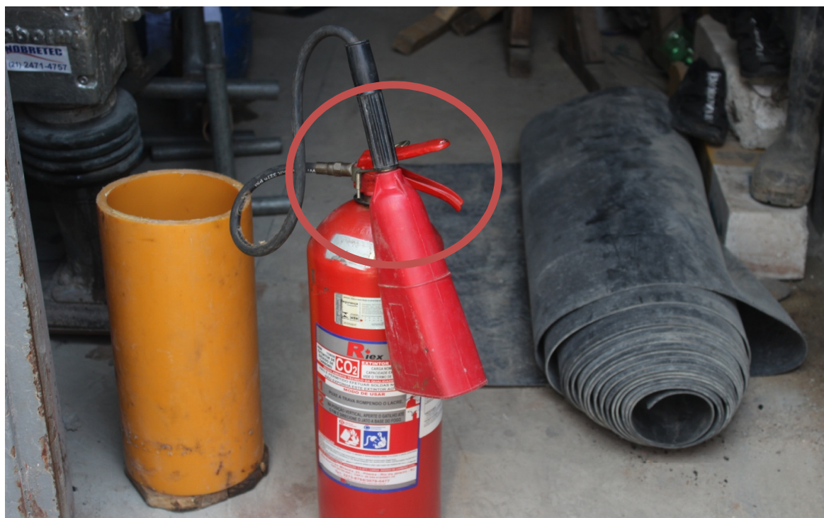
Foto 7: Extintor de CO2 com lacre danificado
