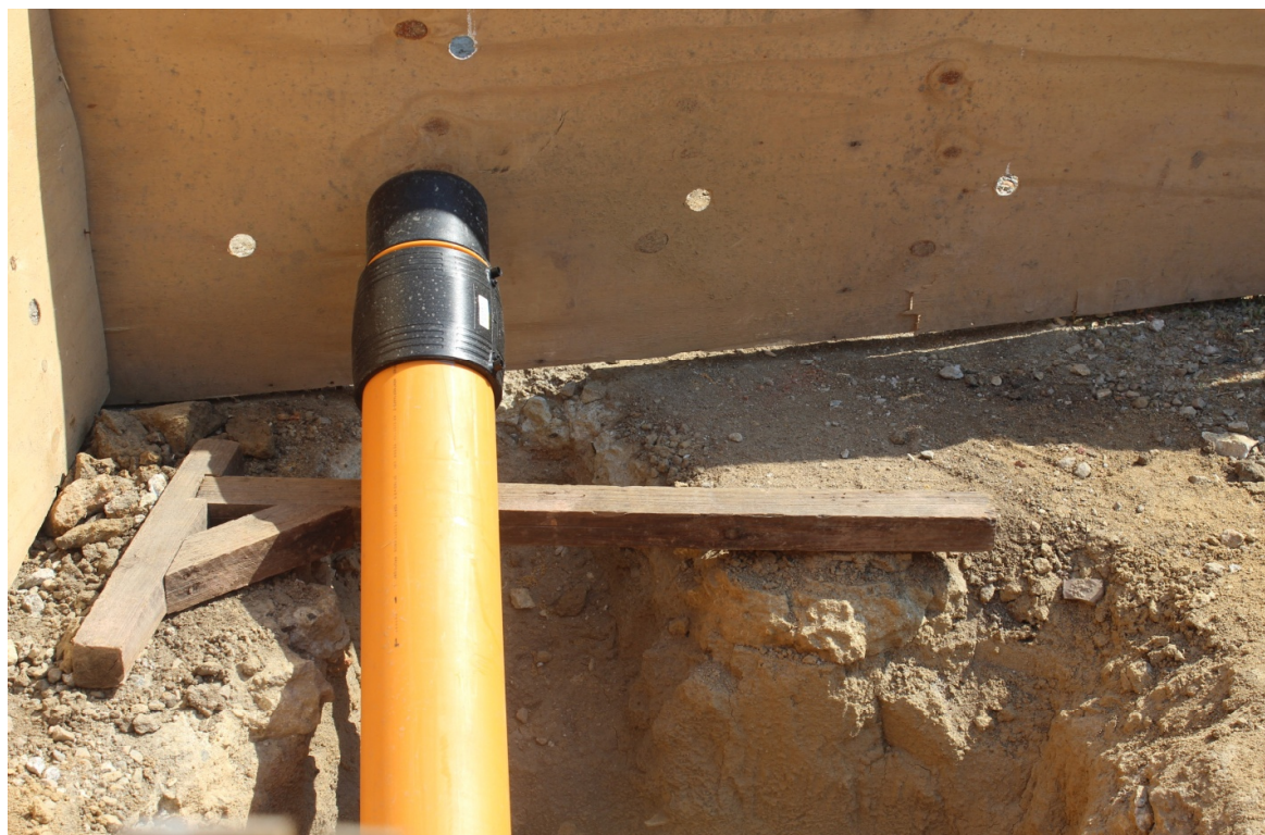
Foto 5: Término da rede em expansão despressurizada
