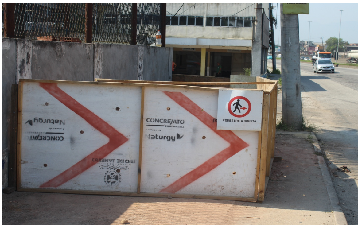
Foto 6: Placa de sinalização para desvio de pedestre no passeio
