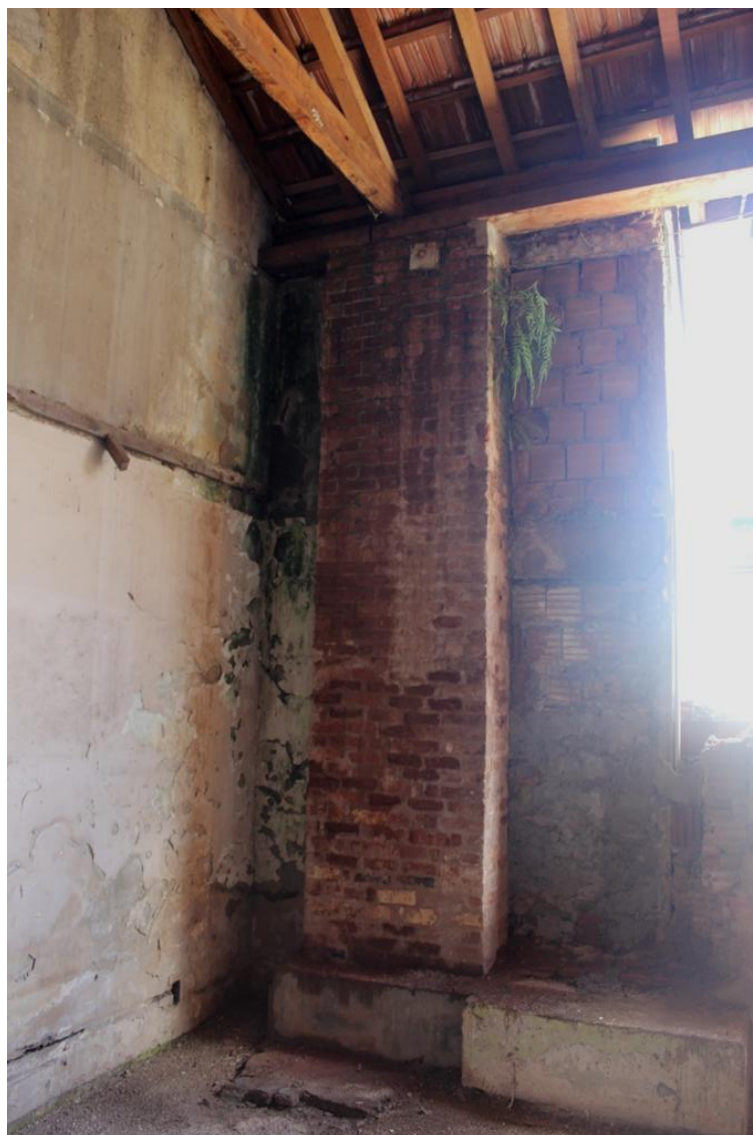
Figura 10 - Pilar e parede sob ação de vazamento no telhado.
