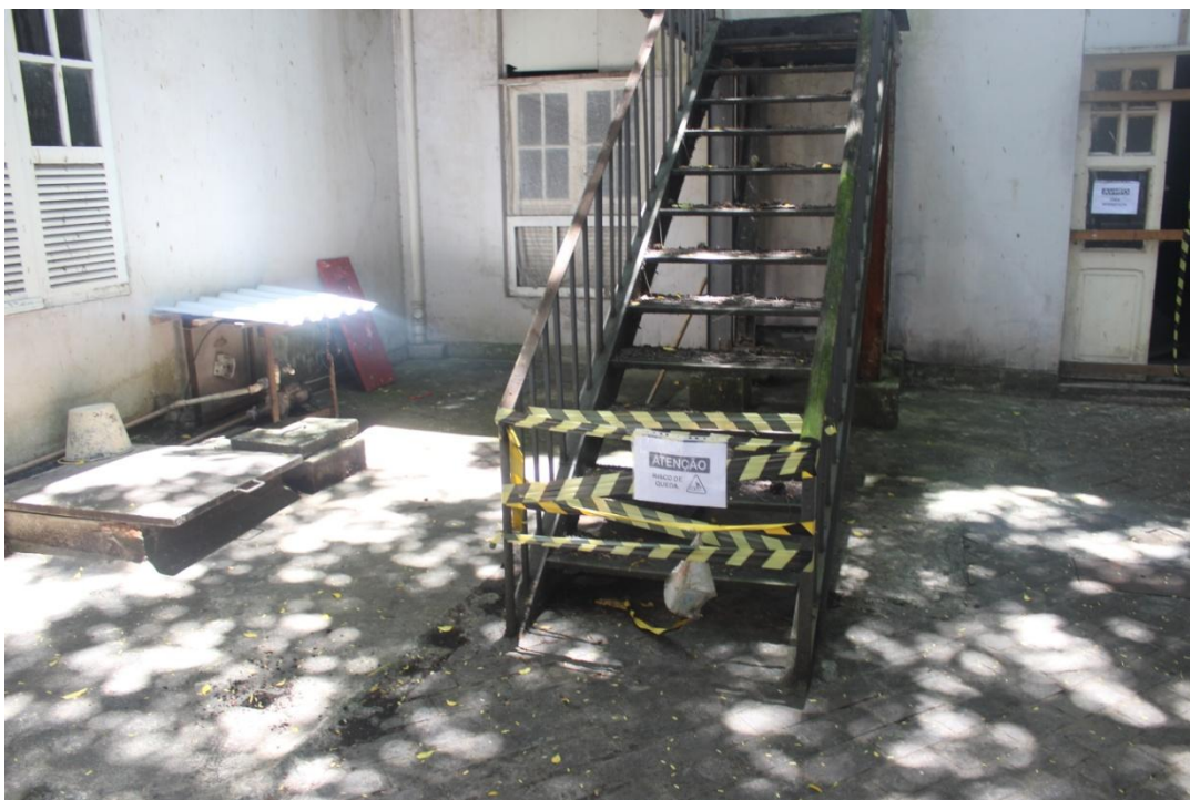
Figura 7 – Placa de interdição da escada metálica.
