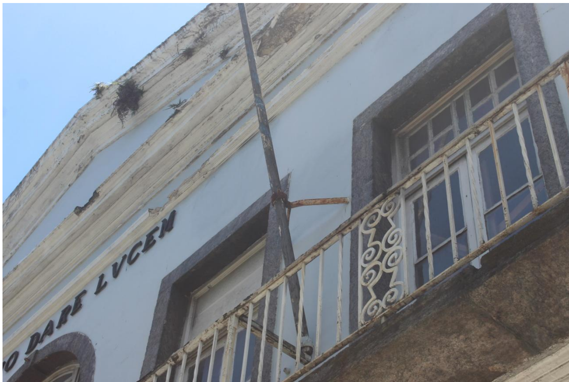
Figura 28– Suporte metálico do mastro.
