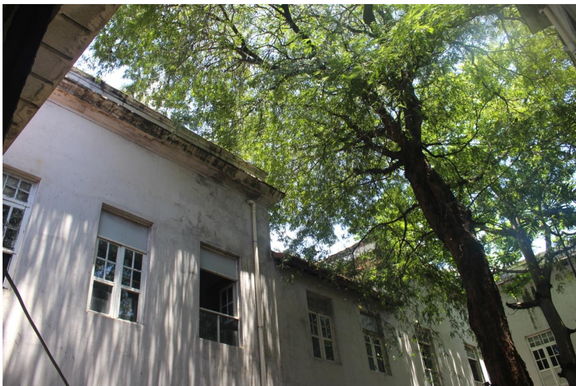
Figura 19 – Árvores necessitando de podas.
