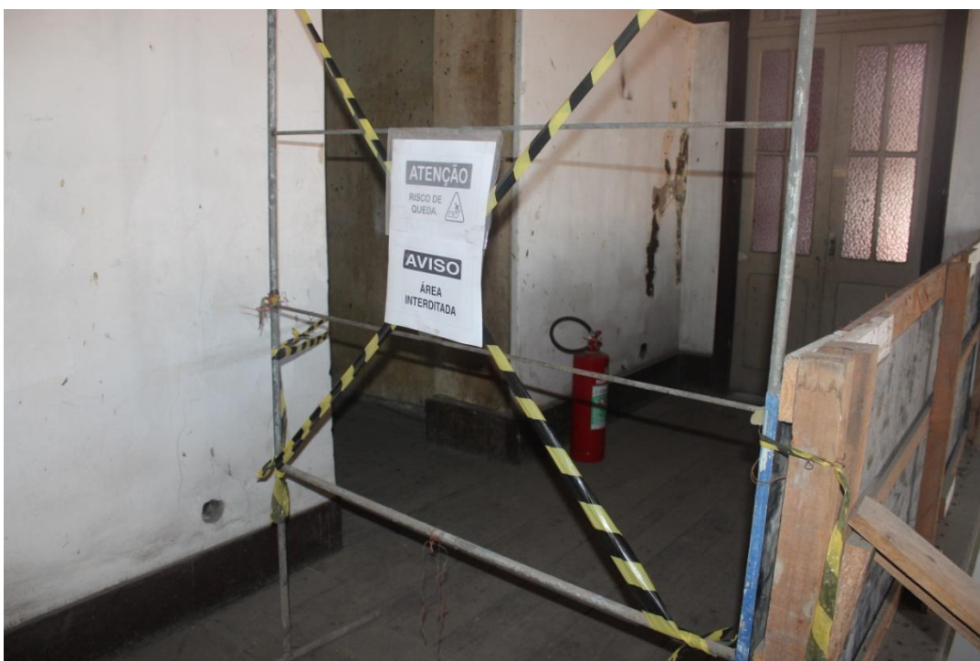
Figura 8 – Placa de interdição na área de acesso interno ao pavimento superior da ala esquerda.
