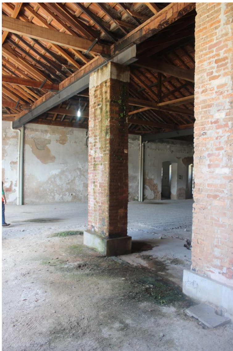
Figura 9 – Pilar sob ação de vazamento no telhado.
