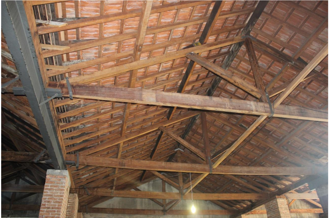
Figura 13- Cobertura sem forro do grande salão lateral.
