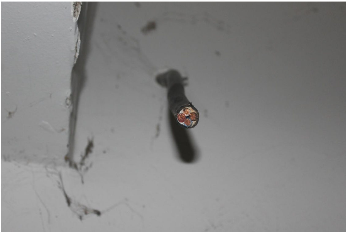
Figura 12 – Fiação elétrica saindo da parede.
