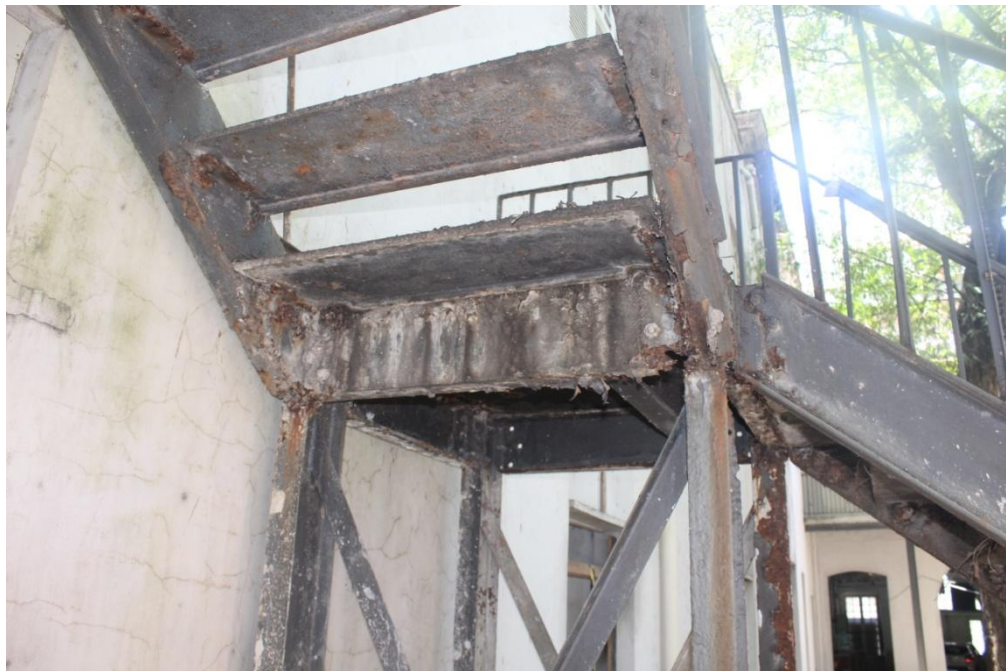
Figura 6 – Deterioração da escada metálica de acesso aos fundos do pavimento superior da ala direita.
