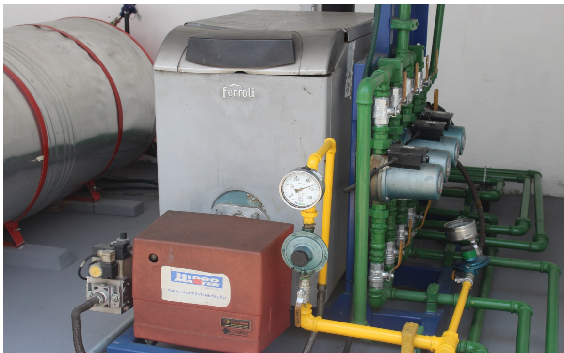
Foto 5: Sistema de aquecimento, armazenamento e recalque de água quente
