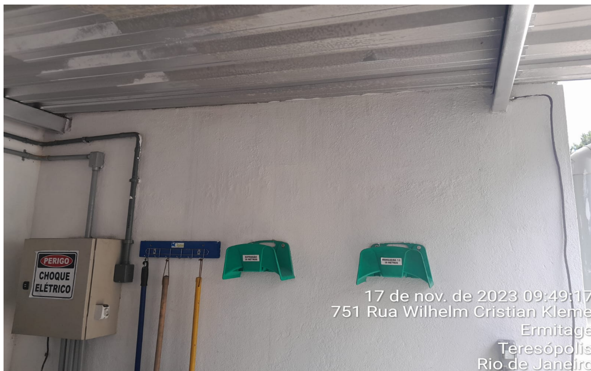
Foto 17: Sala de compressores - parede com pintura refeita
