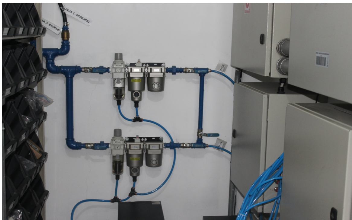
Foto 13: Sistema pneumático de acionamento das válvulas da RCU
