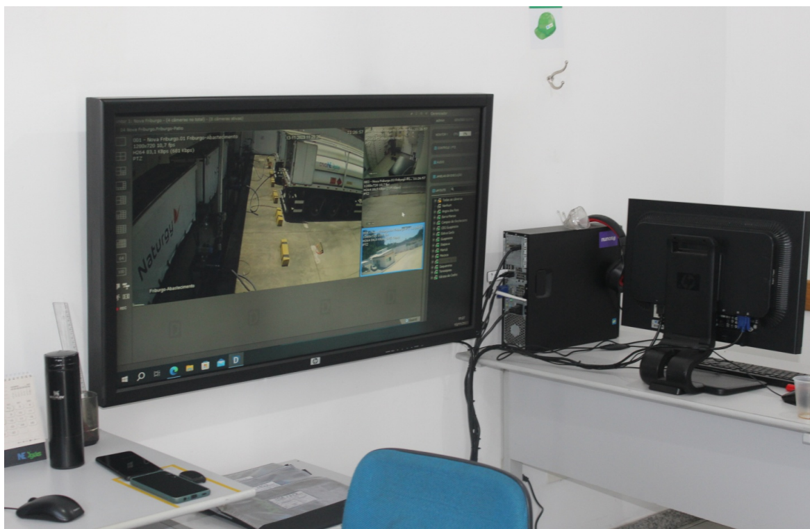
Foto 14: Sala de operação
