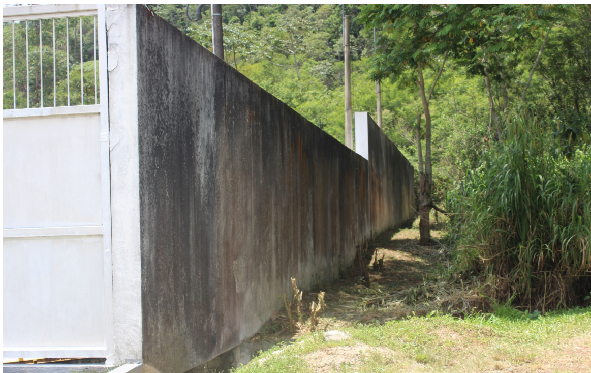
Foto 15: Muro com pintura desgastada
