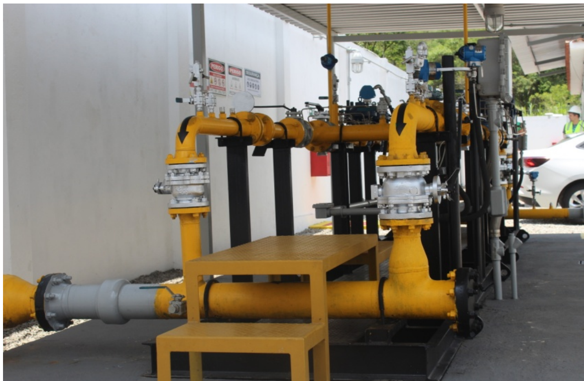
Foto 10: Tubulação de saída (ERM) para distribuição aos consumidores
