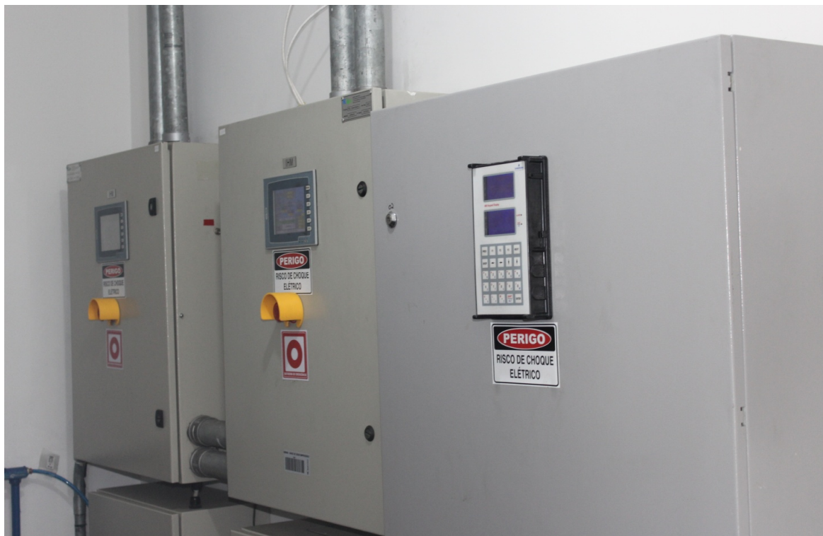
Foto 12: Painéis da sala controle RCU e ERM
