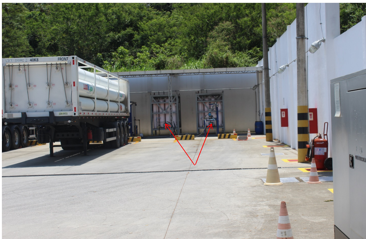
Foto 4: Sistema de estocagem
