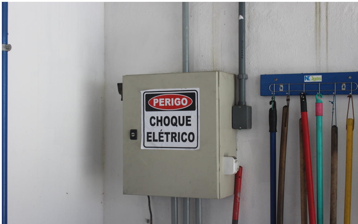
Foto 11: Sala de compressores de ar - (Quadro de comando)
