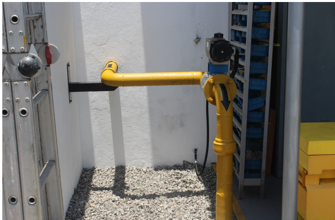
Foto 6: Tubulação de saída da unidade de descompressão - 7 bar
