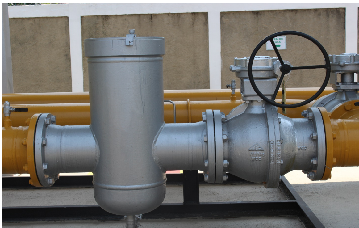
Foto 4: Filtro e válvula
