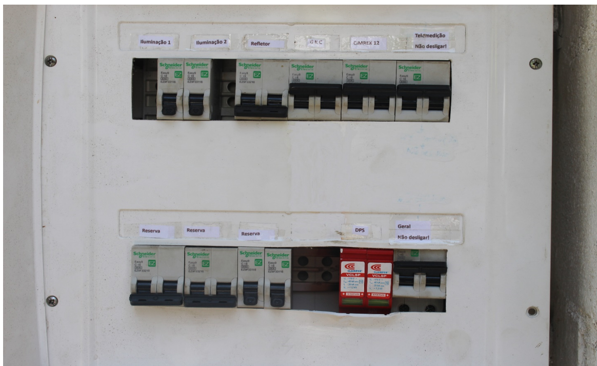
Foto 11: Quadro de distribuição de energia elétrica
