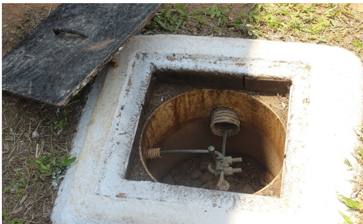
Foto 12: Malha de aterramento SPDA
