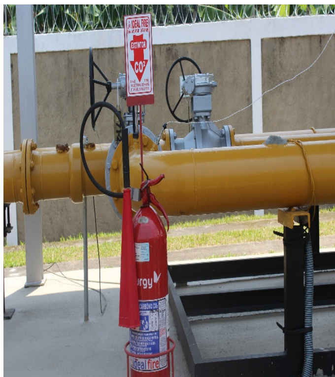
Foto 10: Extintor de CO2
