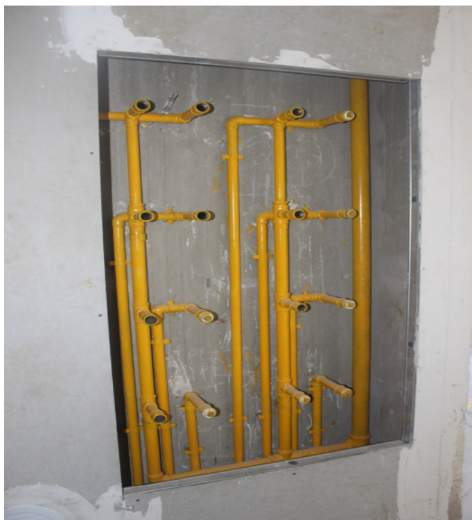
Foto 4: Instalação para medidores internos
