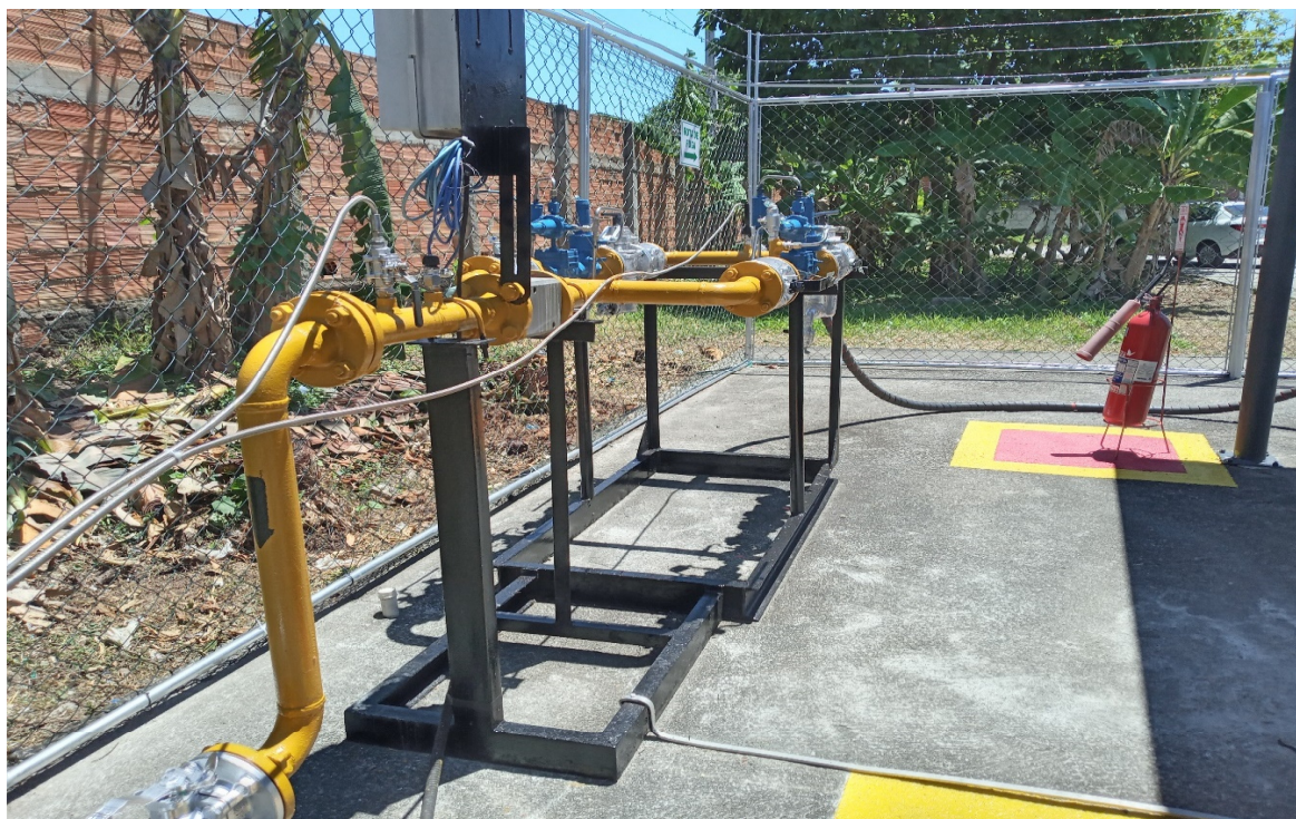
Foto 11: Estação de regulação e medição
