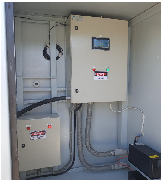
Foto 8: Sala de controle equipada com nobreak
