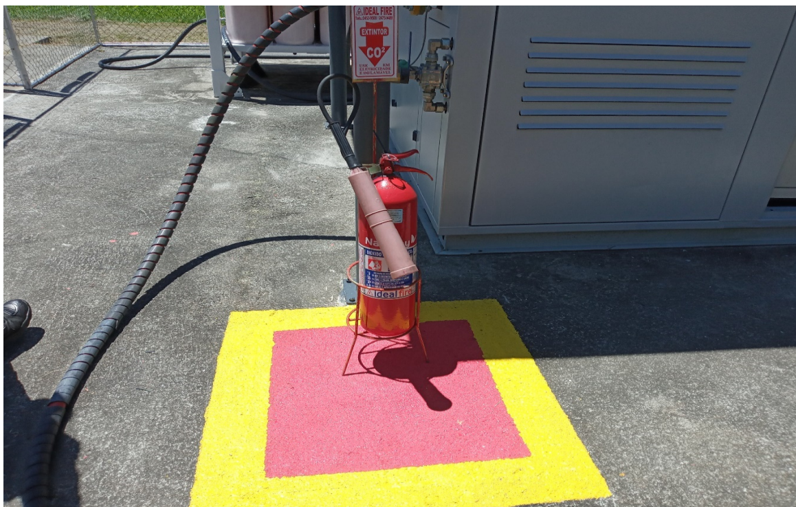
Foto 13: Extintor de CO2
