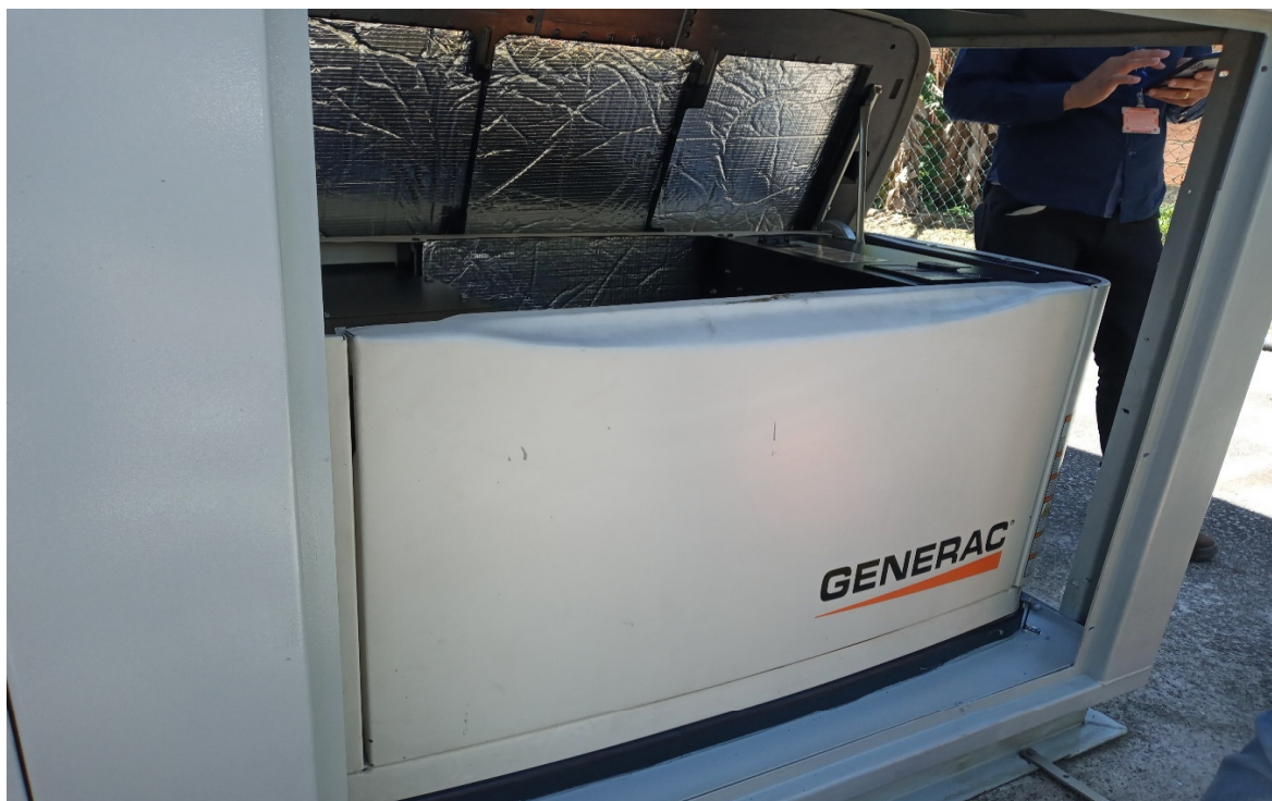
Foto 9: Gerador de emergência a gás
