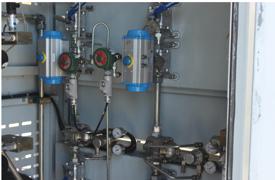
Foto 6: Reguladores de pressão
