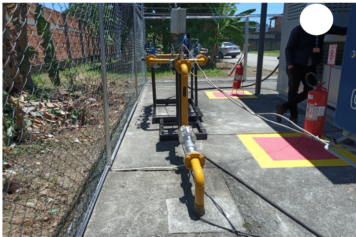
Foto 12: Tubulação de saída para distribuição
