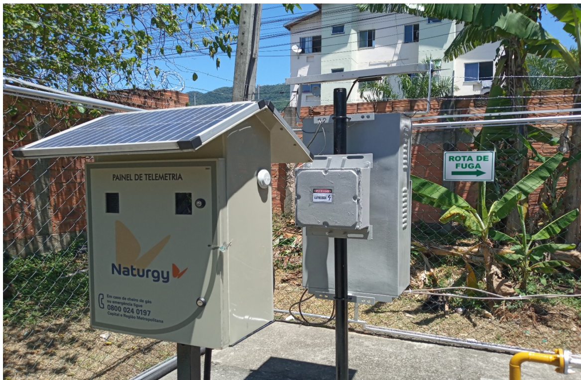
Foto 10: Painéis de telemetria e placas fotovoltaicas
