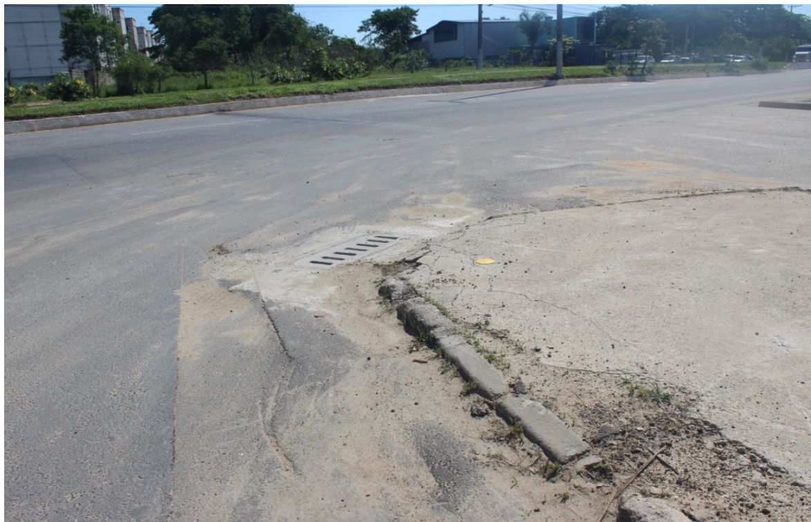
Foto 5: Afundamento de recomposição
