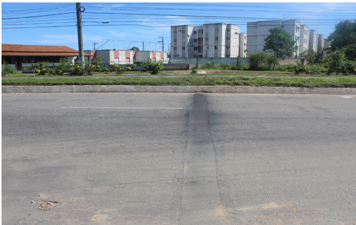
Foto 6: Afundamento de recomposição
