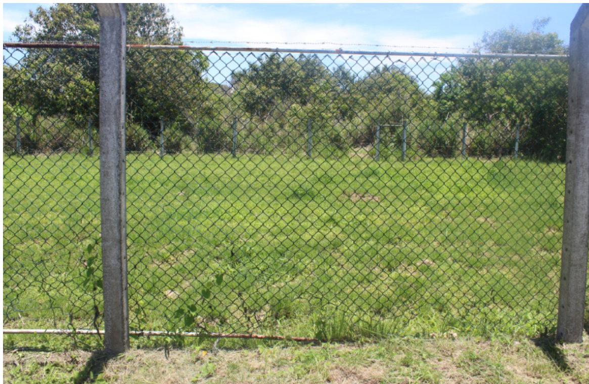
Foto 11: Buracos na cerca e ferrugem
