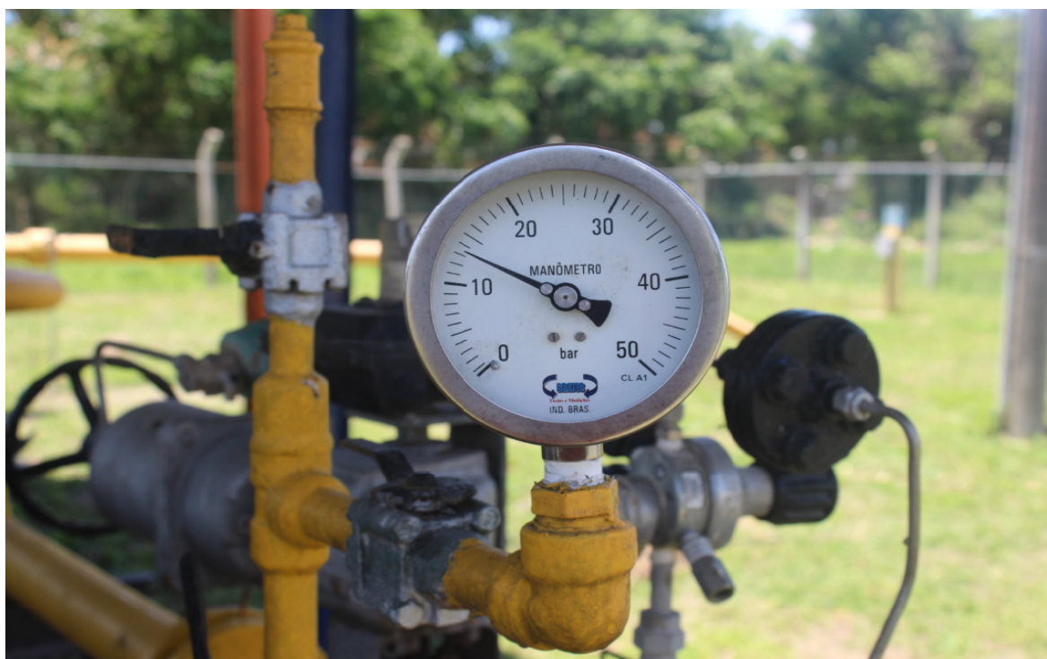
Foto 10: Manômetro colocado localmente indicando a pressão de saída
