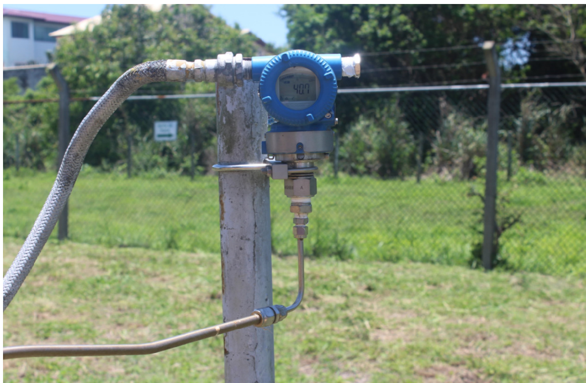
Foto 5: Manômetro de entrada
