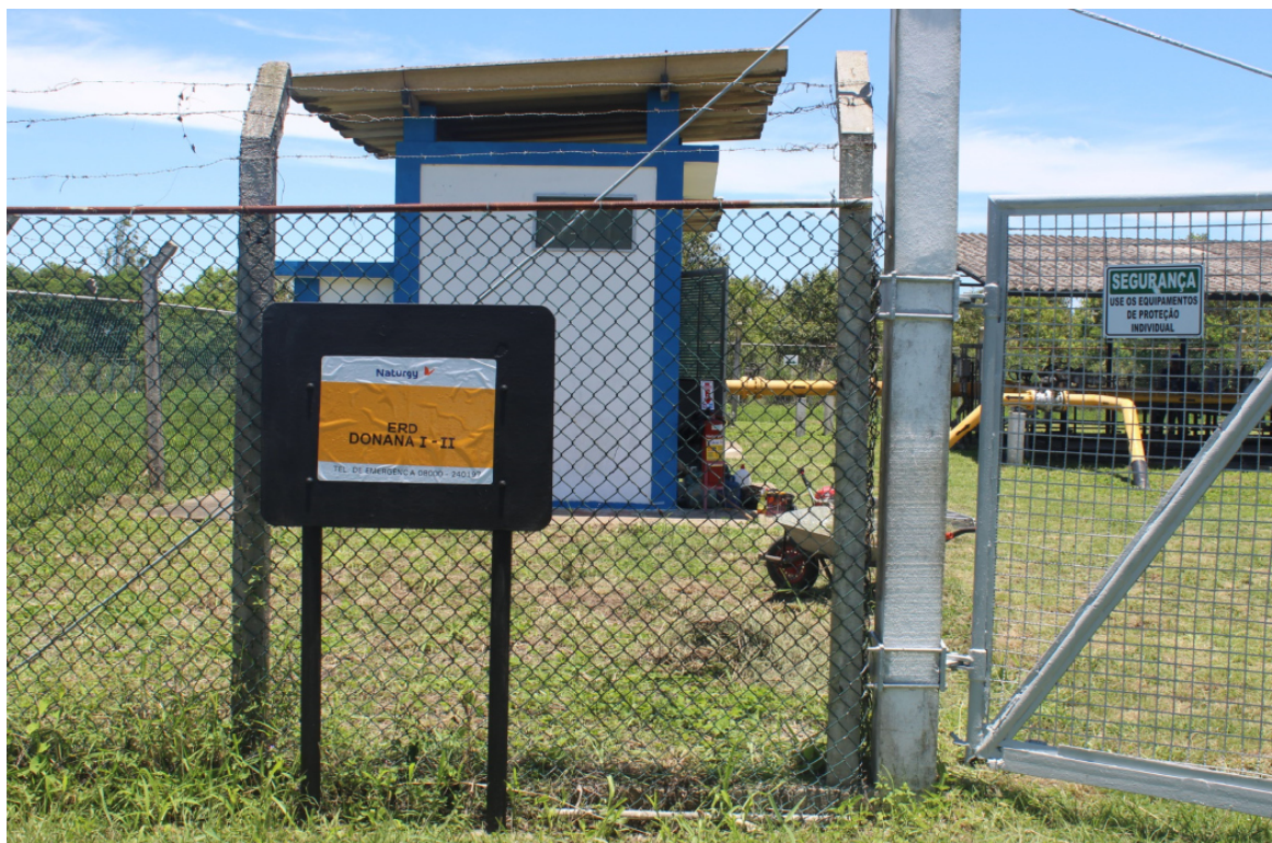
Foto 1: Placa de identificação da Estação
