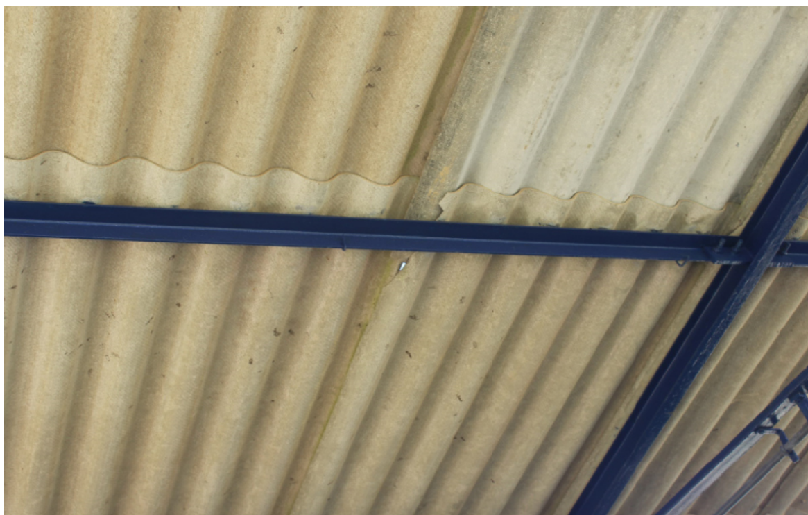
Foto 12: Furo no telhado
