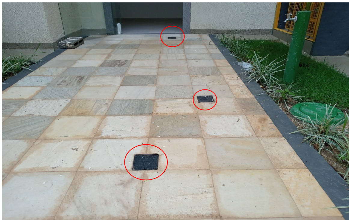
Foto 12: Válvulas de bloqueio dos ramais
