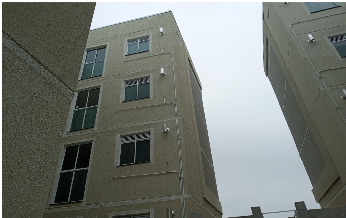
Foto 8: Ramais dos apartamentos e chaminés
