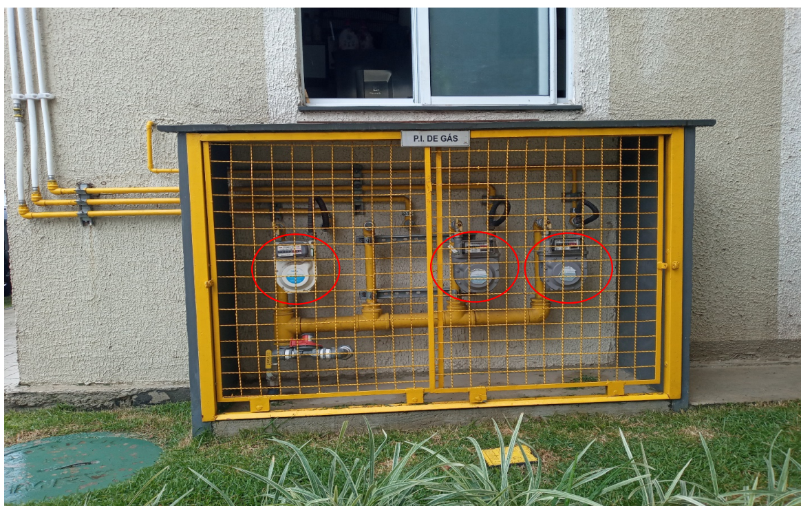
Foto 4: Abrigo de PI (externo) - medidores
