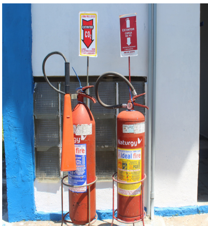
Foto 10: Extintores de incêndio
