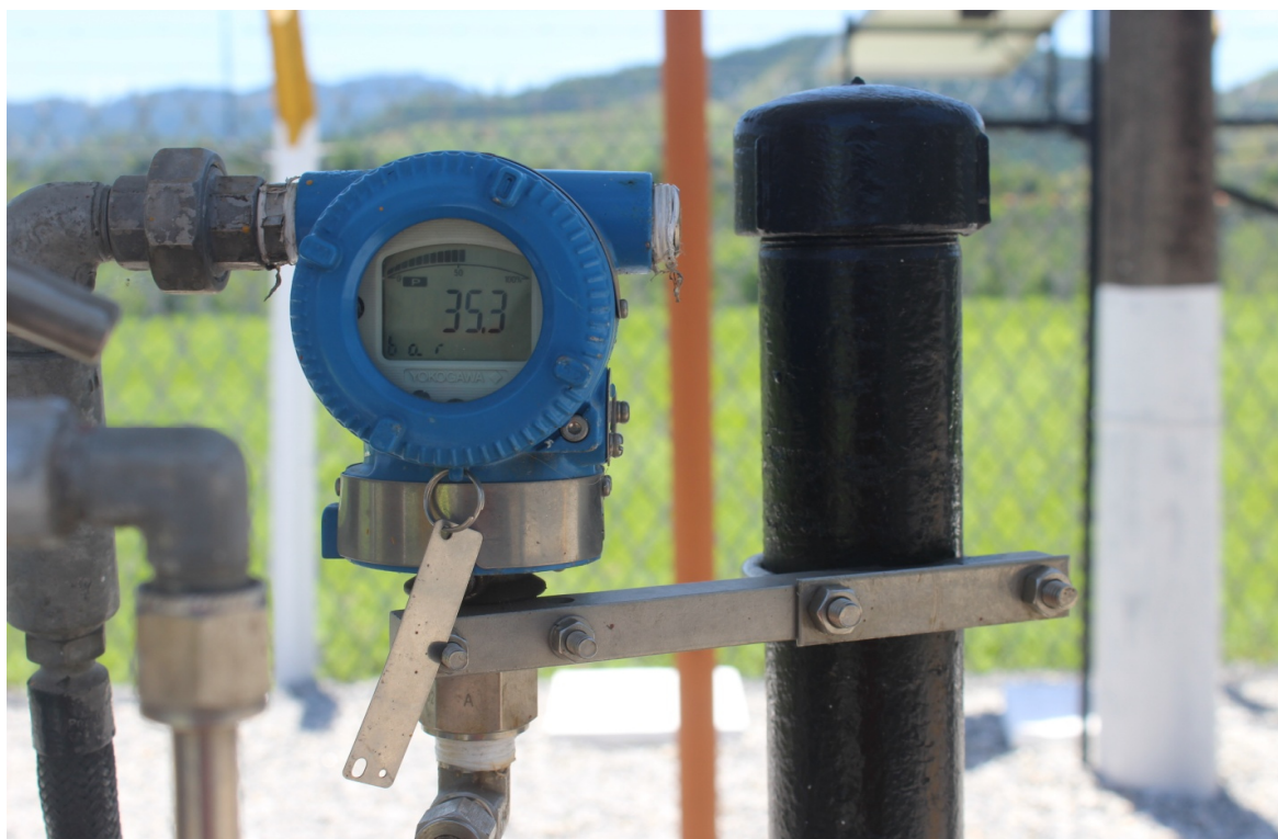
Foto 6: Indicação da pressão de entrada
