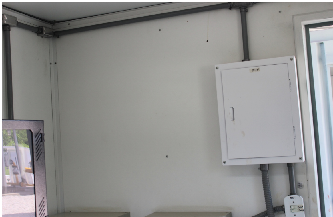
Foto 16: Sala de controle (painel elétrico sem sinalização de segurança)
