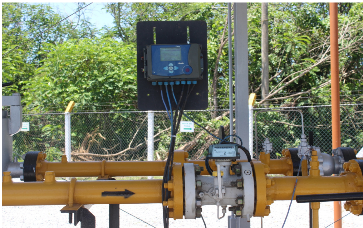
Foto 9: Medidor de vazão e conversor de volume
