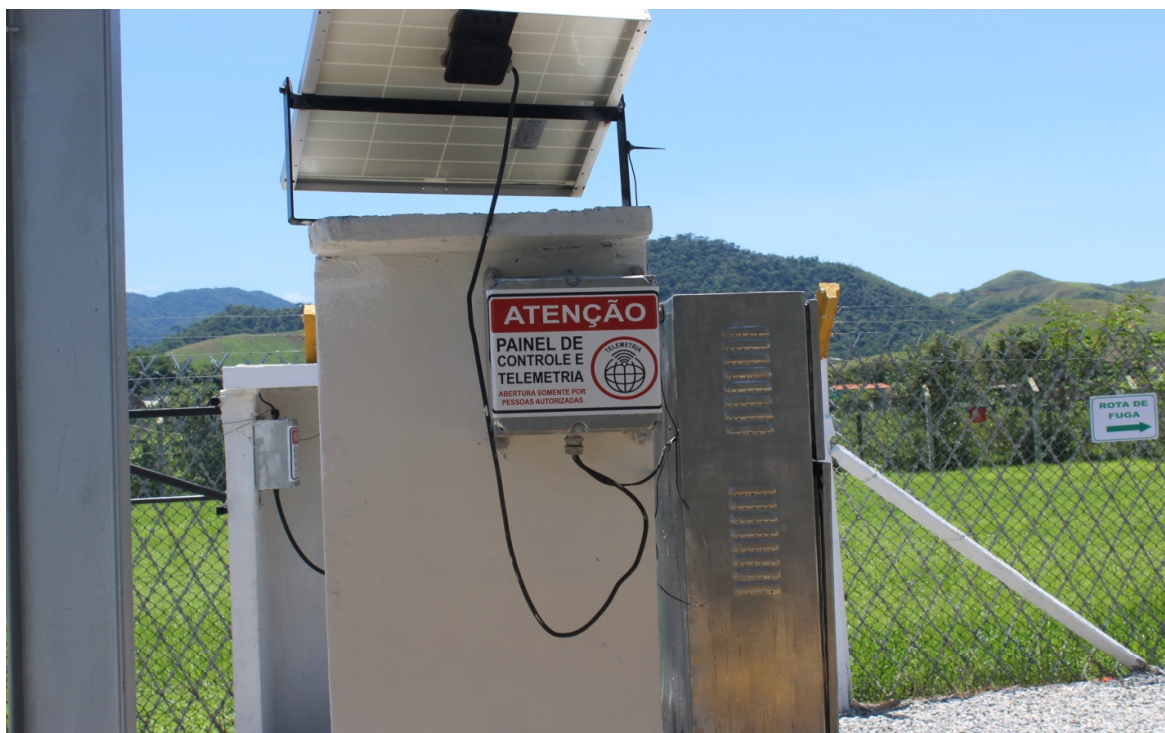
Foto 17: Pannel fotovoltaico para alimentação do sistema de telemetria
