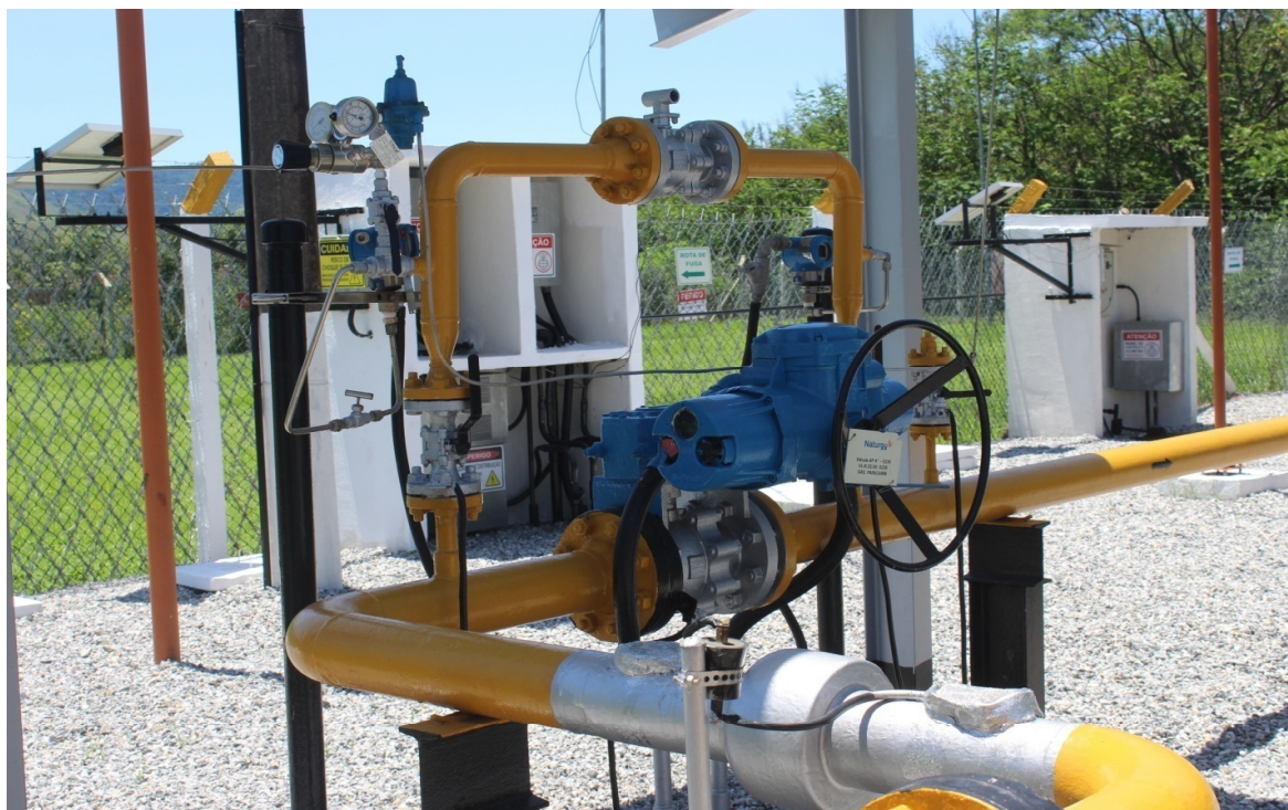
Foto 5: Tubulação de entrada (Válvula telecomandada)
