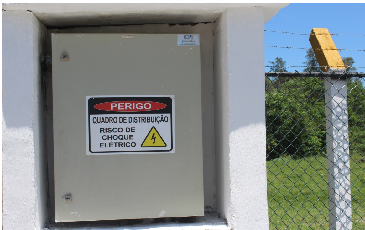
Foto 18: Quadro de distribuição de energia elétrica
