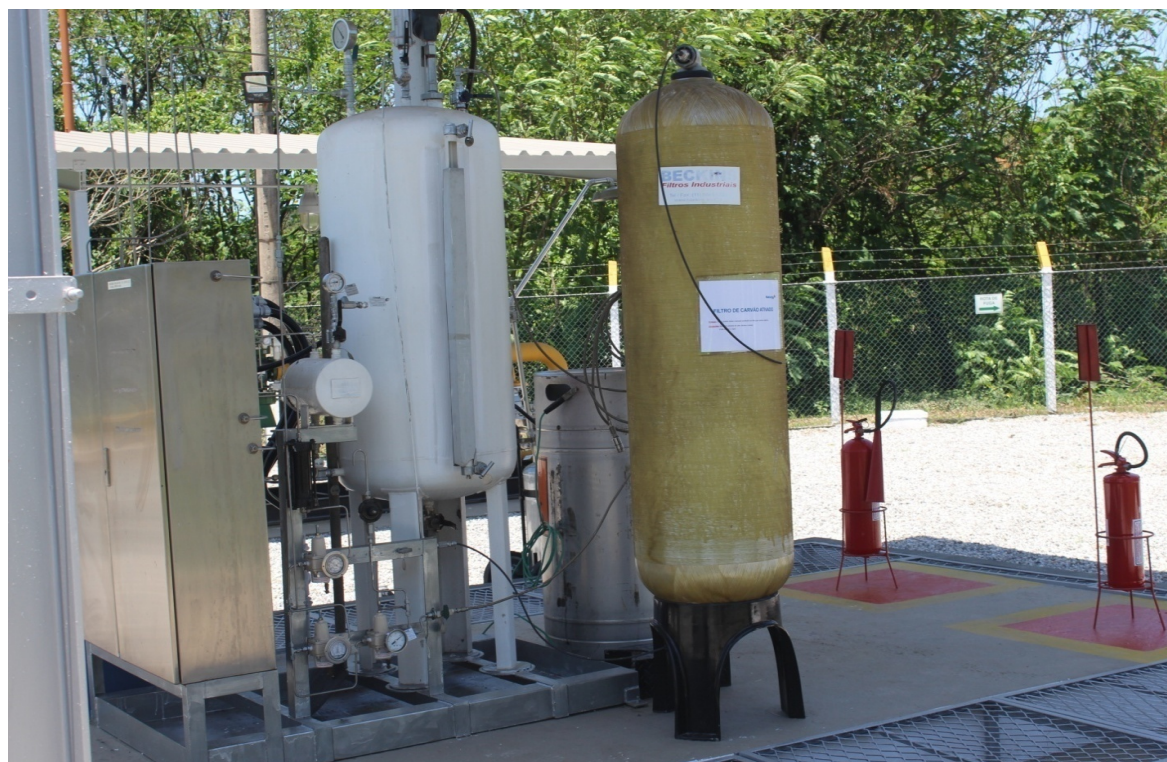
Foto 12: Estação de odorização
