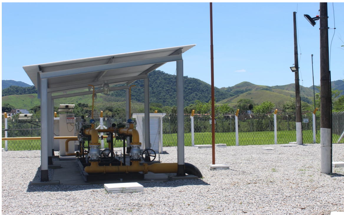
Foto 11: Estação de medição e regulação
