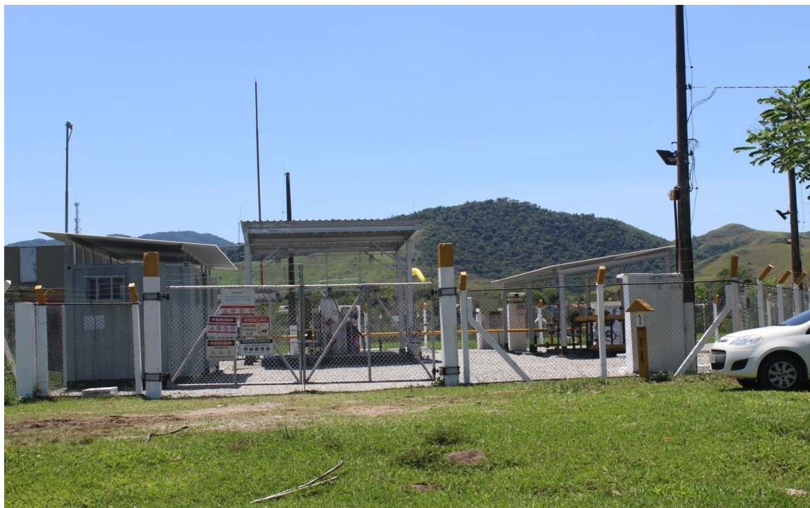
Foto 3: Visão geral da estação
