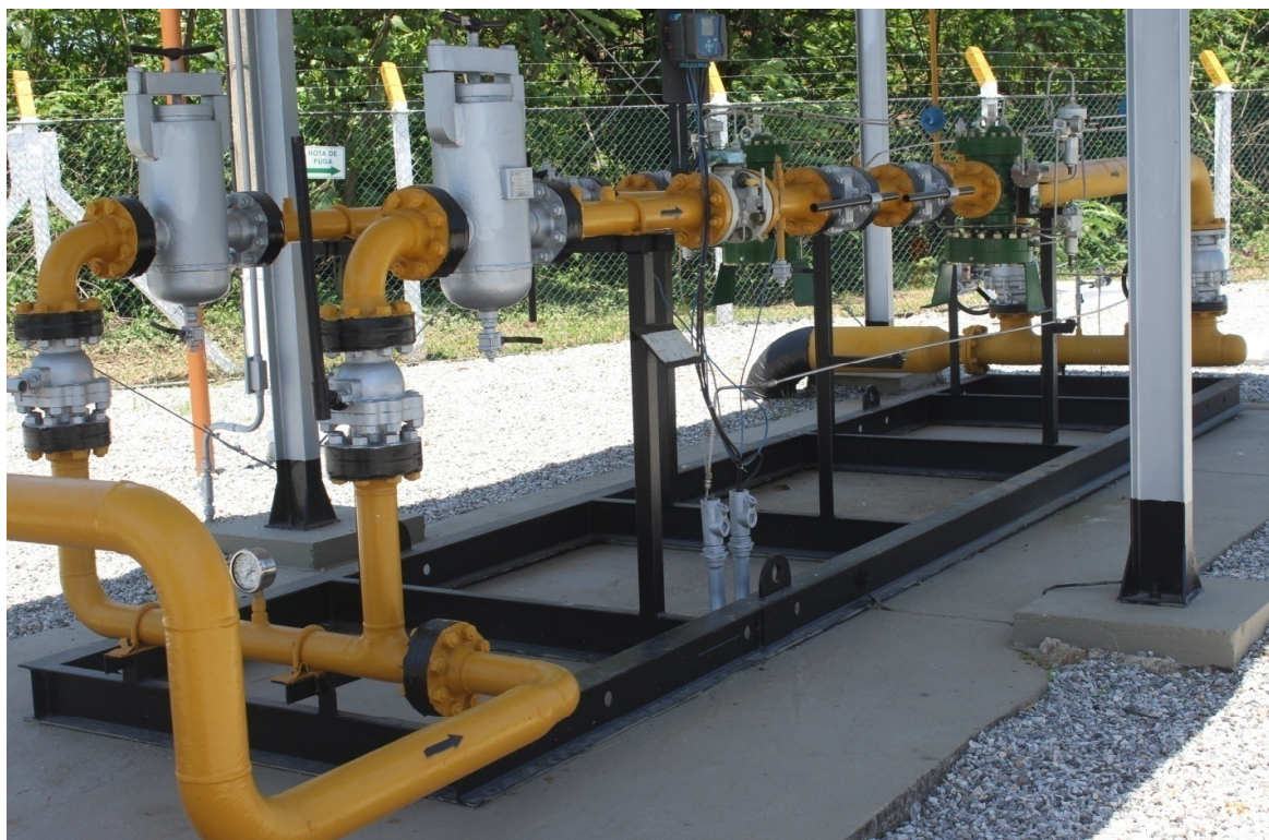
Foto 7: Estação de Medição e Regulagem
