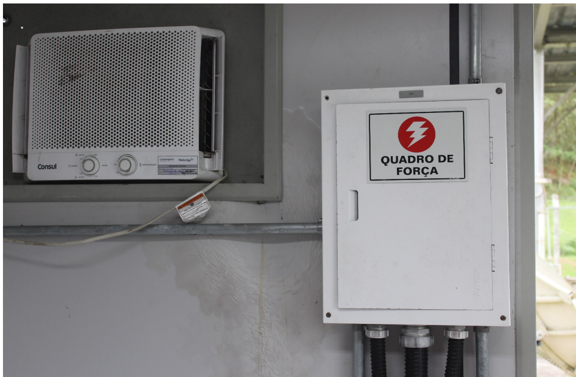
Foto 18: Quadro de distribuição
