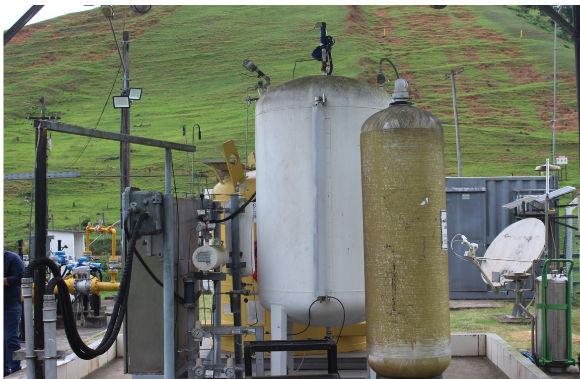
Foto 12: Estacao de odorizacao (tanque de armazenamento em mau estado de conservacao)
