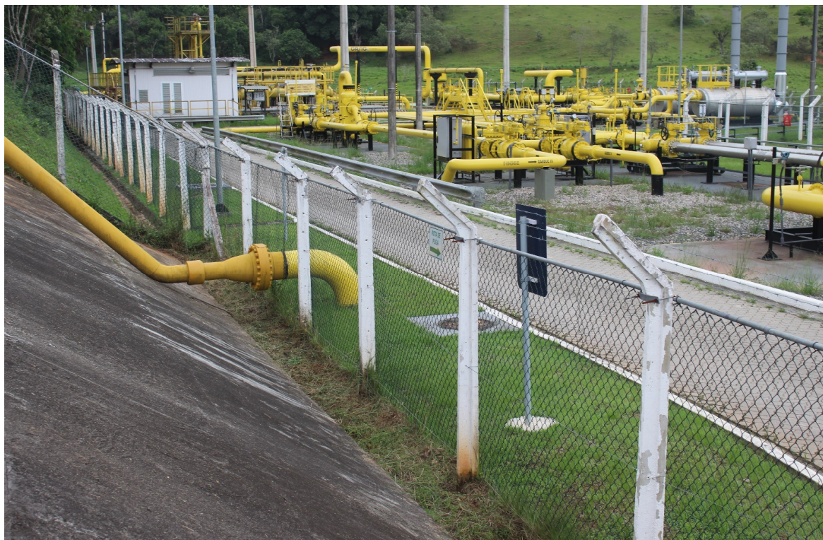
Foto 4: Tubulação de entrada de gás a partir do ponto de entrega NTS
