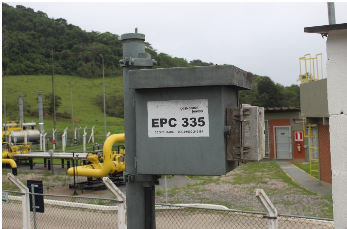
Foto 10: Sistema de Proteção Catódica (Retificador) em mau estado de conservação
