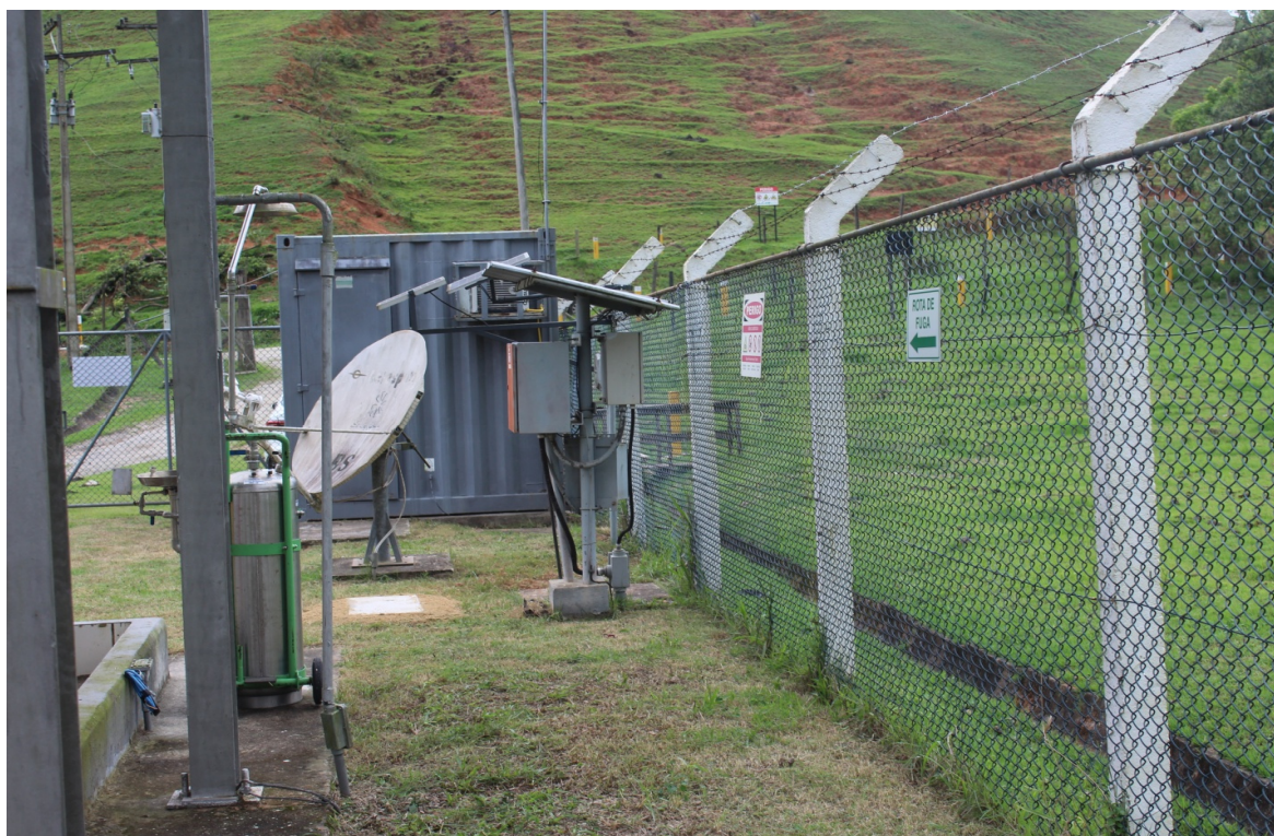
Foto 16: Sala de controle, antena e painel fotovoltaico
