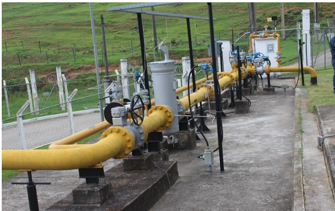
Foto 5: Estação de medição
