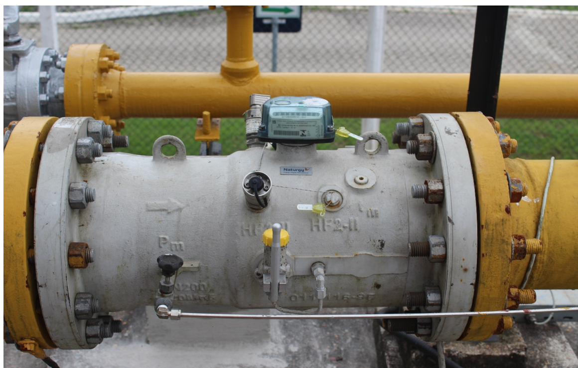
Foto 8: Medidor de vazão - Turbina ETC
