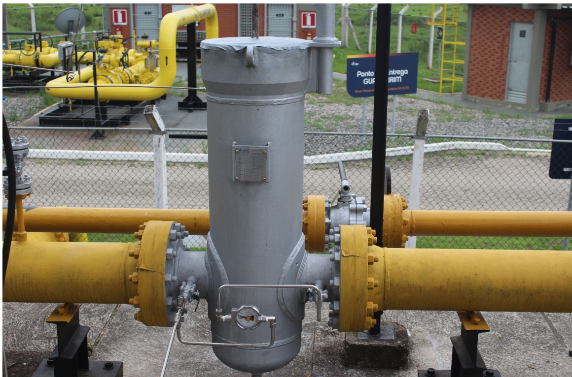
Foto 7: Filtro com manômetro diferencial de pressão
