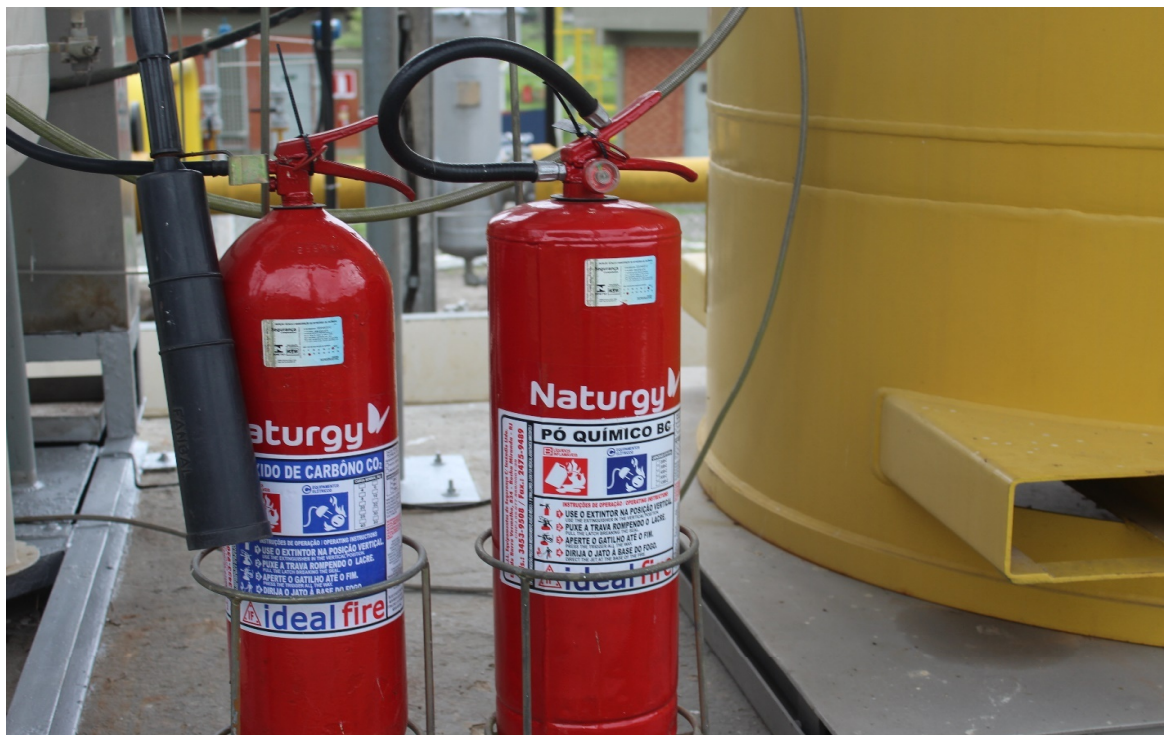
Foto 19: Extintores: CO2 e PQS
