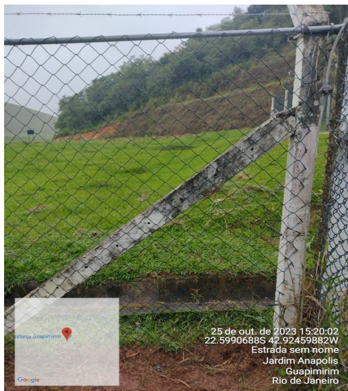
Foto 26: Melhoria realizada na conservação da cerca
