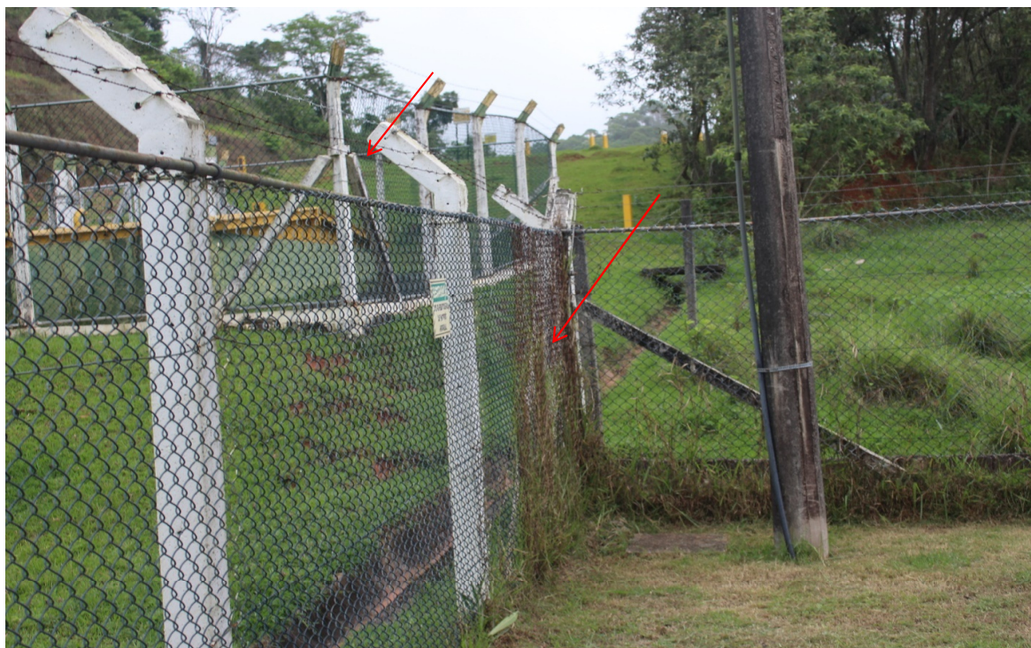
Foto 15: Parte da cerca em mau estado de conservação
