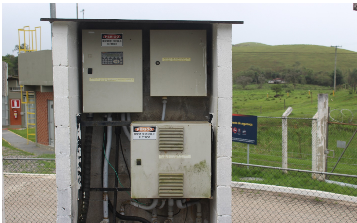
Foto 11: Paineleletrico em mau estado de conservacao
