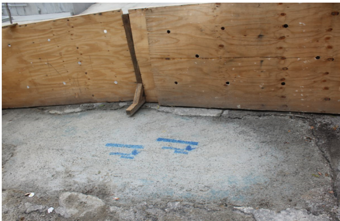
Foto 3: Isolamento de recomposição provisória
