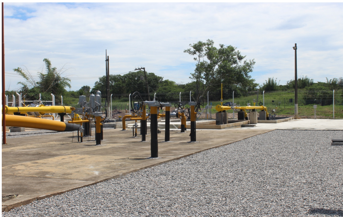
Foto 19: Dispositivos para manobra de válvulas subterrâneas
