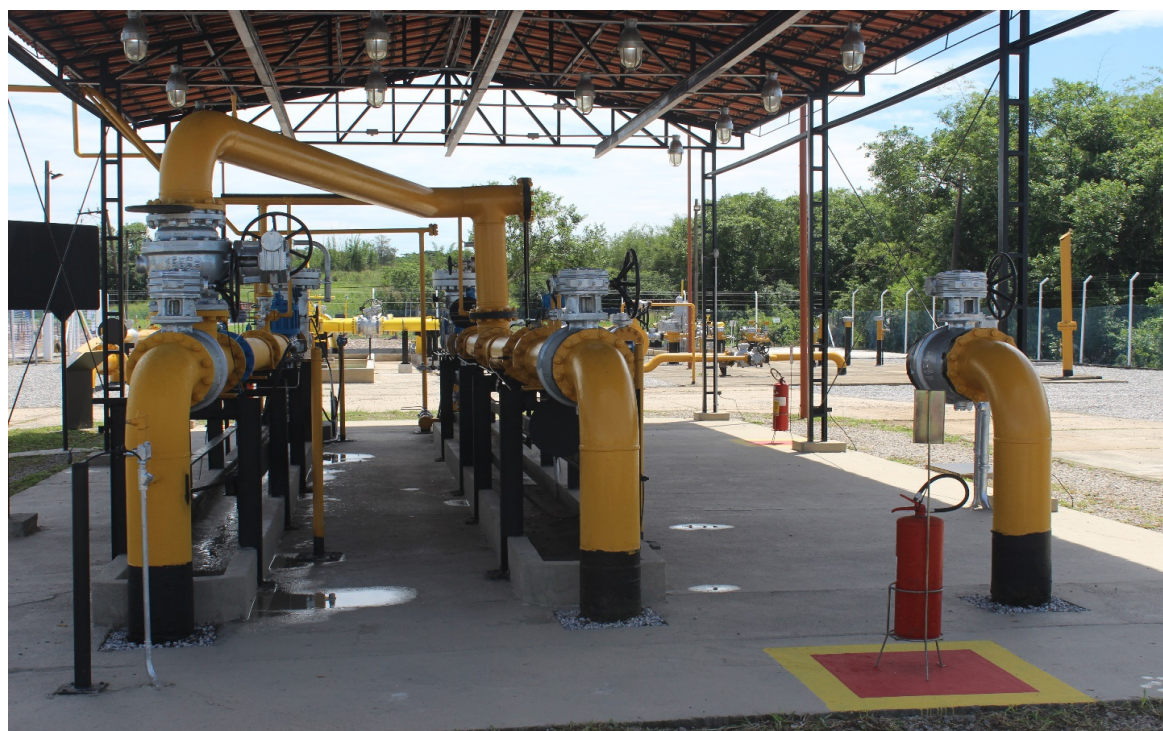
Foto 8: Tubulação de saída (Pressão - 12 bar)
