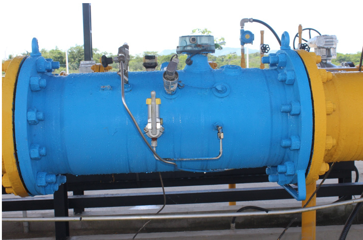
Foto 7: Medidor de vazão - Turbina
