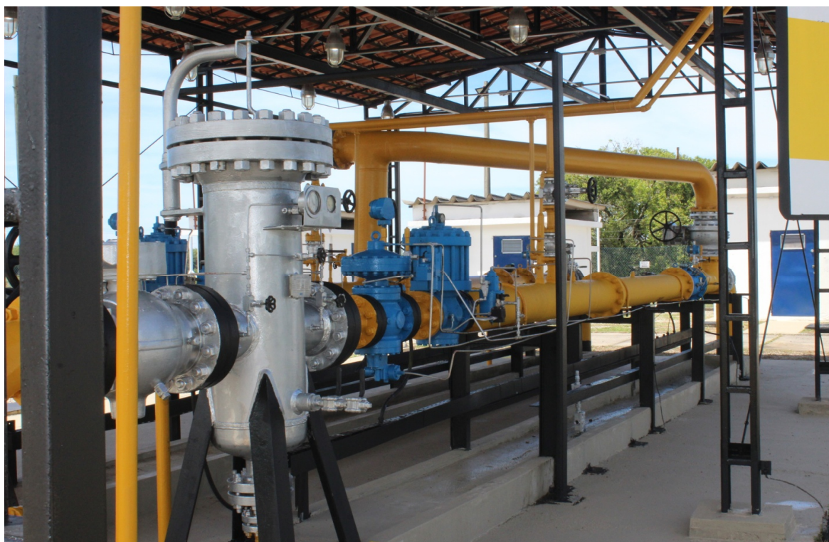
Foto 4: Válvula, filtro, regulador e medidor
