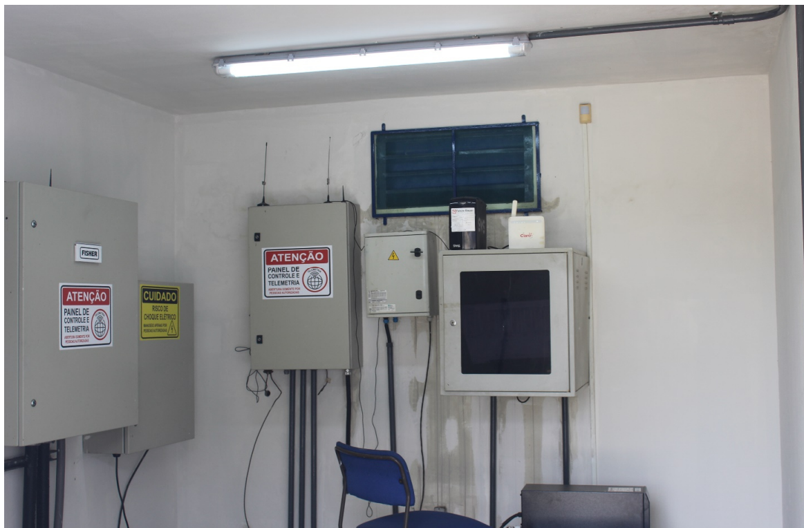
Foto 14: Sala de Controle
