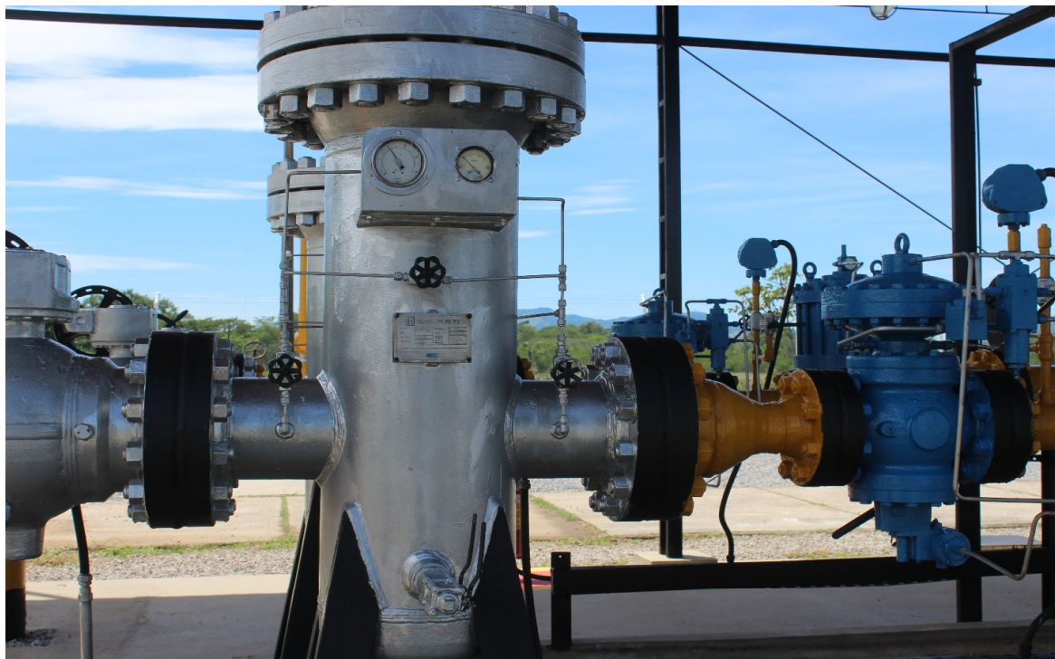
Foto 5: Filtro com manômetro diferencial de pressão
