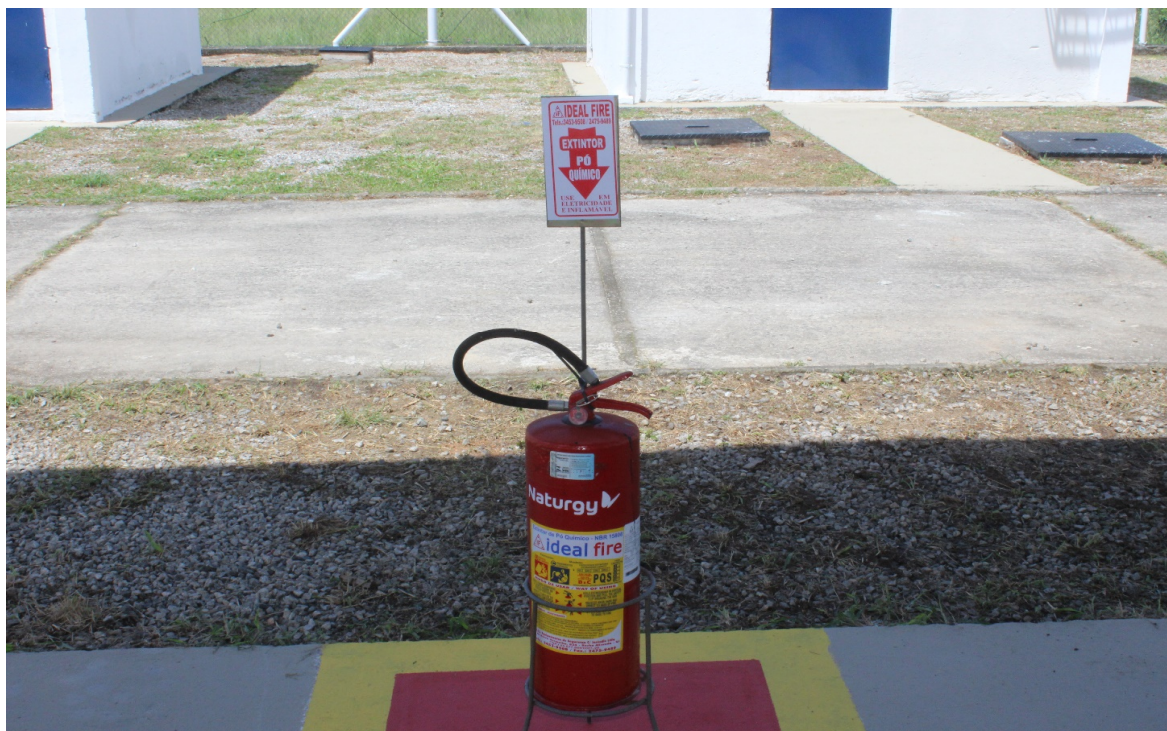
Foto 11: Extintor de PQS
