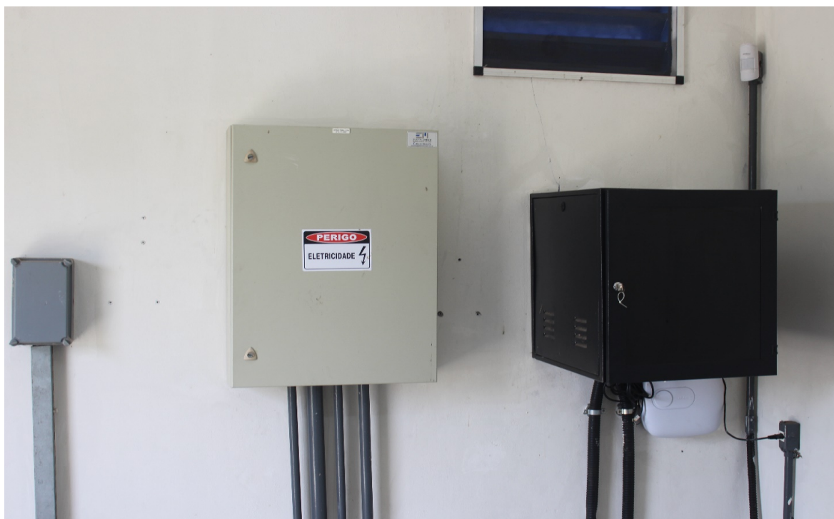
Foto 15: Sala elétrica e sistema de monitoramento por câmera
