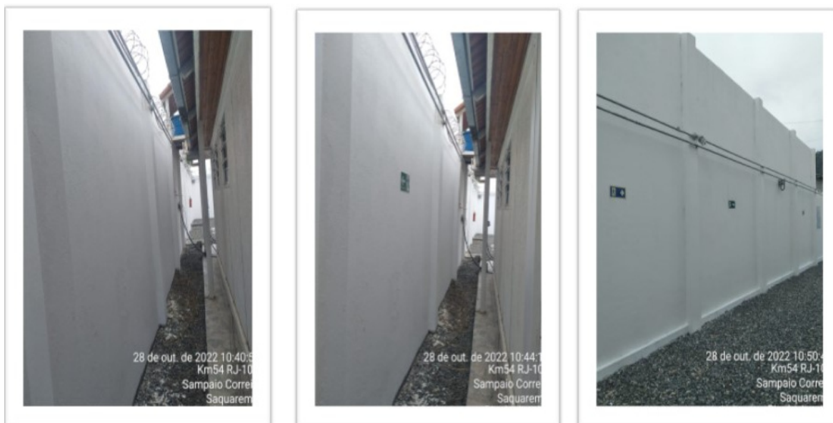
Foto 17: Placas de rota de fuga (antes e depois)
