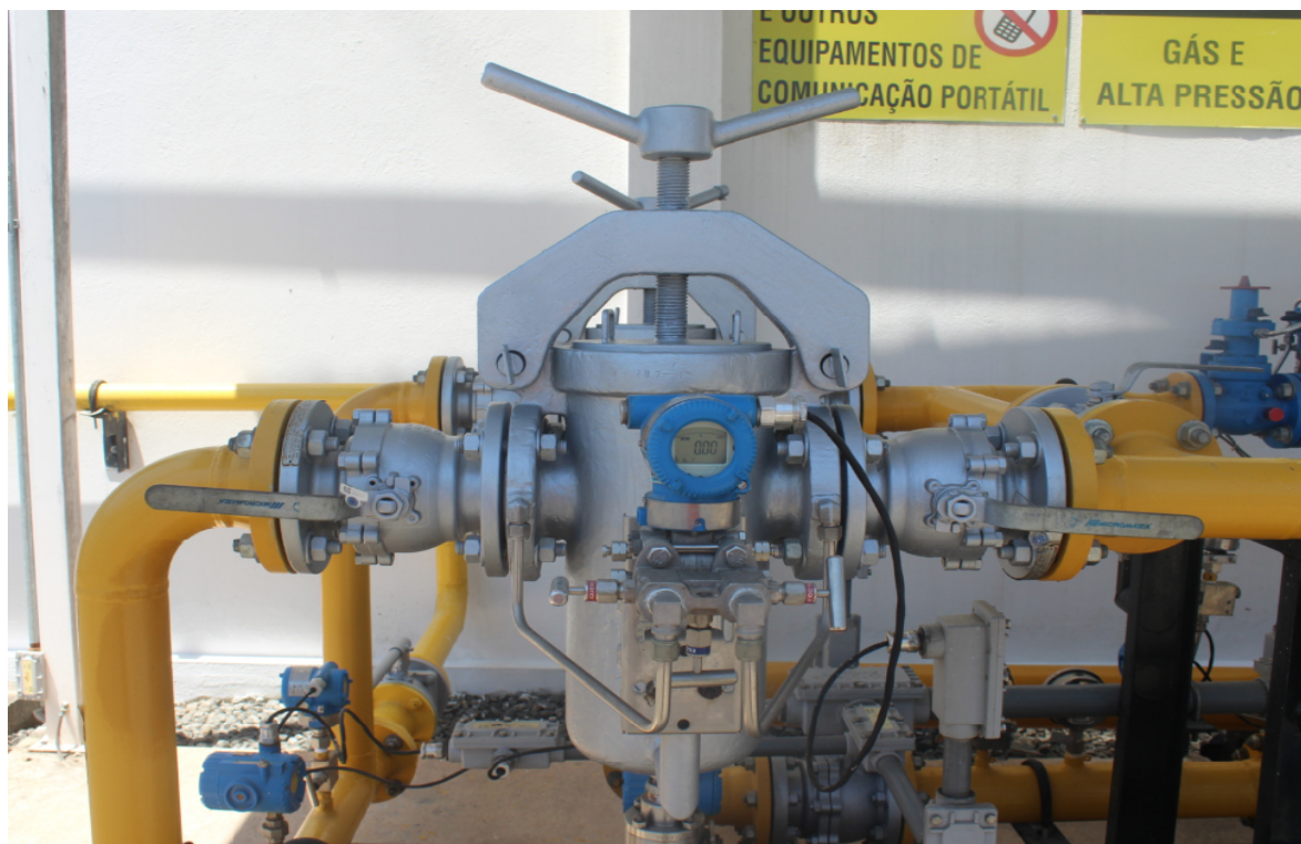
Foto 5: Filtro de gás limpo
