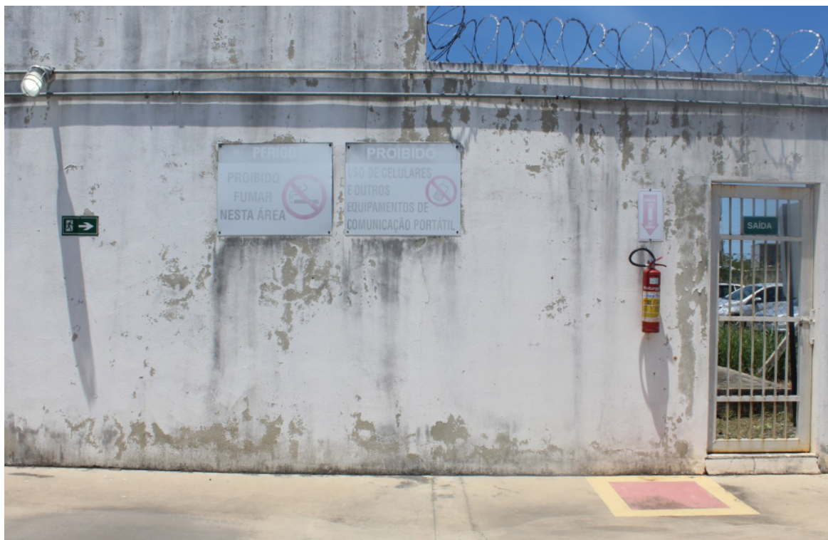
Foto 9: Sinalização de segurança (antes)
