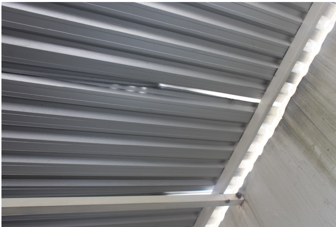
Foto 14: Telhado com buraco e colmeias de marimbondos (antes)
