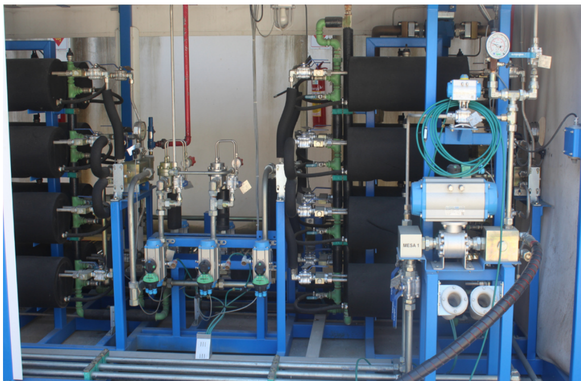
Foto 3: RCU - trocadores de calor e reguladores
