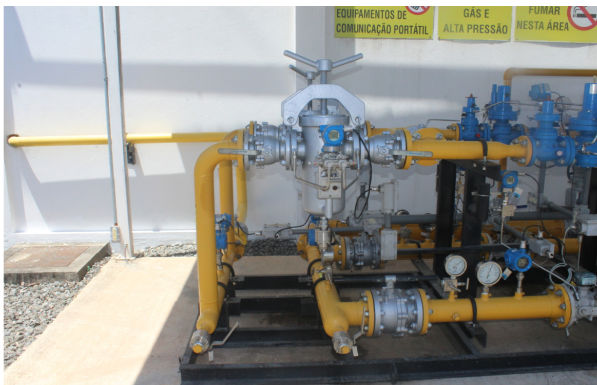
Foto 4: Estação de regulação - entrada de gás
