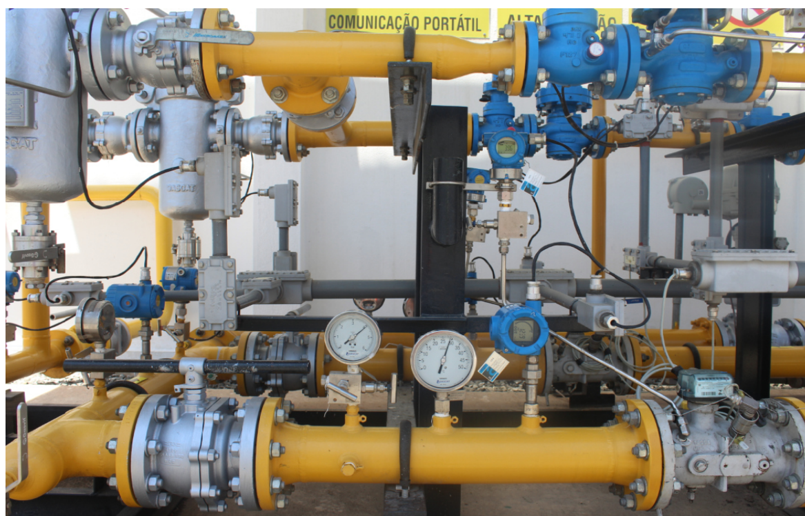
Foto 6: Medidores de pressão e temperatura
