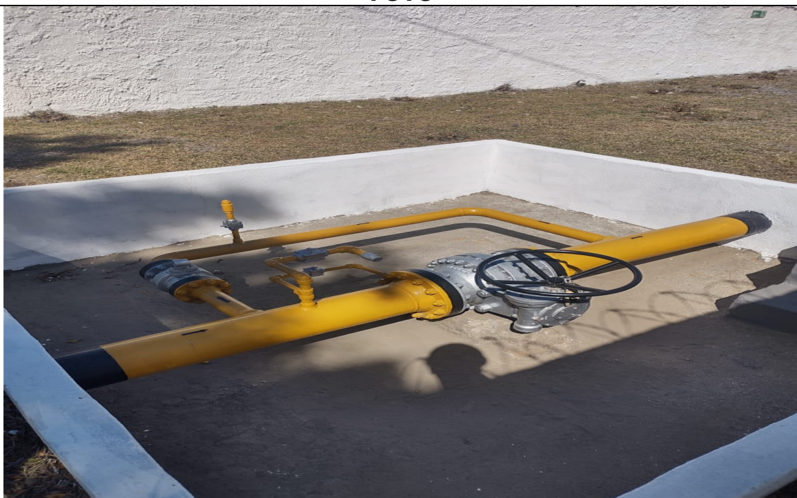
Foto 6: Válvula de linha e duto de aço 8".
