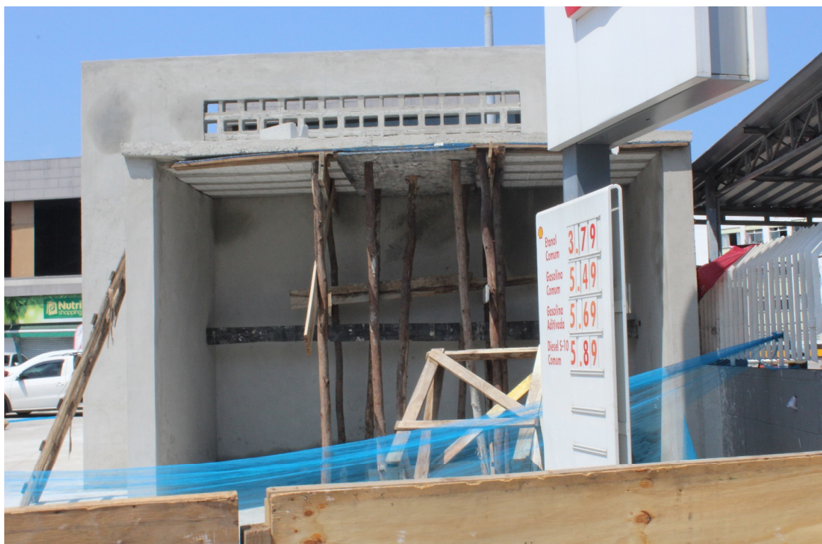
Foto 5: Futura Estação de Regulagem e Medição do posto
