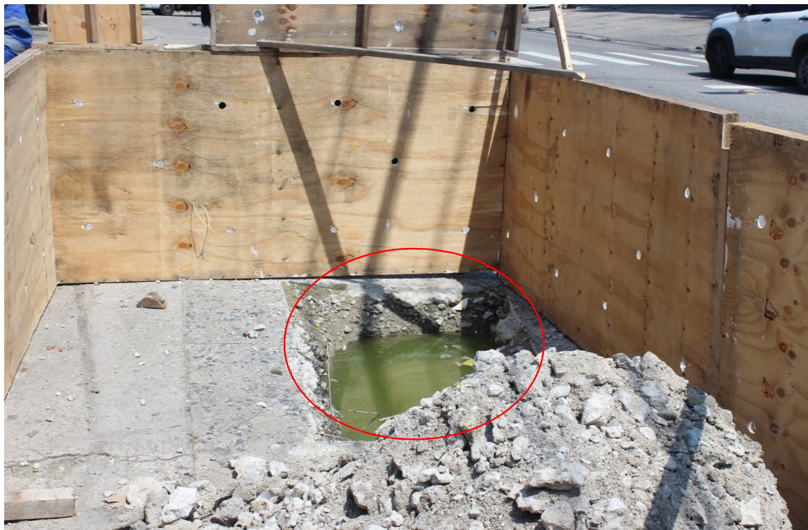
Foto 3: Água acumulada em vala aberta
