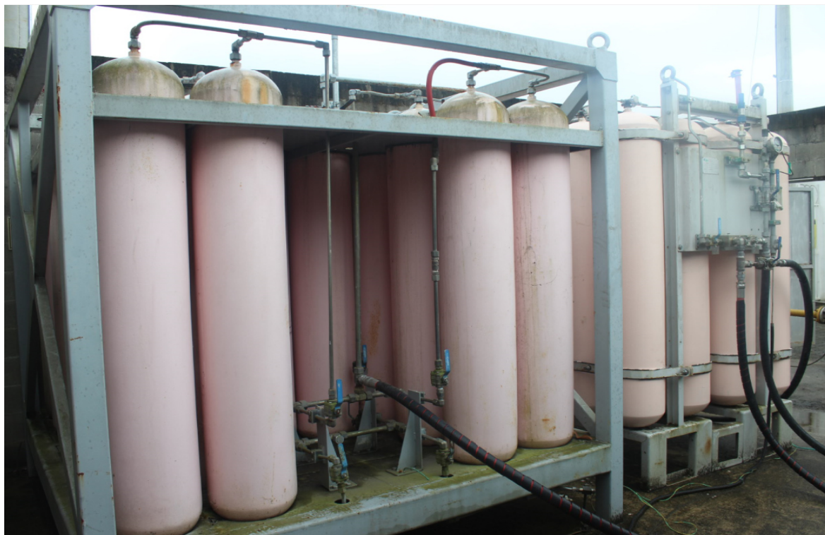
Foto 3: Transferência entre cilindros de armazenamento e RCU
