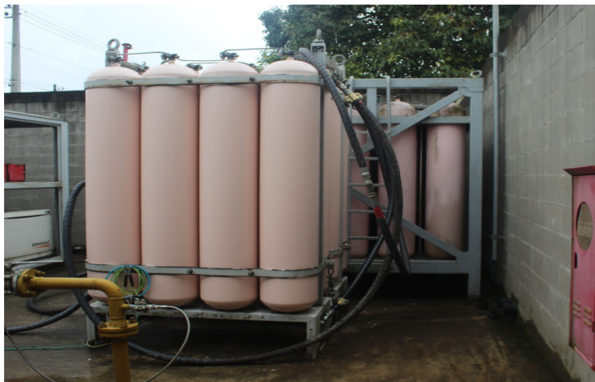
Foto 2: Cilindros de armazenamento
