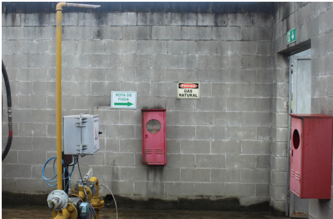
Foto 7: Extintores de incêndio e sinalização de segurança
