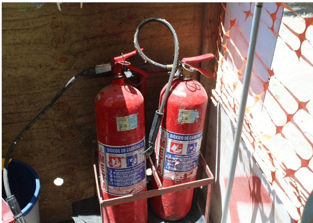
Foto 13: Extintor LE com mangueira danificada e LD sem difusor e etiquetas ilegíveis
