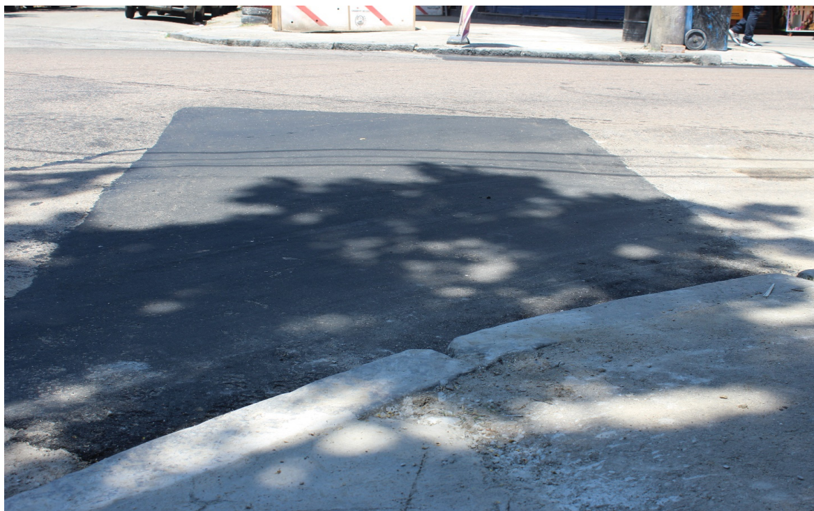
Foto 10: Ponto de interligação da rede (lado par)
