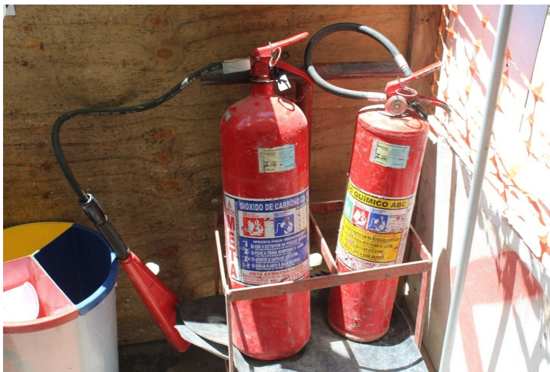
Foto 14: Extintor CO2 com mangueira danificada e PQS substituído
