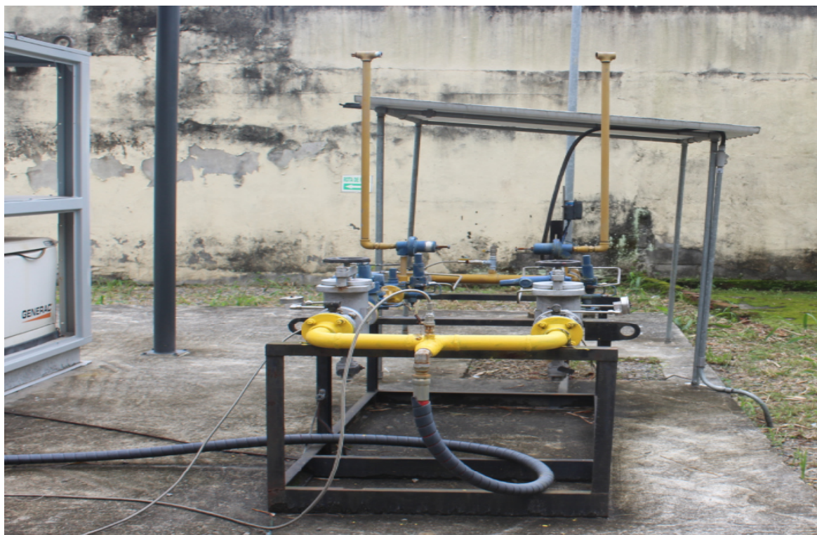
Foto 5: Transferência de RCU para a estação de regulação
