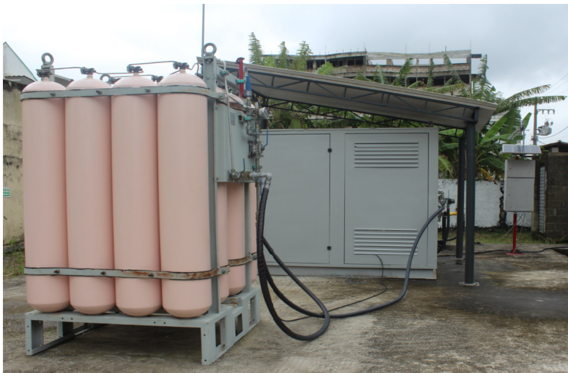
Foto 3: Transferência entre cilindros de armazenamento e RCU
