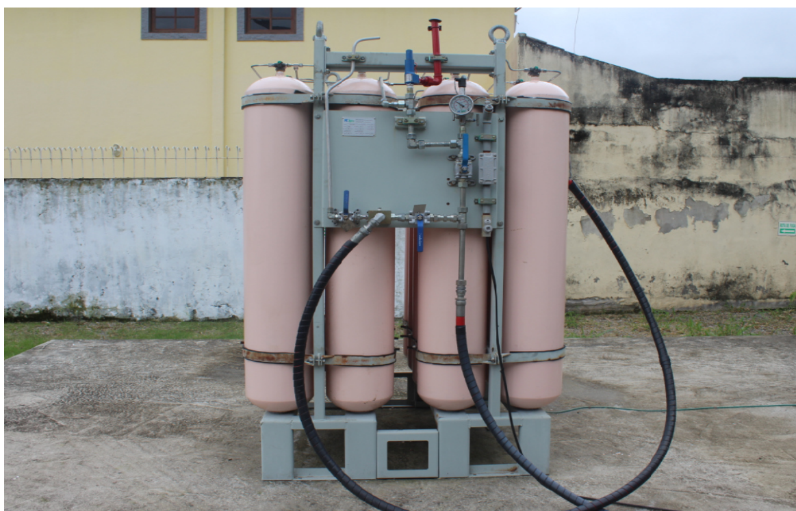
Foto 2: Cilindros de armazenamento
