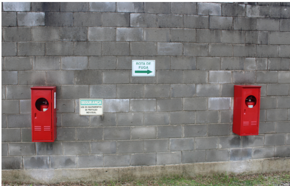
Foto 8: Extintores de incêndio e sinalização de segurança
