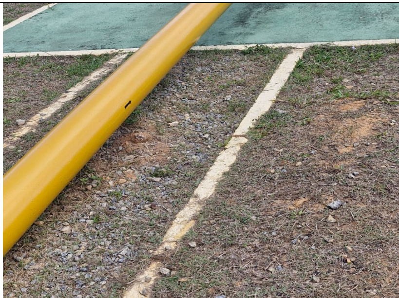
Foto 2: Duto, com sentido do fluxo destacado, na entrada da área.
