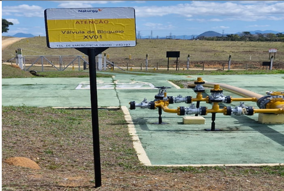
Foto 3: Placa de identificação no interior da área, para diferenciar do trecho compartilhado com a Petrobras. Válvula à direita.
