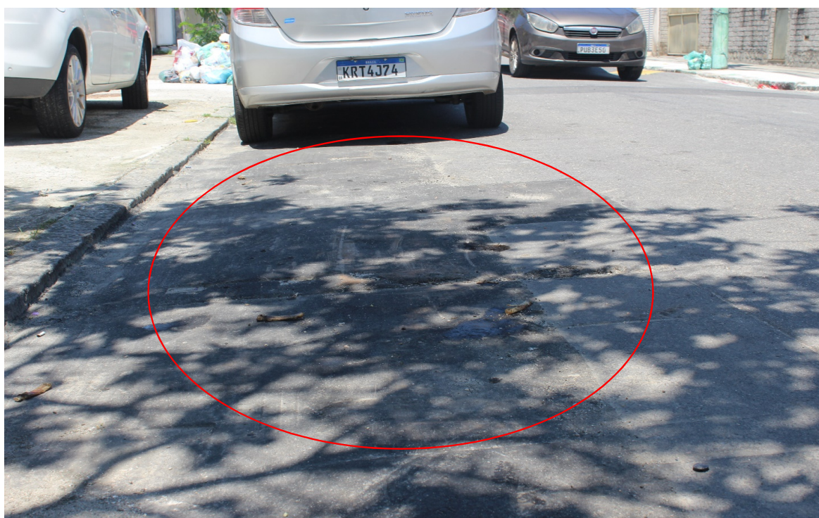
Foto 4: Ausência de indicação de recomposição provisória (em frente ao nº 75)
