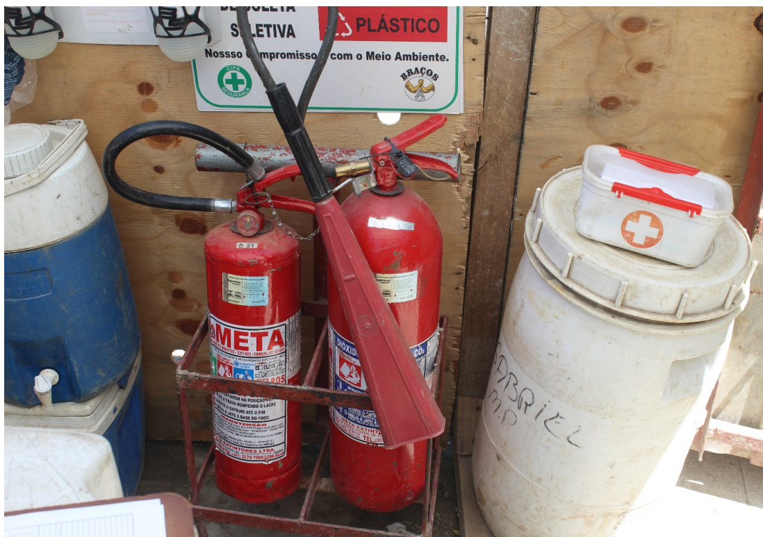
Foto 13: Extintor de PQS e CO2
