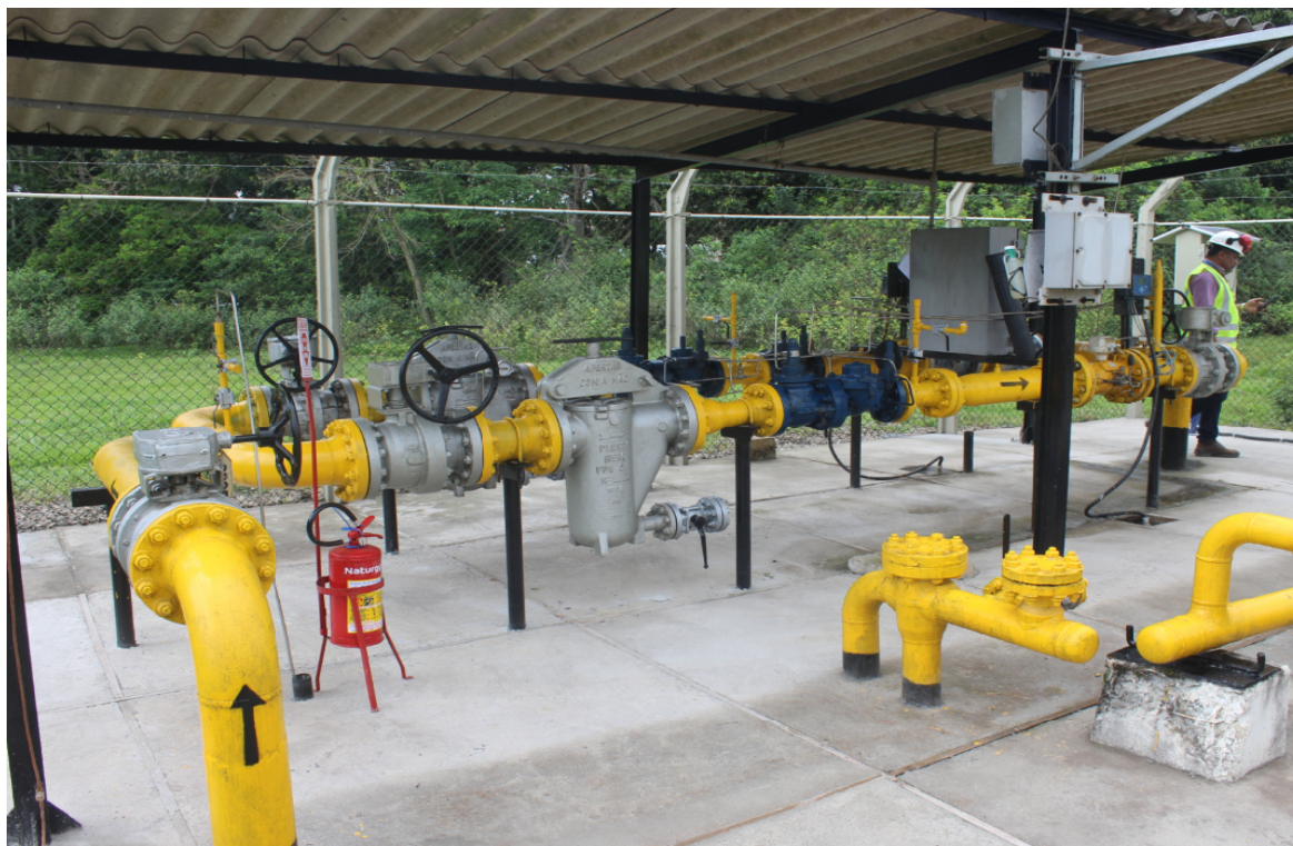
Foto 3: Estação de regulação e medição
