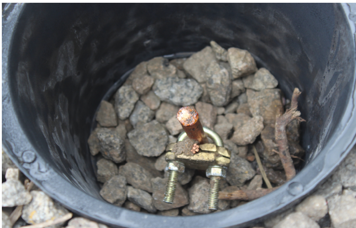
Foto 10: Aterramento em conformidade
