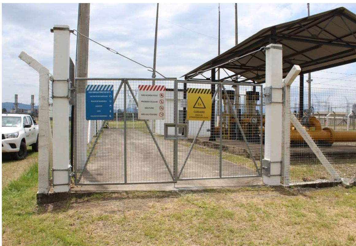
Foto 2: Acesso da Estação de medição.
