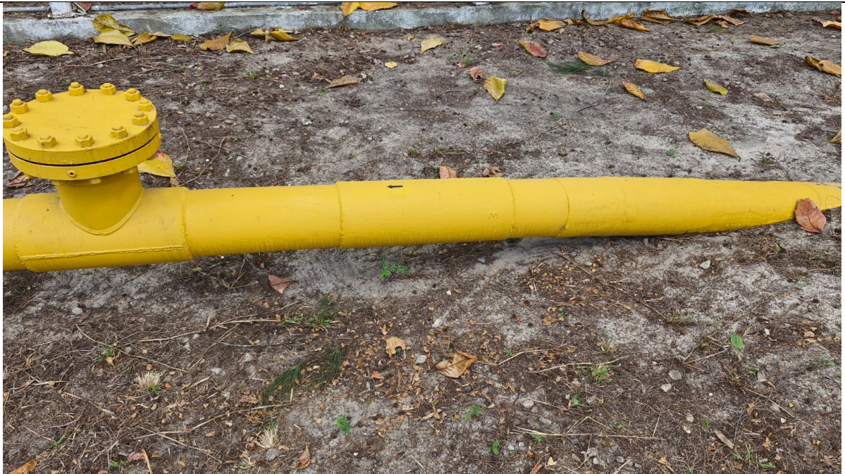
Foto 6: Entrada do duto na estação em destaque.
