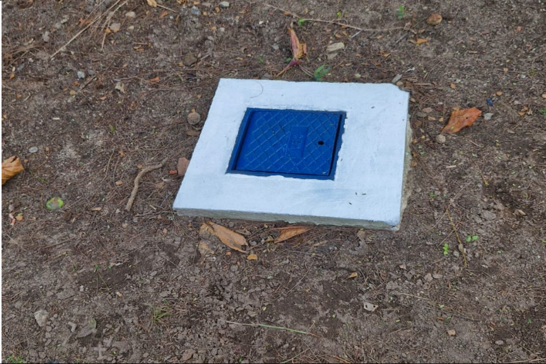
Foto 5: Proteção da tomada de potencial.
