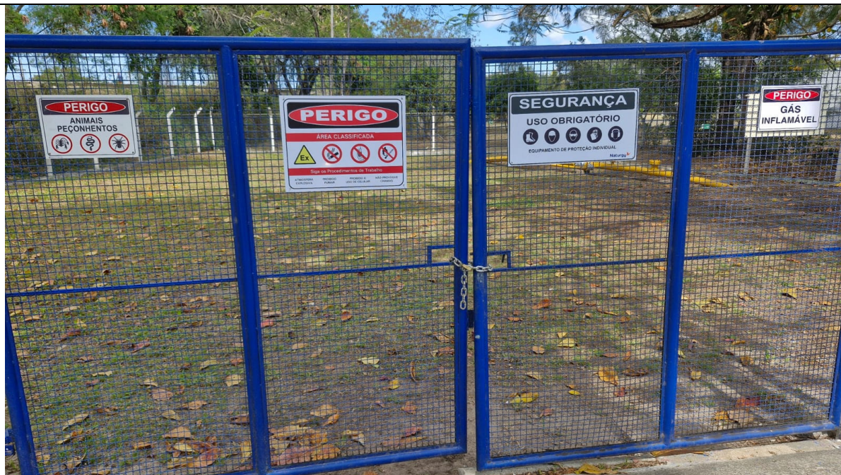
Foto 1: Vista da estação na entrada, com sinalização de perigo.
