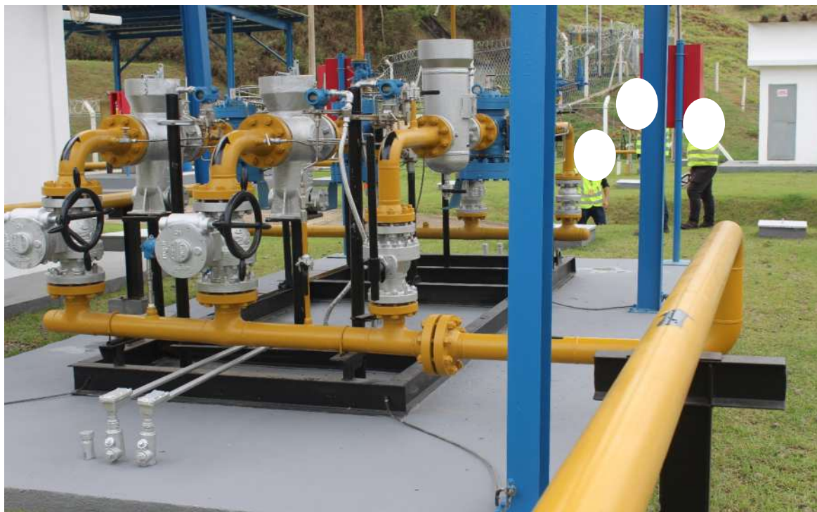
Foto 5: Estação de Regulação 1º corte (52 / 25 bar)
