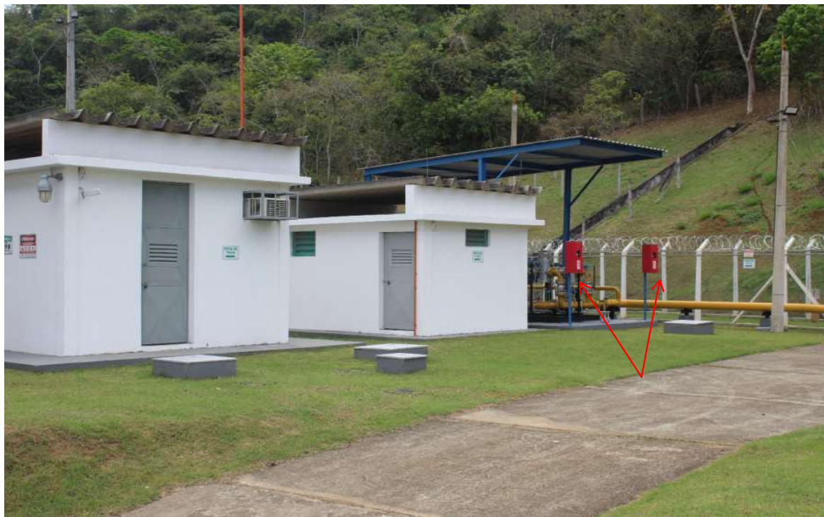
Foto25: Abrigo de extintor de incêndio
