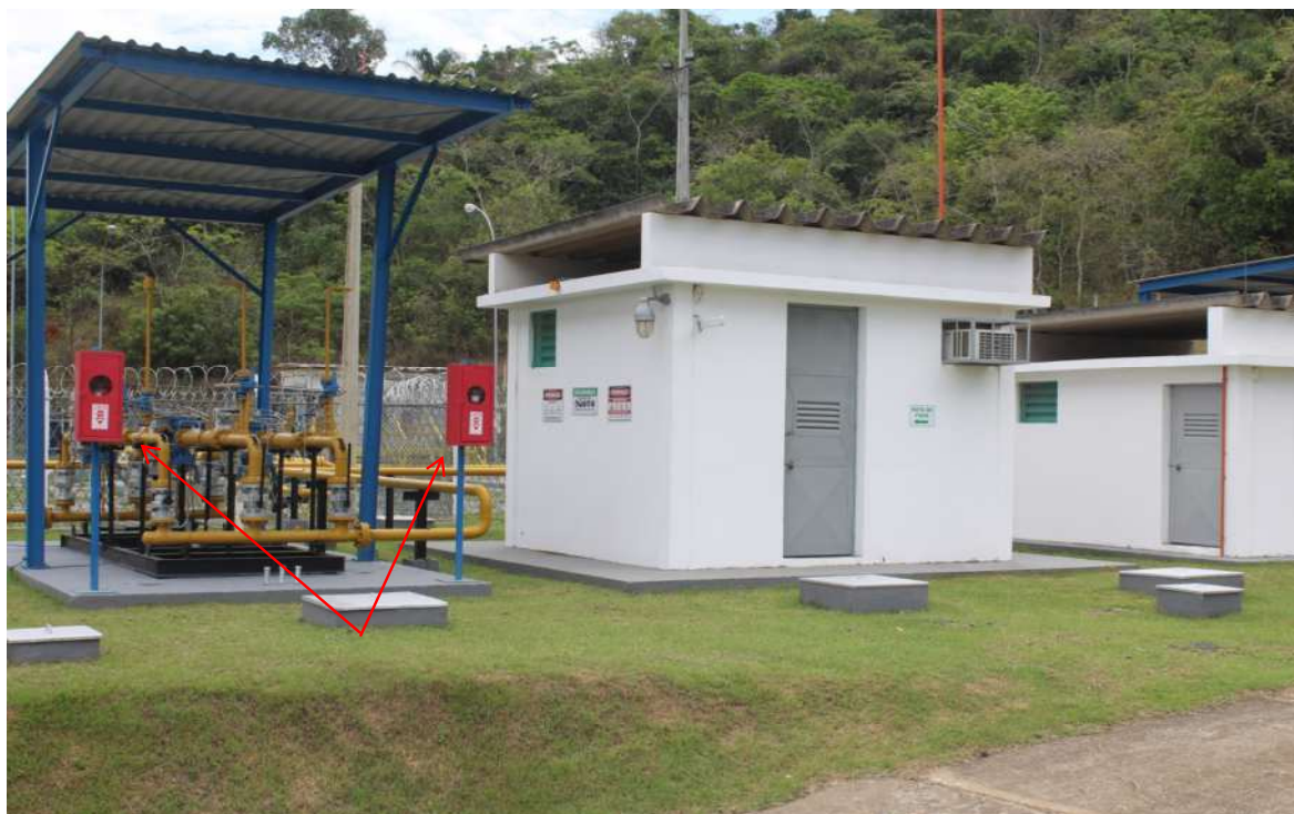
Foto 23: Abrigo de extintor de incêndio
