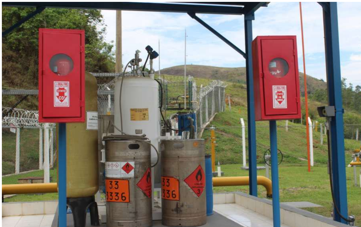
Foto 21: Abrigo de extintor de incêndio
