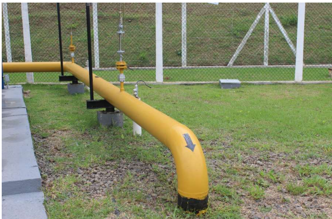
Foto 14: Tubulação de saída da estação (DN 8" - 16 bar)
