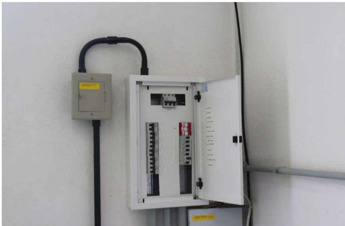
Foto 20: QGD - Quadro geral de distribuição
