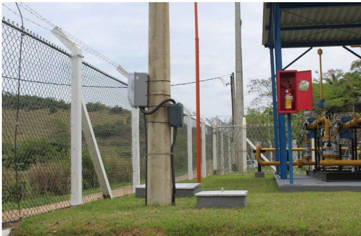
Foto 18: Entrada de energia elétrica
