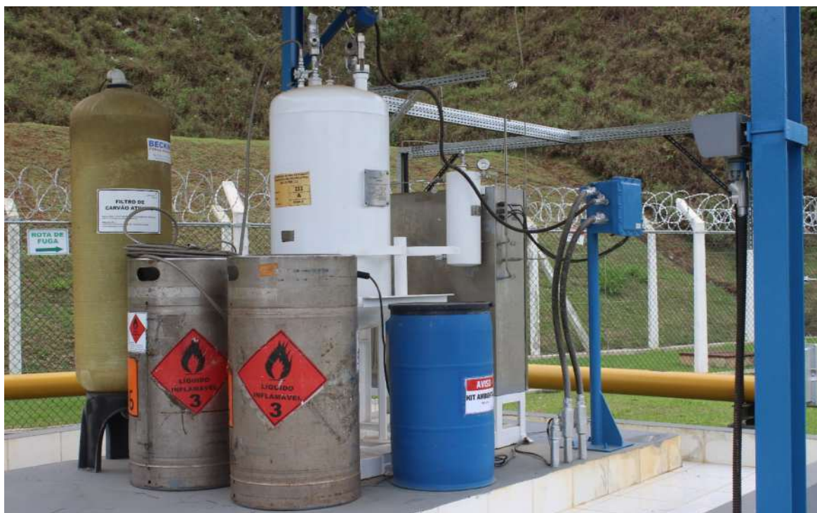
Foto 15: Estação de Odorização
