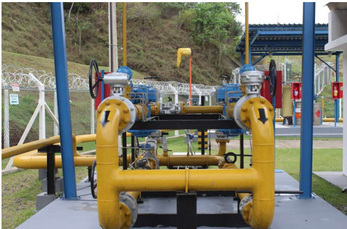
Foto 12: Tubulação de saída - 2º corte (DN 6" - 16 bar)
