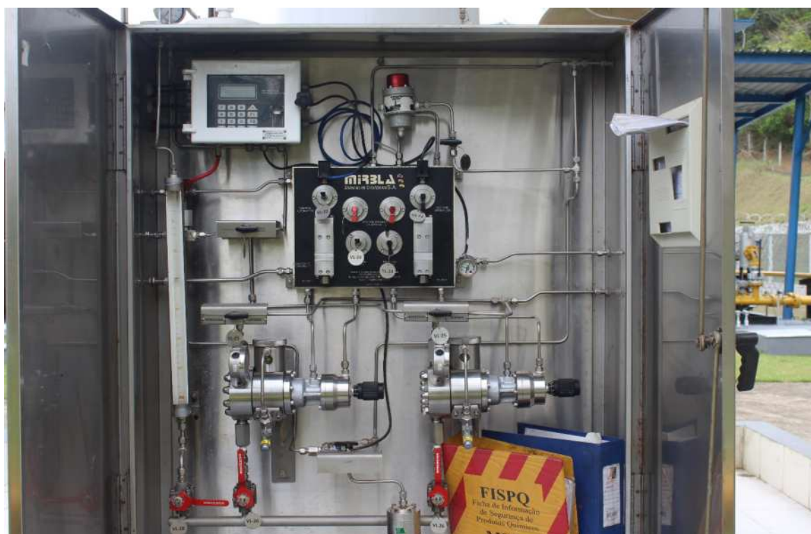
Foto 16: Equipamento de odorização
