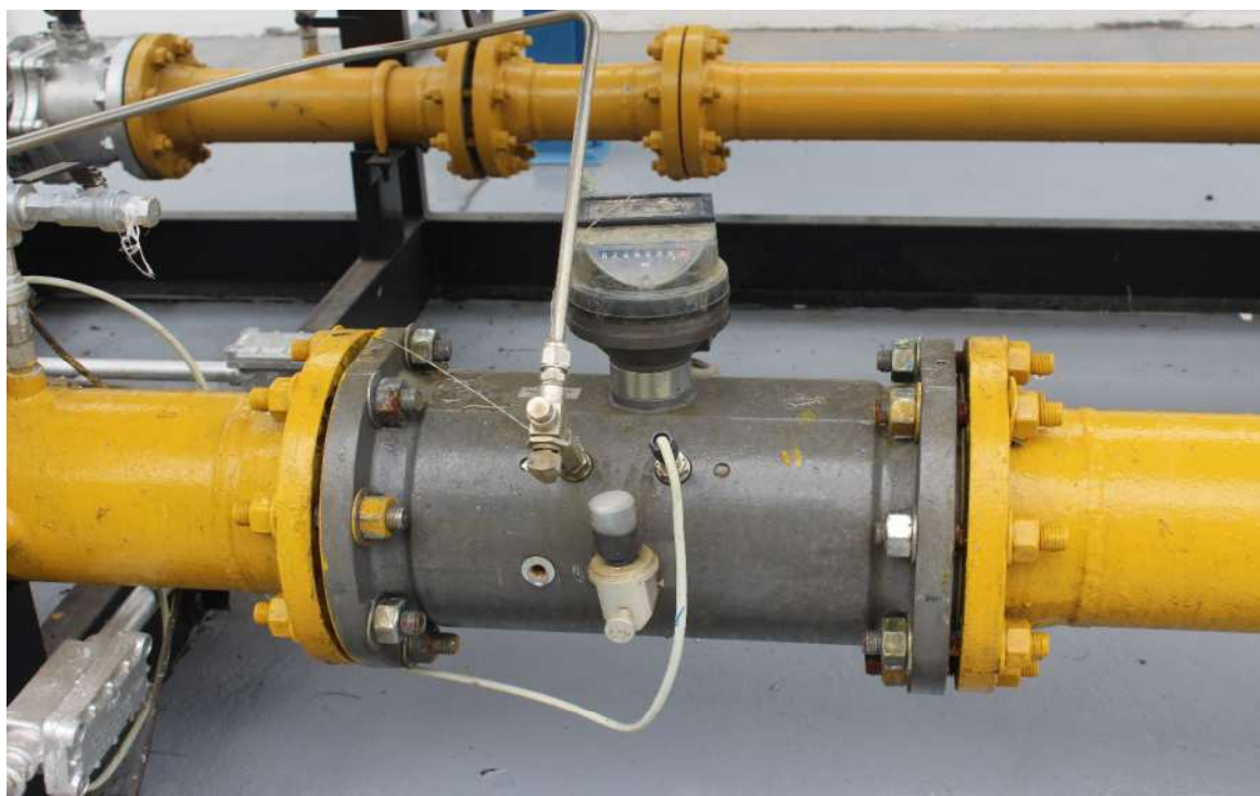
Foto 13: Medidor de vazão (Turbina)
