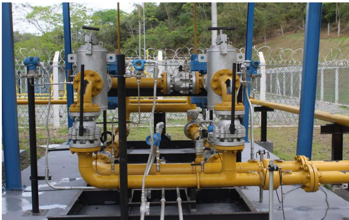
Foto 9: Estação de Regulação e Medição - 2º corte (25 / 16 bar)
