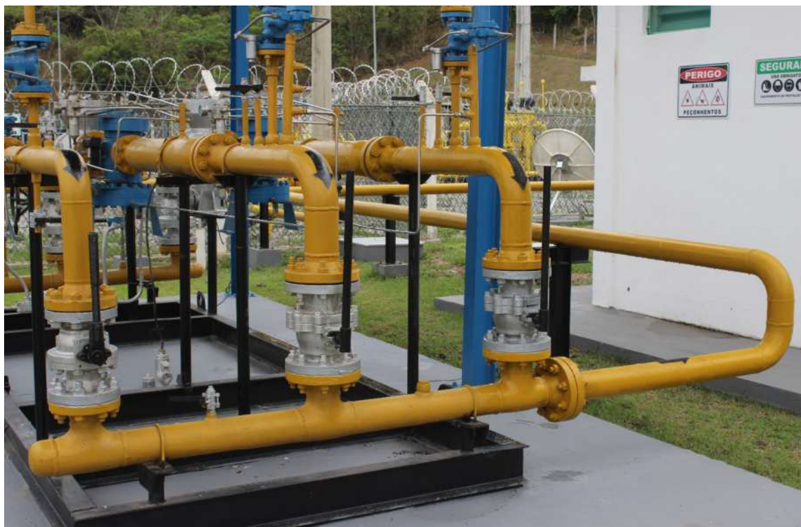
Foto 7: Tubulação de saída - 1º corte (25 bar)
