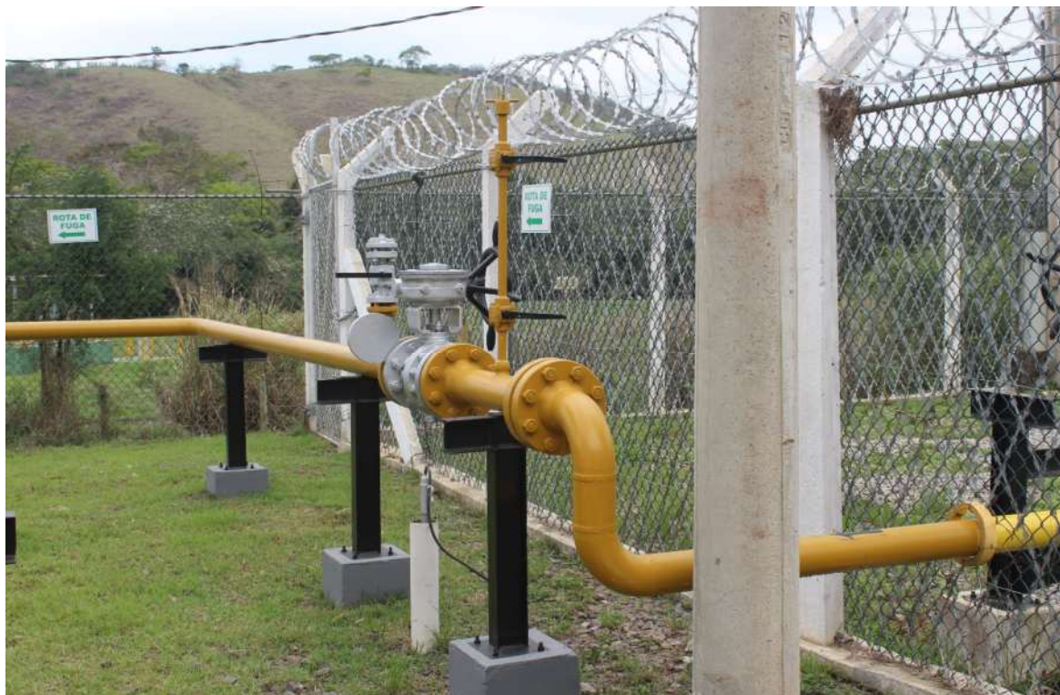
Foto 4: Tubulação de entrada de gás a partir da NTS (DN 4" - 52 bar)
