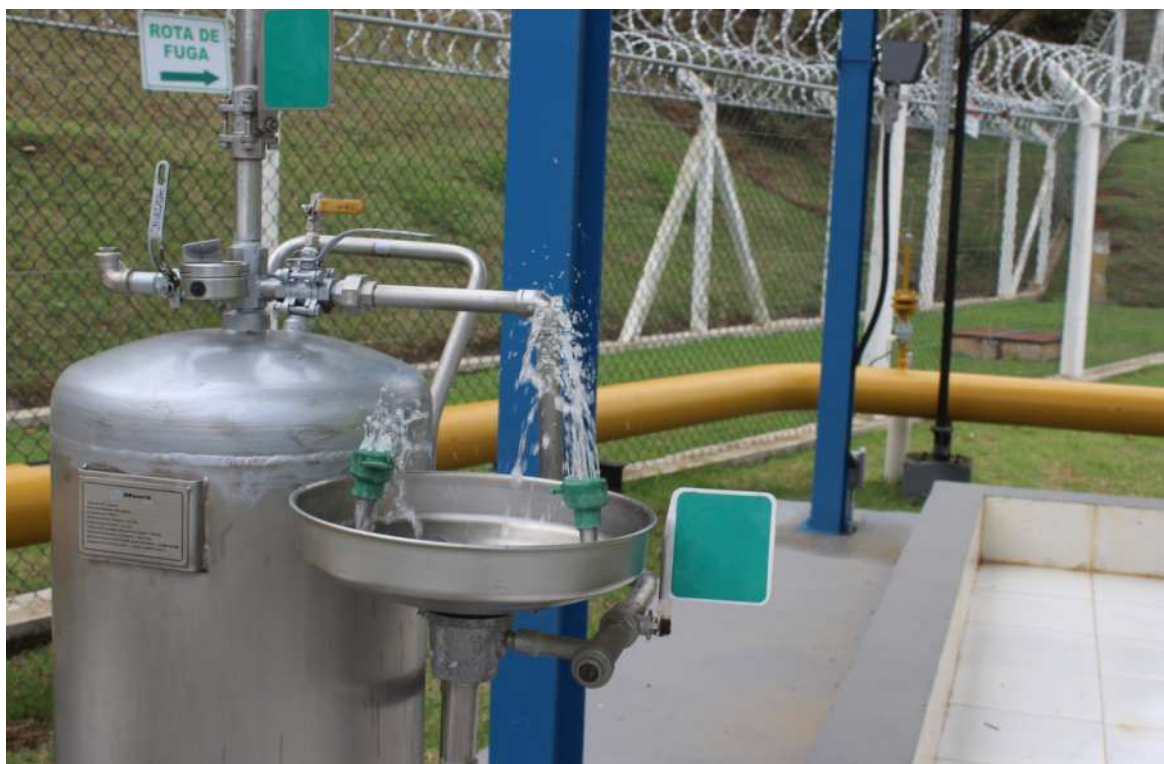
Foto 28: Lava-olhos de emergência
