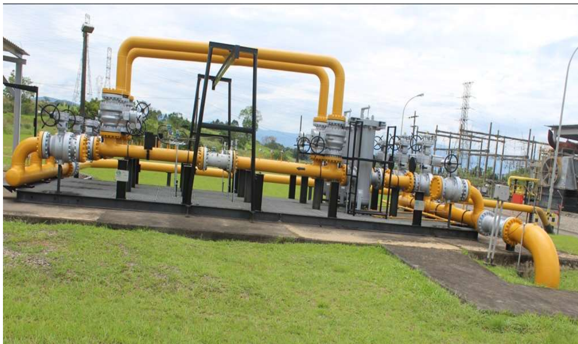
Foto 3: Estação de medição Eletrobolt.
