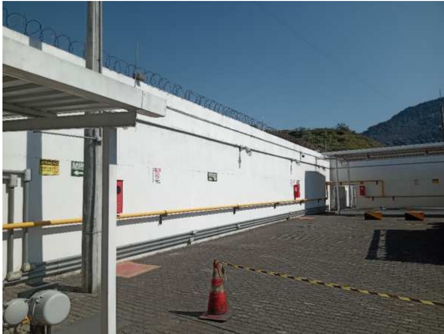
Foto 7: Tubulação de gás da RCU para a ERM.
