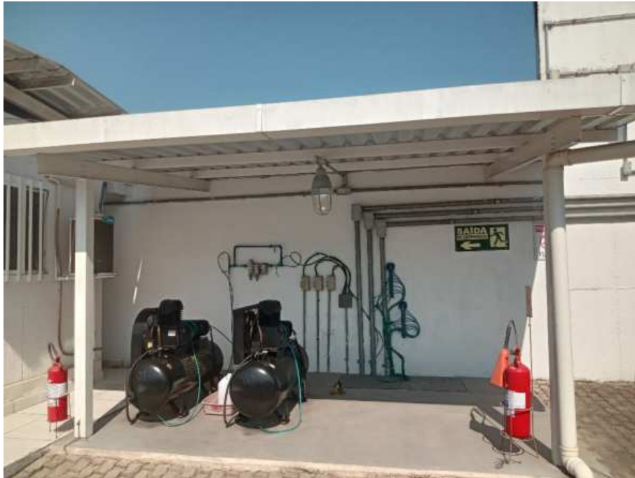
Foto 5: Sistema de ar comprimido para acionamento das válvulas (RCU).
