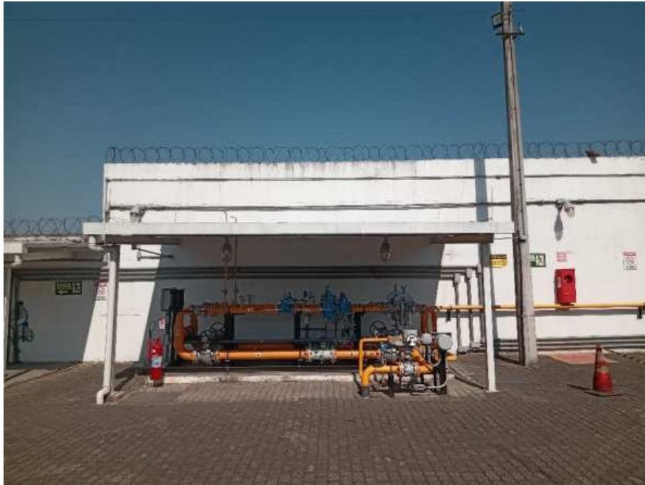
Foto 9: Vista frontal da Estação de Regulação e Medição.
