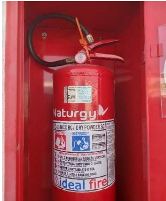
Foto 15: Extintor de incêndio com selo do INMETRO sem marcação da última inspeção.
