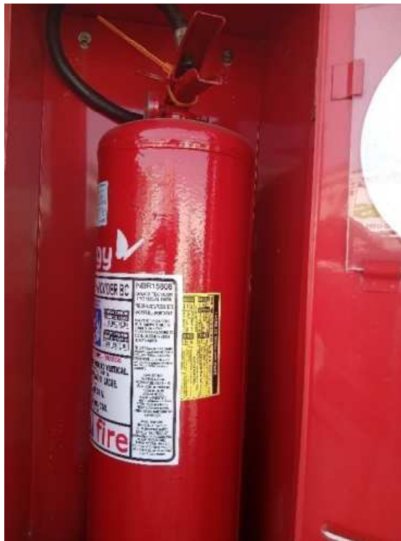
Foto 16: Extintor de incêndio sem etiqueta informando a inspeção de 3º nível.
