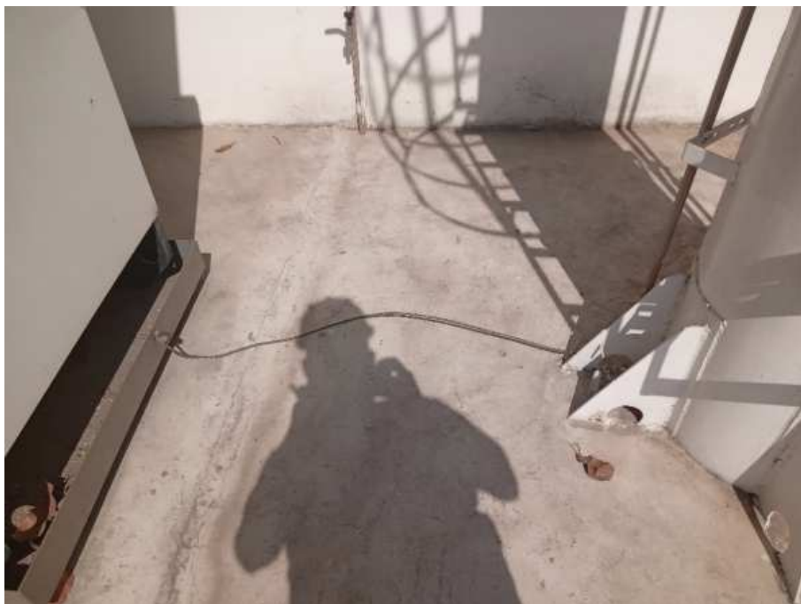
Foto 14: Cabo de aterramento mal conectado à base do gerador.
