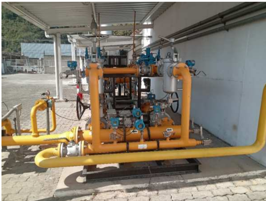
Foto 8: Estação de Regulação e Medição 6,25/1bar.
